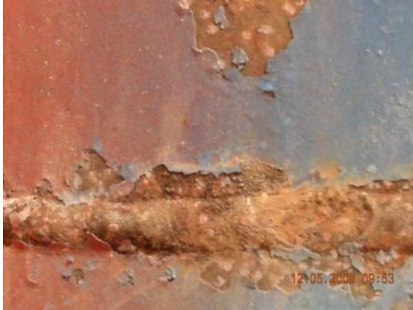
Figura Nro. 4.9 Alto índice de corrosión en empalme de alma C1 eje B
