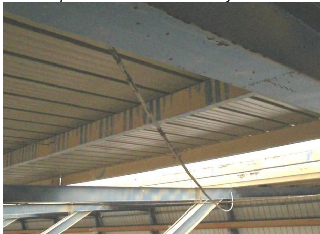
Figura Nro. 4.3 Templadores de techos sueltos y corroídos.
