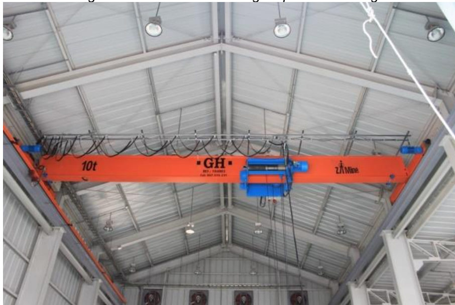
Figura Nro. 2.9- Vista de una grúa puente Monoviga
