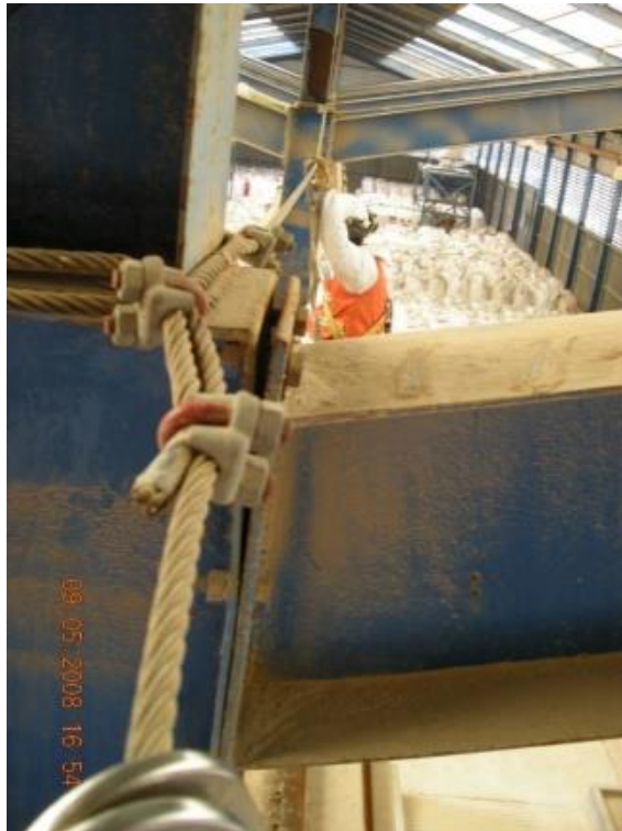
Figura Nro. 4.10 Abertura de bridas en arriotramiento en columna C2 Eje B
