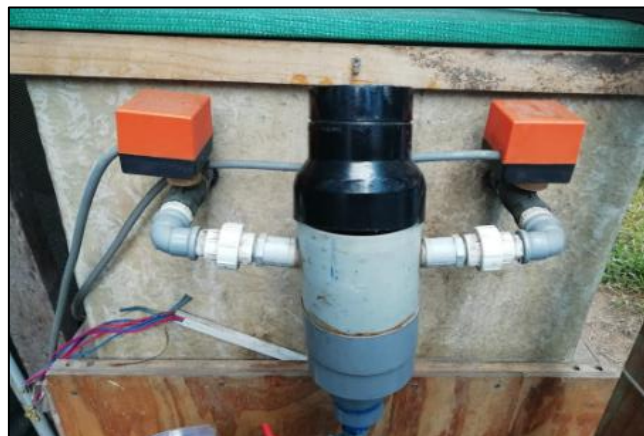
FIGURA 2.14 VISTA DE LAS VALVULAS DE SALIDA DEL EFLUENTE TRATADO
