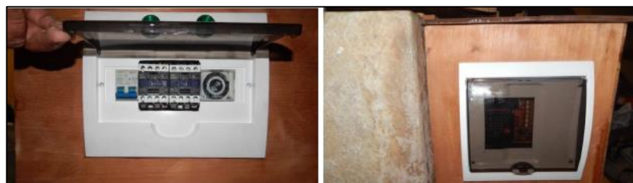
FIGURA 2.12 VISTA DEL TABLERO ELÉCTRICO Y DE LA CAJA DE DONDE SE UBICA LA TARJETA DE CONTROL
