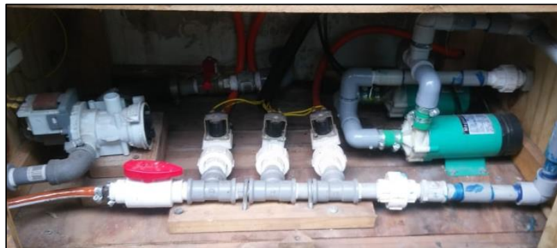
FIGURA 2.11 VISTA QUE MUESTRA LAS DOS ELECTROBOMBAS PARA AGUAS CRUDAS
