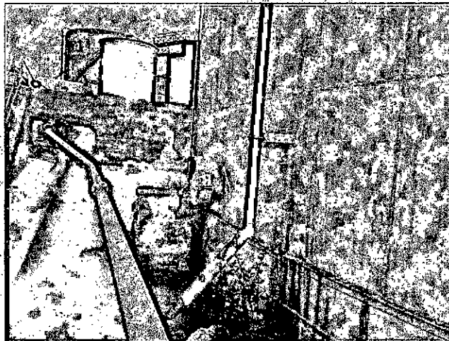
FOTO N° 4.6 TUBERÍA VERTICAL DE ENFRIAMIENTO – TANQUE 5
