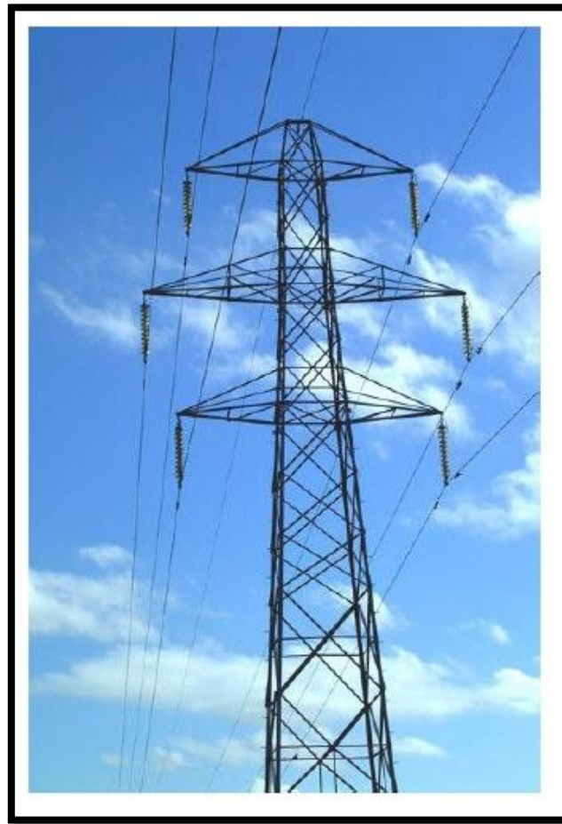
Figura N° 1 Torre de alta tensión
