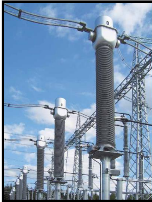
Figura N° 5 transformador de corriente de silicona statnett (Noruega)
