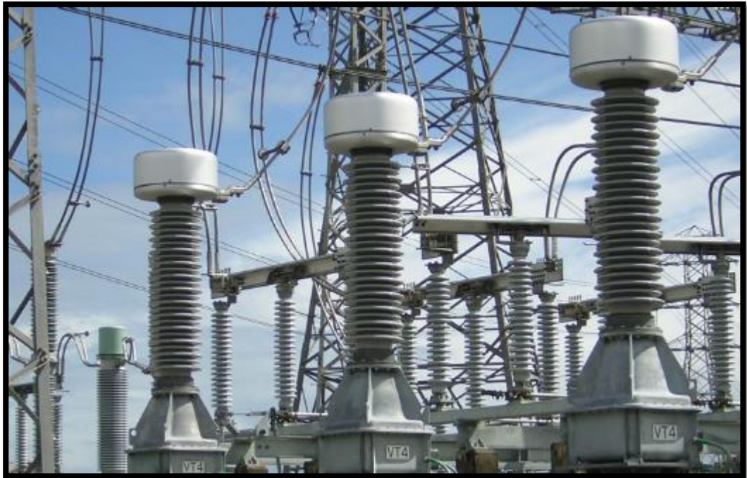
Figura N° 6 Transformador de tensión inductivo Transponer (Nueva Zelanda)
