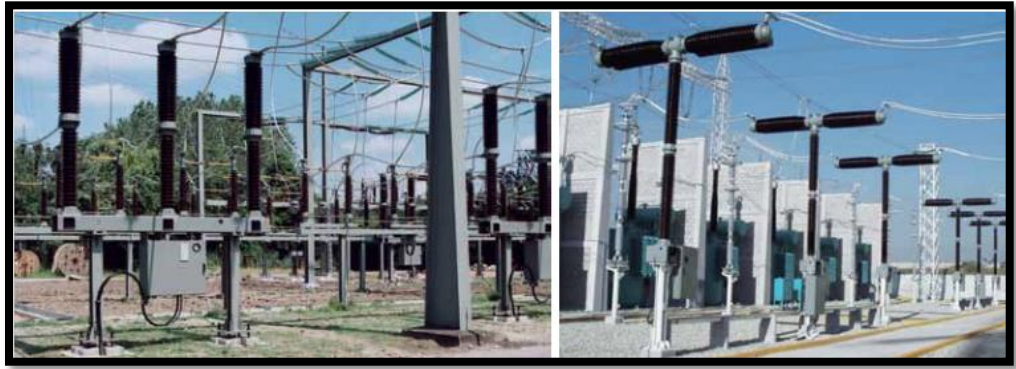
Figura N° 3 Interruptor de potencia
