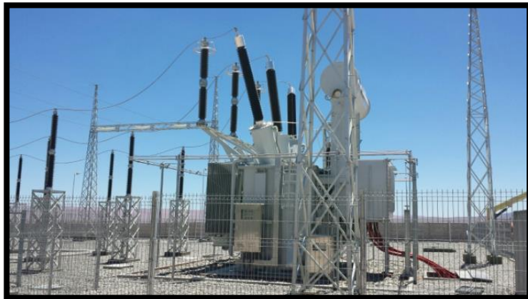
Figura N° 8 Subestación elevadora 22.9/138kV
