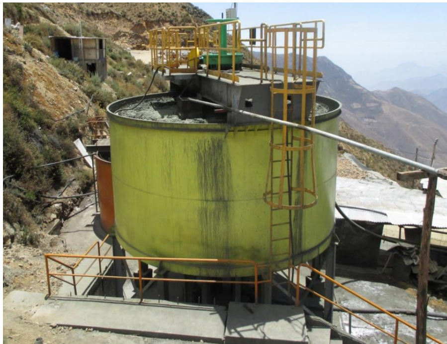
FIGURA N° 54: ESPESADOR DE CONCENTRADO DE COBRE EN FUNCIONAMIENTO
