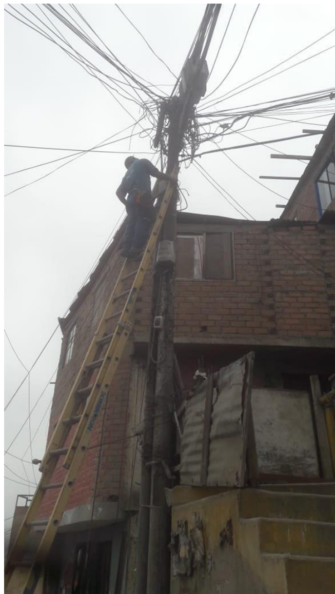
Figura 44 Cableado de Acometida
