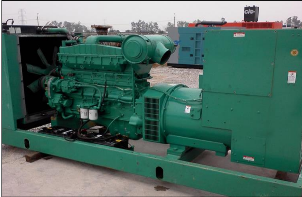
FIGURA 78. GRUPO ELECTRÓGENO ONAN MODELO DFCC - 350 KVA
