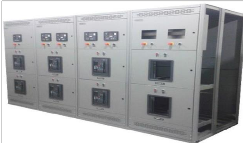
FIGURA 89. TABLERO DE SINCRONIZACIÓN Y TRANSFERENCIA AUTOMÁTICO
