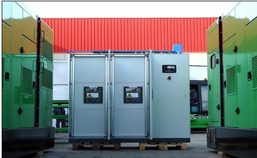
FIGURA 100. CUADRO DE CONMUTACIÓN 2500A - SINCRONIZACIÓN ENTRE DOS GENERADORES CON LA RED
