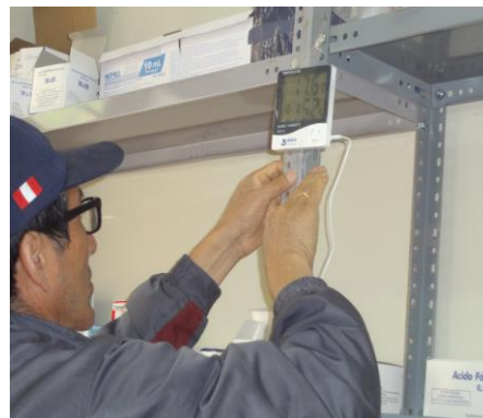
Soporte Técnico en Ambiente de Atención con Medicamentos Instalación de Termohigrometro
