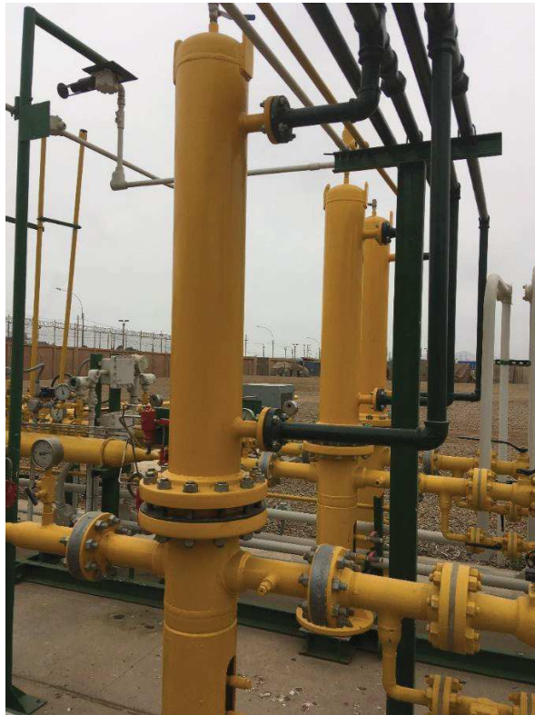
FIGURA 27: INTERCAMBIADORES DE CALOR DE UNA ERP DE GAS NATURAL
