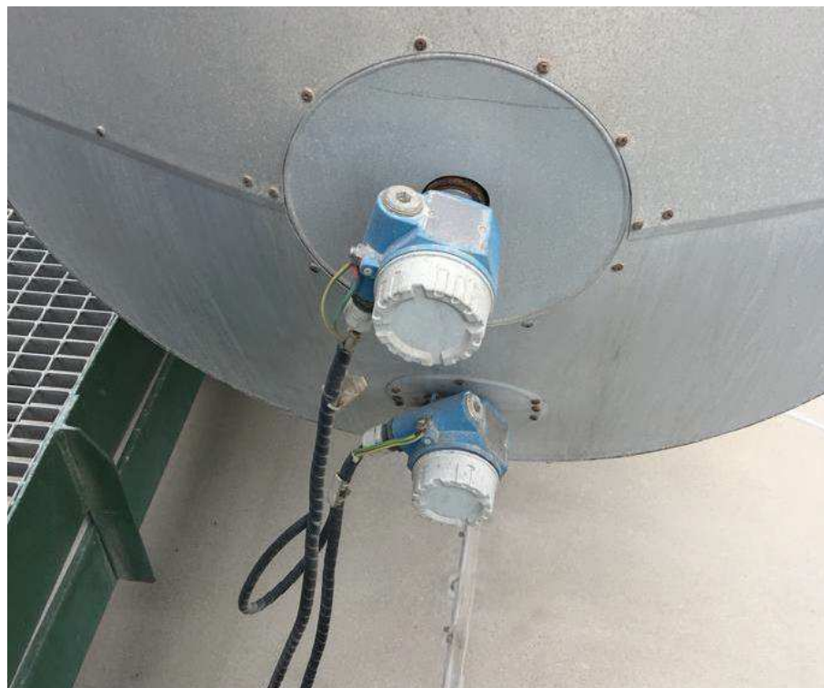
FIGURA 16: DETECTORES DE ALTO Y BAJO NIVEL DE AGUA INSTALADOS EN TANQUE DE EXPANSIÓN DE UN SISTEMA DE CALENTAMIENTO DEL CITY GATE LURÍN 2 – CÁLIDDA.
