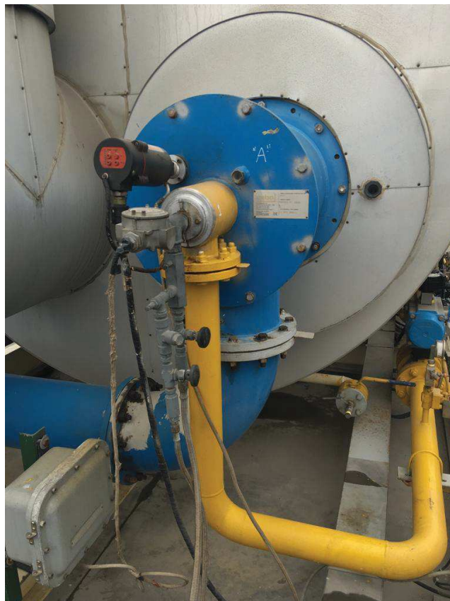
FIGURA 24: QUEMADOR INSTALADO EN CALENTADOR DEL CITY GATE LURIN 2 – CÁLIDDA, MARCA “CEBA”
