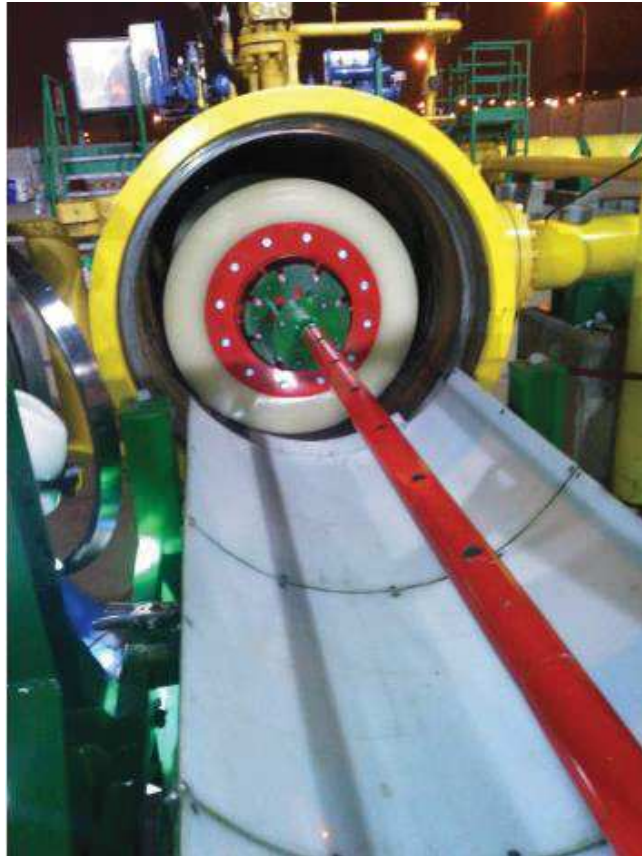
FIGURA 15: INSERCIÓN DE PIG DE LIMPIEZA AL BARRIL DE LA TRAMPA DE LANZAMIENTO
