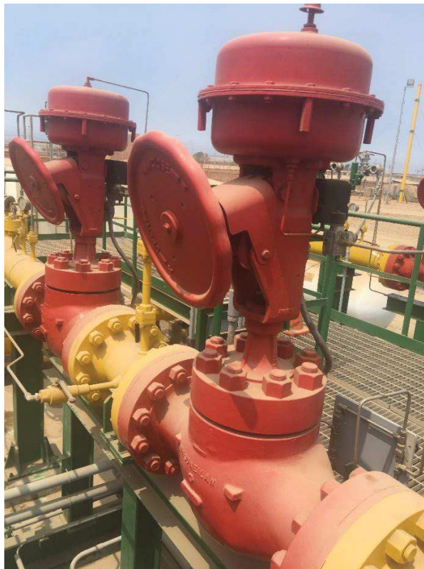
FIGURA 23: VÁLVULAS REGULADORAS DE PRESIÓN “MASONEILAN” (TRABAJADORA Y MONITORA) EN CITY GATE
