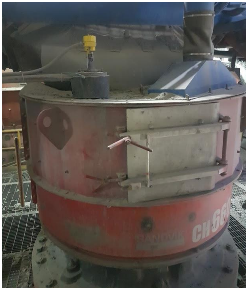
Figura 35. Instalación física del transmisor de nivel sobre la chancadora Fuente: Elaboración propia
