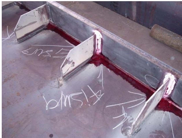
FIGURA N° 2.17 ENSAYO DE TINTES PENETRANTES
