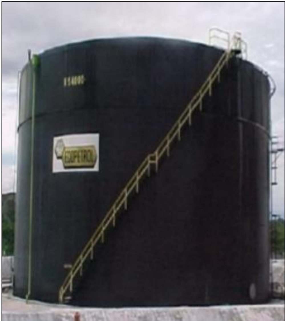
Figura N° 2.3 TANQUE DE LAVADO
