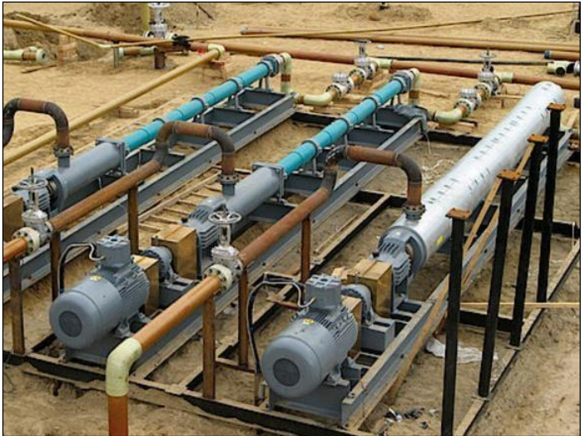
Figura N° 2.10 BOMBAS DE TRANSFERENCIA
