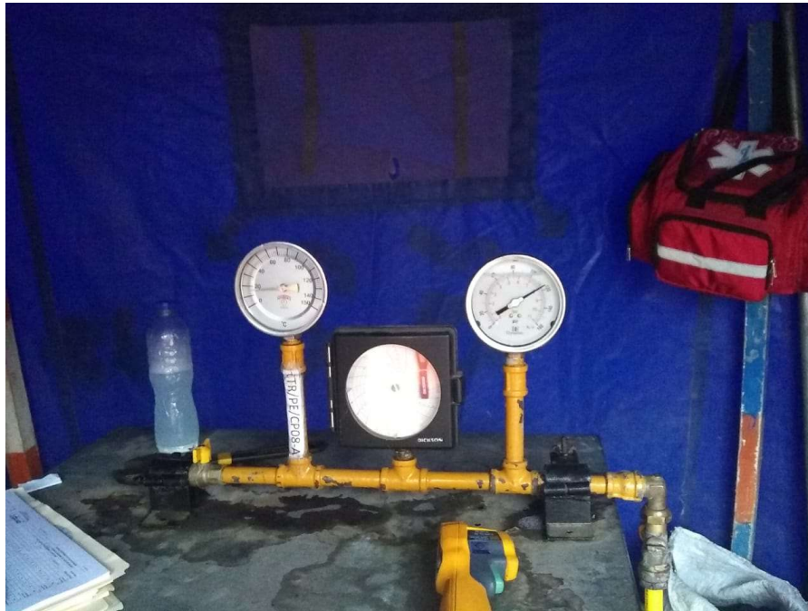
FIGURA N° 45 Cabezal de prueba, termómetro, manógrafo y manómetro
