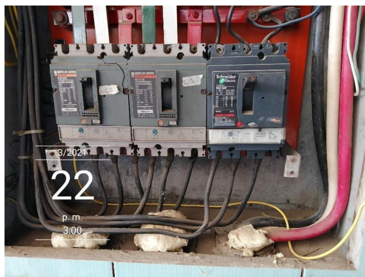
Figura N°15: Tablero eléctrico TD1 – Avícolas
