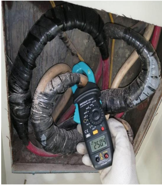
Ilustración 2. Tablero Eléctrico TD1 Avícola Conductor fase R Sobrecargado.
