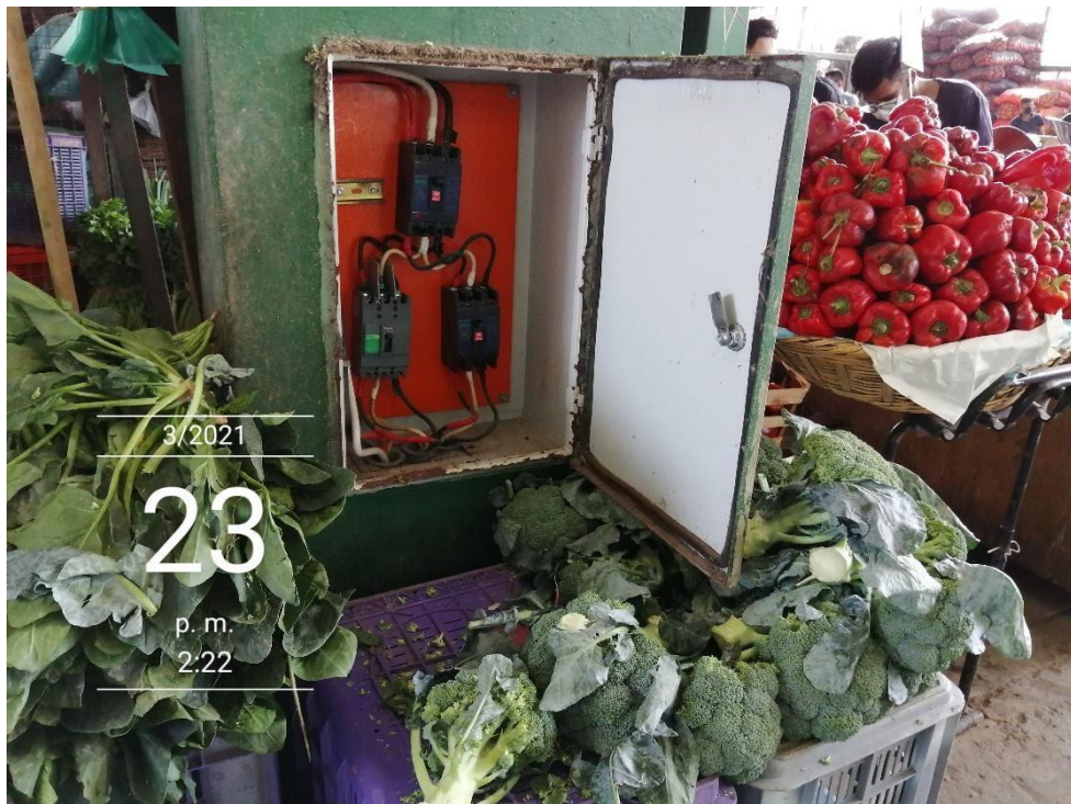
Ilustración 6. Tablero Eléctrico TD10 Mayoristas No se respeta la distancia de seguridad del tablero.
