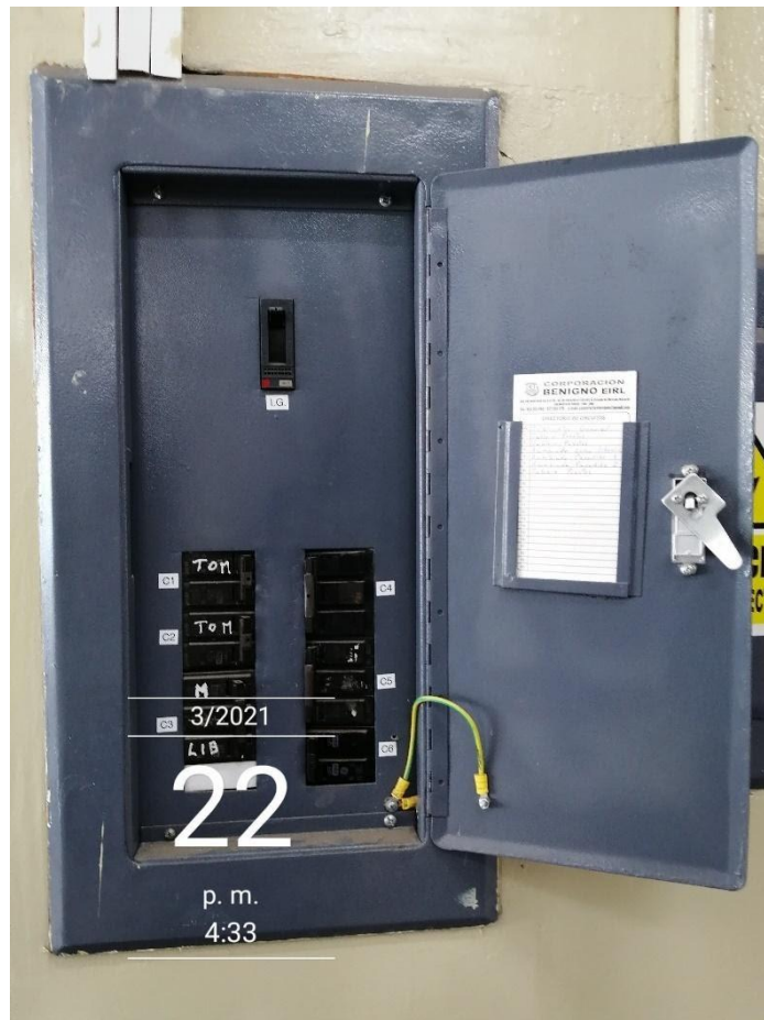
Figura N°29: Tablero eléctrico TD4 – Librerías
