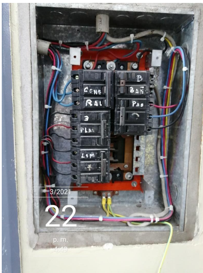
Figura N°32: Tablero eléctrico TD5 – Plásticos
