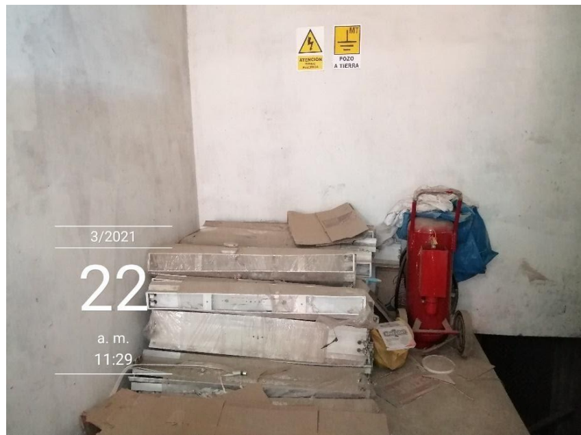
Figura N°02: Interior de la Subestación eléctrica.
