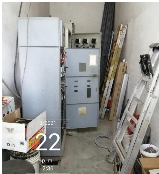
Figura N°09: Sub Tablero de distribución
