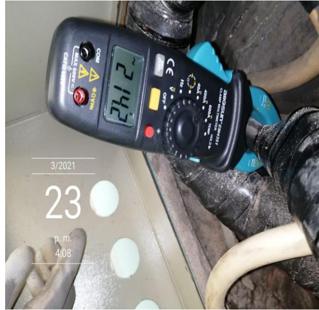
Ilustración 3. Tablero Eléctrico TD1 Avícola Conductor fase S Sobrecargado.
