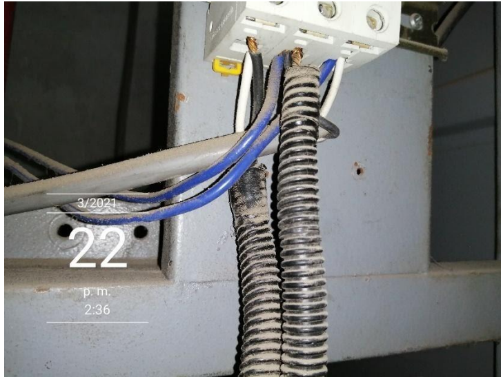
Figura N°10: Sub Tablero de distribución
