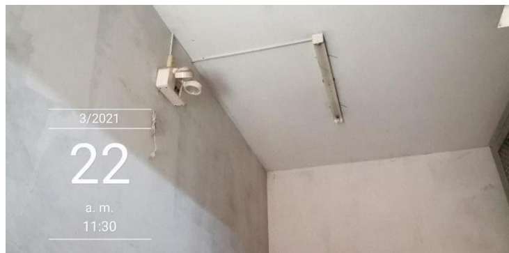
Figura N°04: Interior de la Subestación eléctrica
