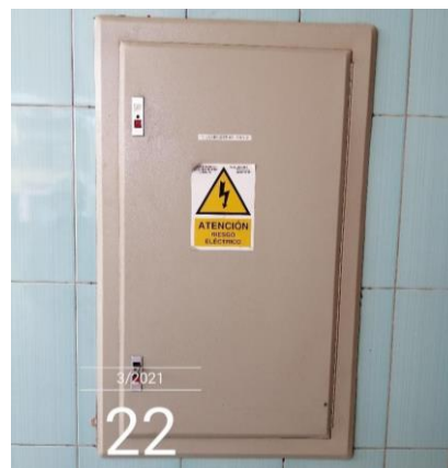
Figura N°19: Tablero eléctrico TD3 – Carnicerías
