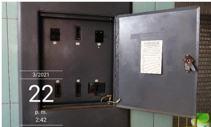
Figura N°13: Tablero eléctrico TD1 – Avícolas
