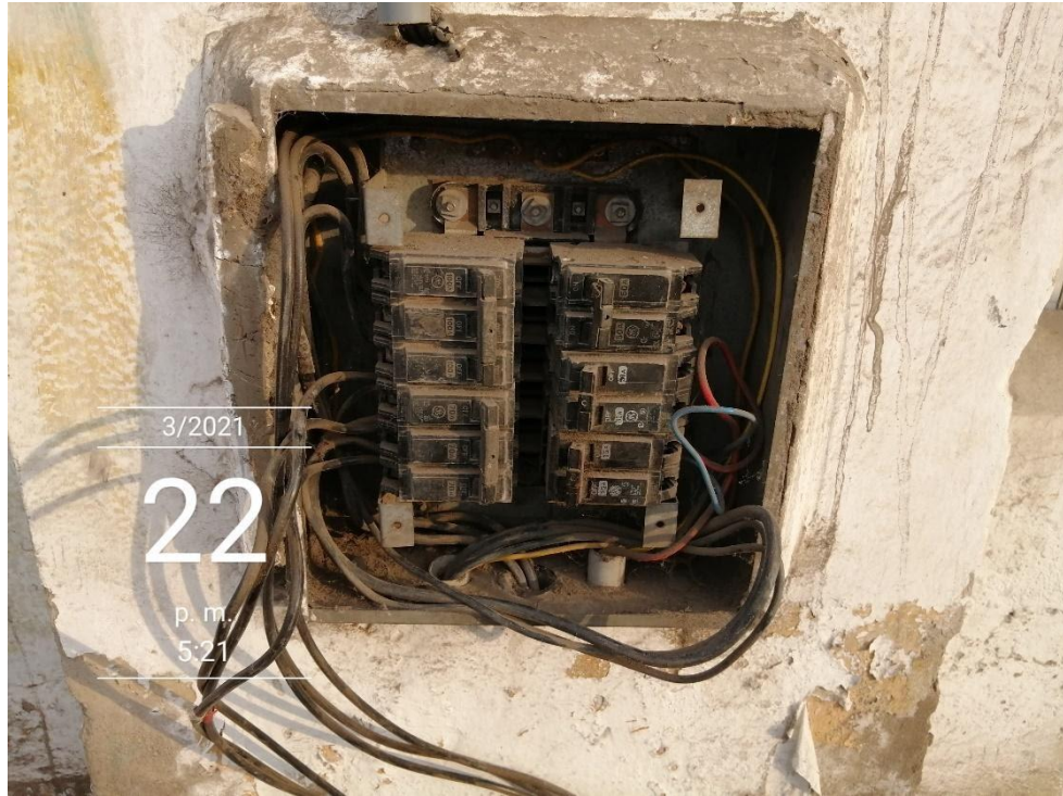
Ilustración 7. Tablero Eléctrico Oficinas Falta de mantenimiento, cables expuestos y falta de mandil protector.
