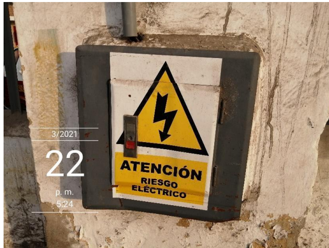
Figura N°33: Tablero eléctrico TD – Oficinas
