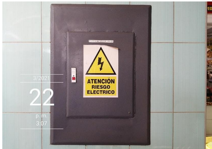
Figura N°16: Tablero eléctrico TD2 – Zona de húmedos
