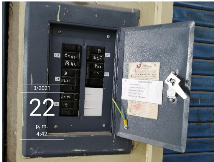
Figura N°31: Tablero eléctrico TD5 – Plásticos
