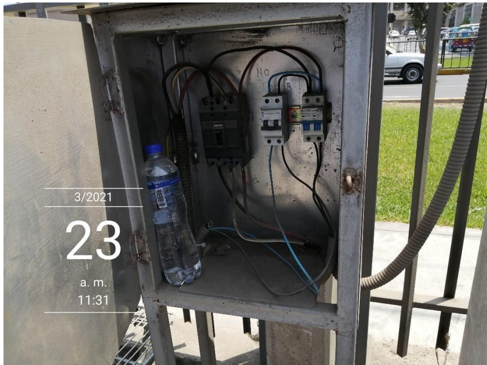
Ilustración 8. Tablero Eléctrico TD P7 Cables desordenados, falta de interruptor diferencial y objetos extraños dentro del tablero.
