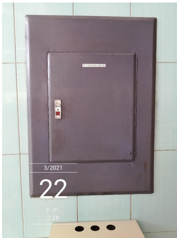
Figura N°12: Tablero eléctrico TD1 - Avícolas
