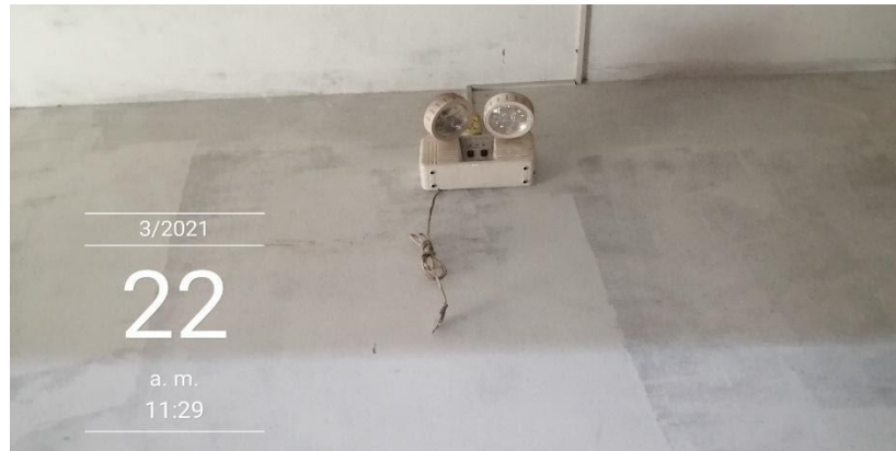
Figura N°03: Interior de la Subestación eléctrica.
