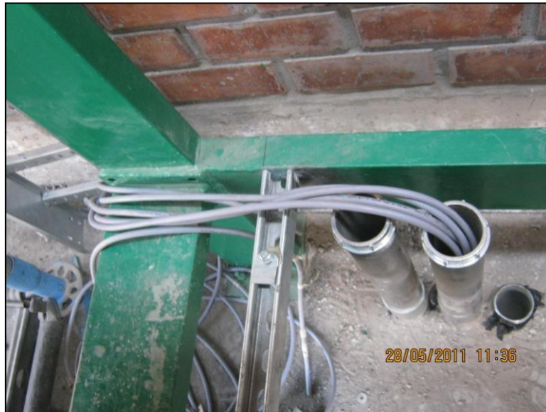
Fig. 6.1: Cableado de instrumentación
