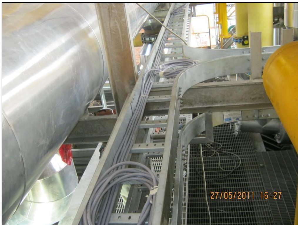
Fig. 4.3: Cableado techo del horno
