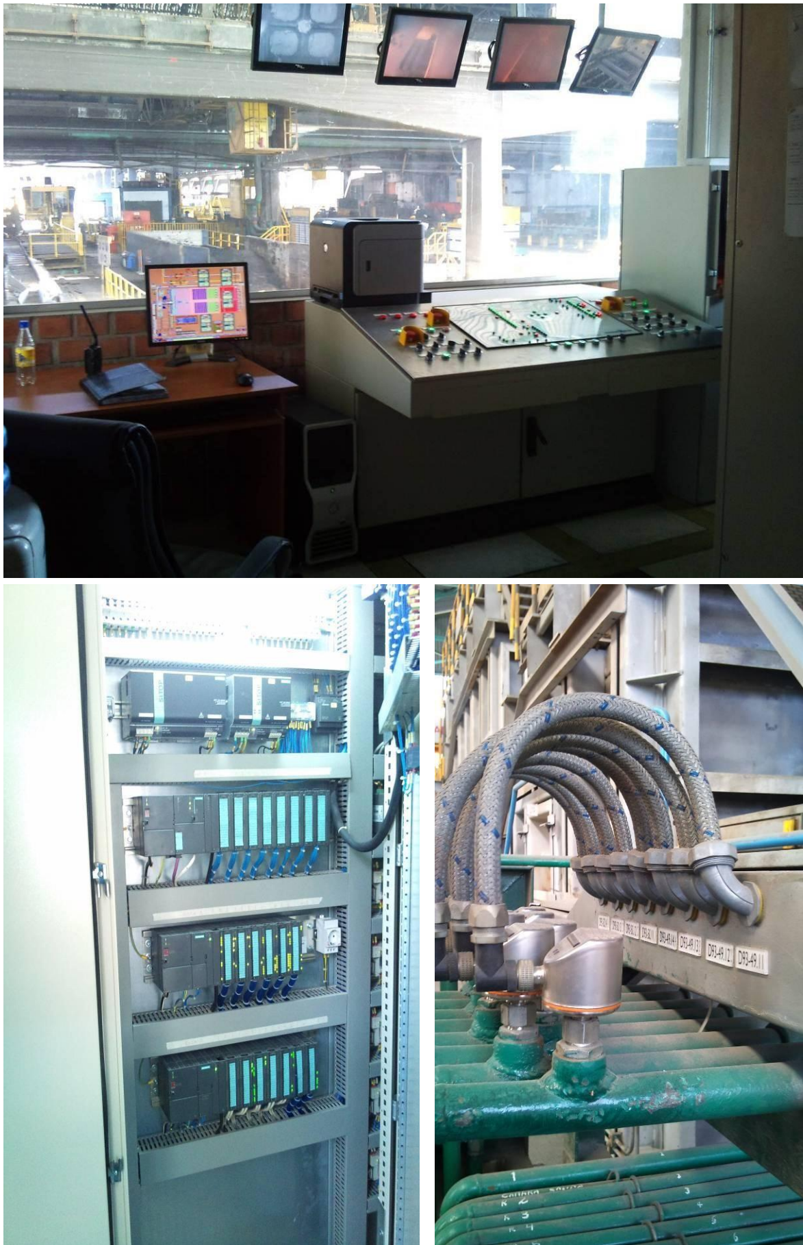
FIGURA 5: SALA DE CONTROL- EQUIPOS ELECTRONICOS
