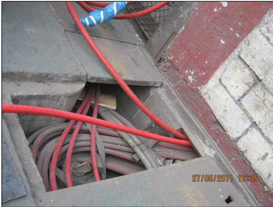
Fig. 5.1: Cableado Sub Estación 9.1
