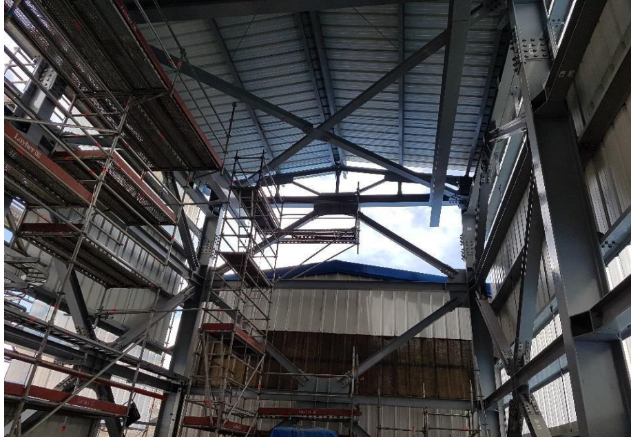
Figura N°3.26 FALTA DE INGENIERÍA, EDIFICIO NUEVO Y ANTIGUO
