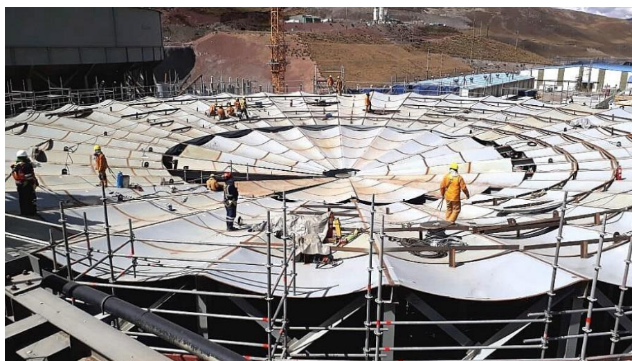
Figura N°3.25 CONTROL DE PLANCHAS DE FONDO DE ESPESADORES PRE-ENSAMBLADAS EN LIMA Y DEVUELTAS AL PROYECTO
