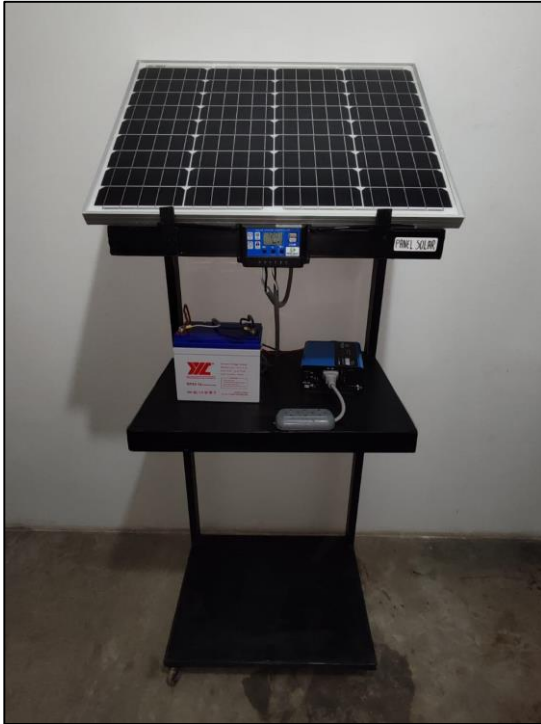
i. Sistema fotovoltaico (panel solar de 50 W, controlador de 10 A, Batería de 50 A y un inversor de 600 W).
