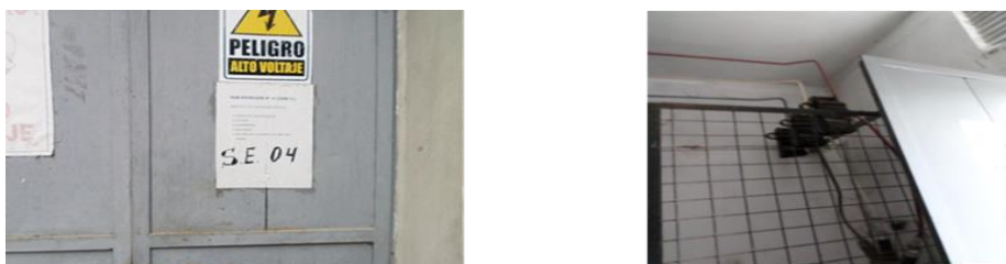
Imagen 9 - Subestación Eléctrica N° 04.
