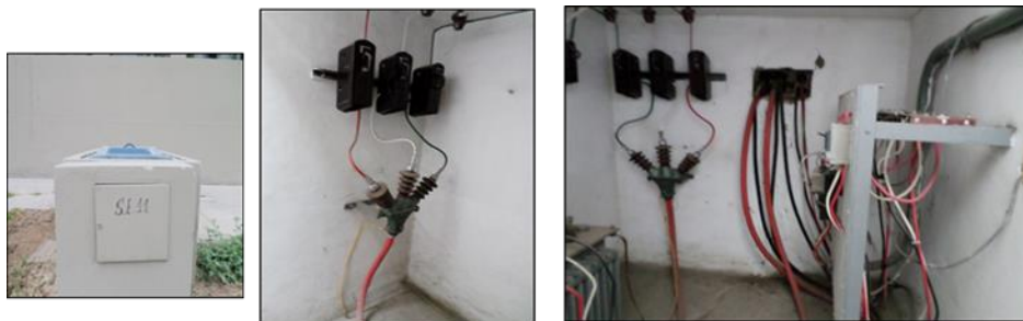
Imagen 15 - Subestación Eléctrica N° 13.
