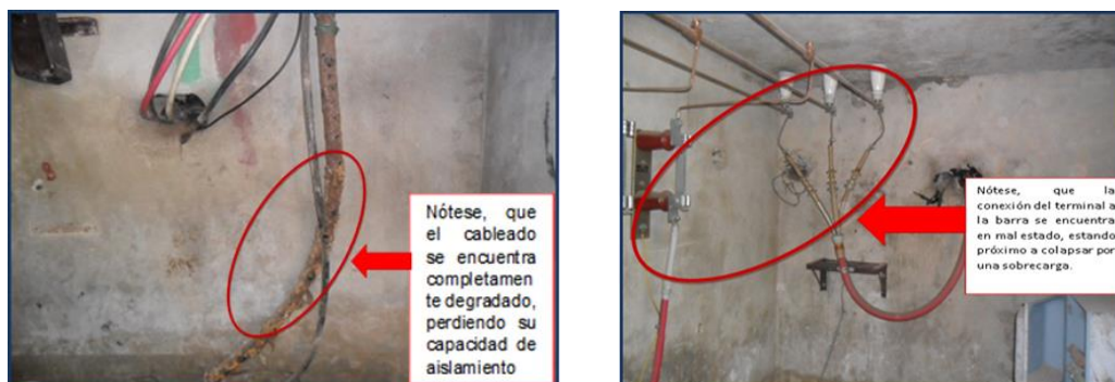
Imagen 6 - Cable NKY y terminal en mal estado.
