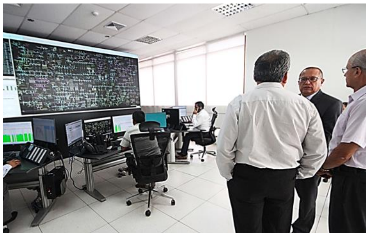
Figura 14 - Centro de control y operación del sistema eléctrico.
