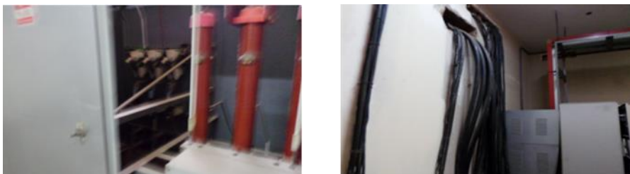
Imagen 23 - Subestación Eléctrica N° 21.
