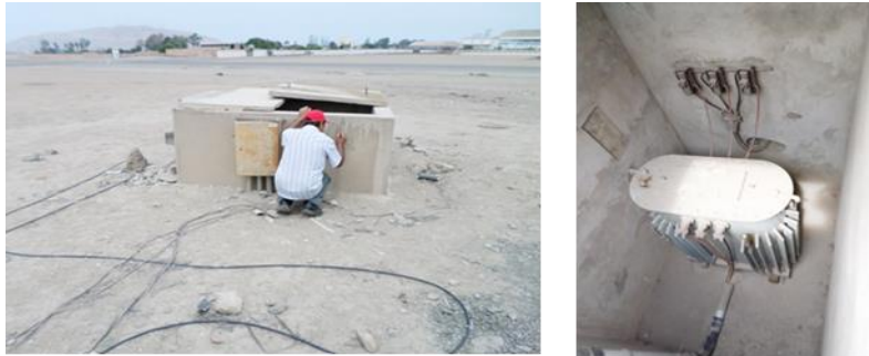
Imagen 13 - Subestación Eléctrica N° 11.
