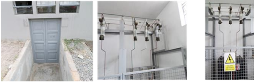
Imagen 21 - Subestación Eléctrica N° 19.
