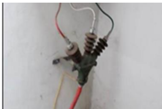
Imagen 5 - Caja terminal uso interior instaladas en las subestaciones.
