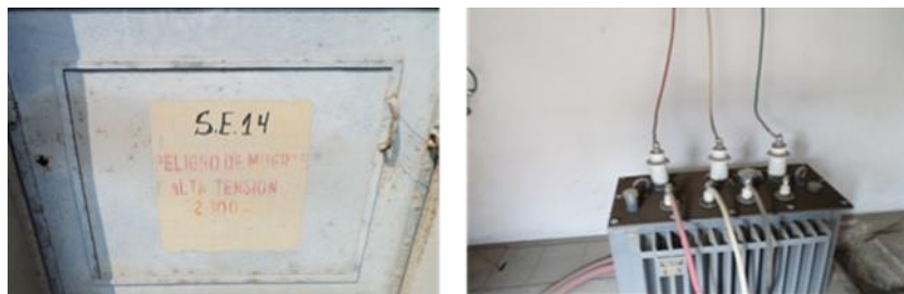
Imagen 16 - Subestación Eléctrica N° 14.
