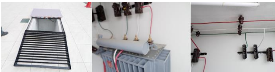
Imagen 14 - Subestación Eléctrica N° 12.
