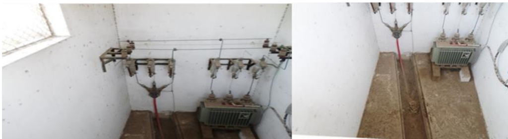
Imagen 19 - Subestación Eléctrica N° 17.
