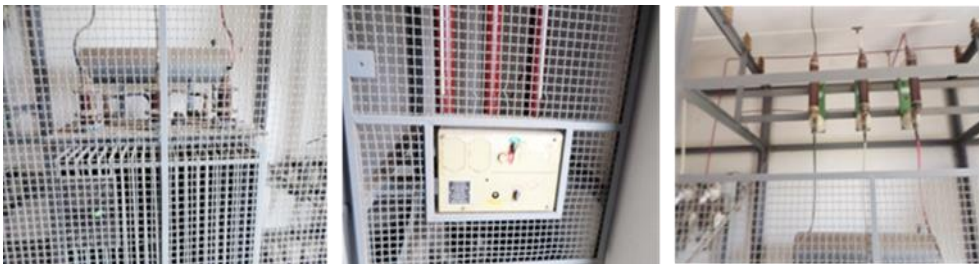
Imagen 18 - Subestación Eléctrica N° 16.
