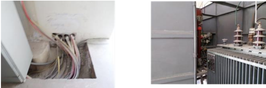
Imagen 17 - Subestación Eléctrica N° 15.
