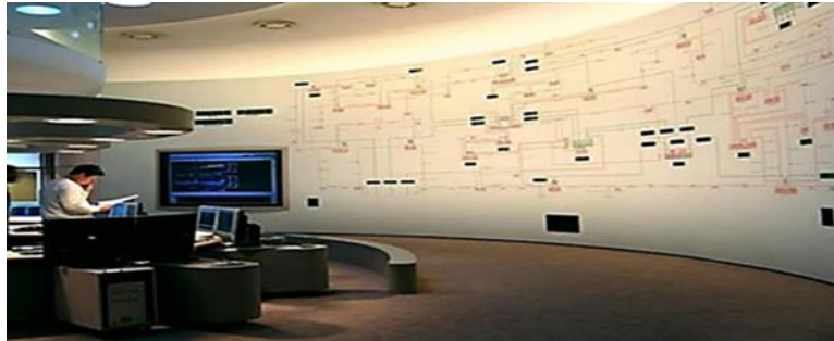
Figura 20 - Centro de control.
