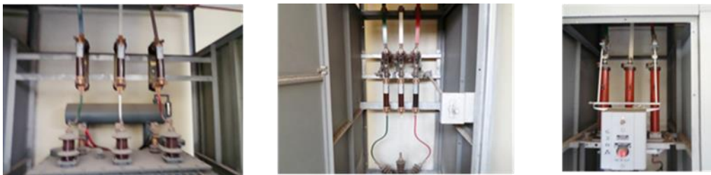
Imagen 22 - Subestación Eléctrica N° 20.
