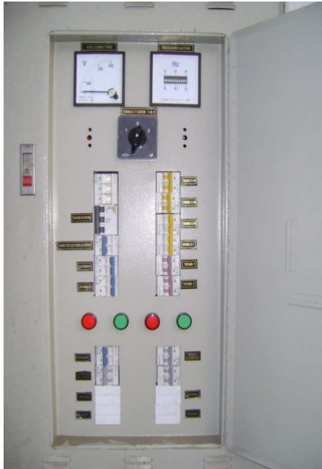
FIGURA N° 3.7 TABLERO DE COMBUSTIBLE LÍQUIDO (TDB)
