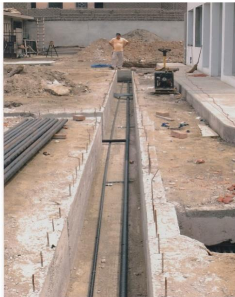
FIGURA N° 4.29 CANALETA DE CONCRETO TUBERIAS GLP
