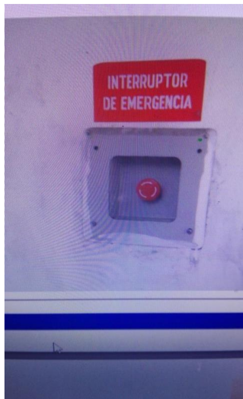
FIGURA N° 4.36 PULSADOR DE EMERGENCIA
