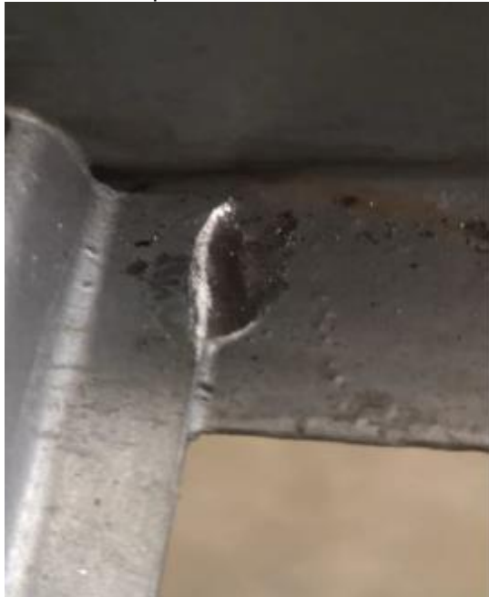
Imagen 28 Zona de empalme libre de cordón de soldadura
