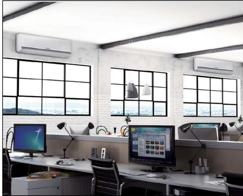
Figura 98. Equipos de aire acondicionado tipo VRF, tomado de “Tarifa y guía técnica”, SAMSUNG, 2021, p. 76-77.
