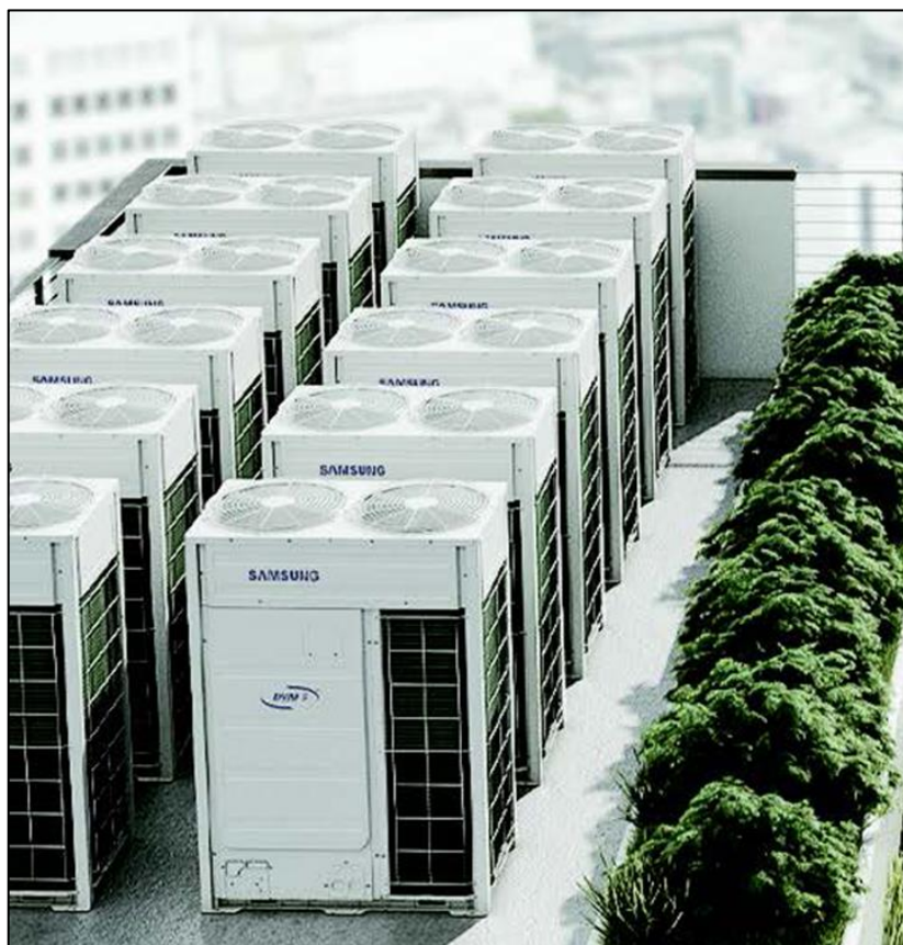
Figura 12. Arreglo de condensadores del sistema de aire acondicionado VRF DVMS, tomado de la página web de la marca SAMSUNG.
