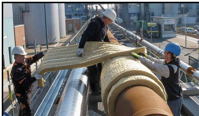
Figura 2.20 Aislamiento térmico en tuberías calientes
