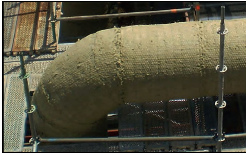
Figura 3.11 Aislamiento térmico en codos con manta de lana mineral
