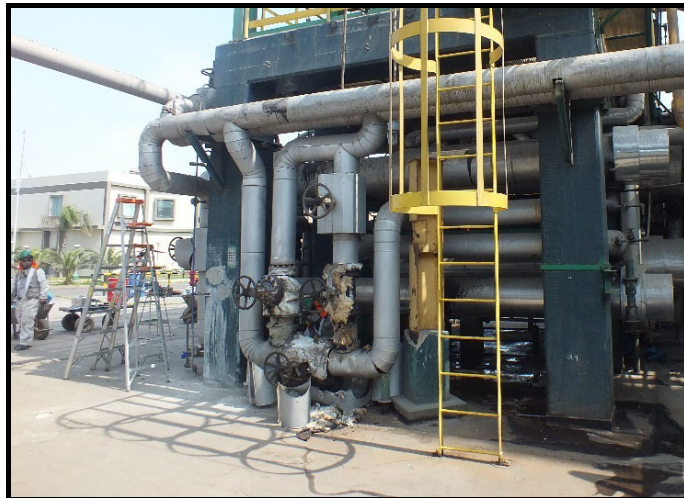
Figura 1.6 Aislamiento térmico en mal estado
