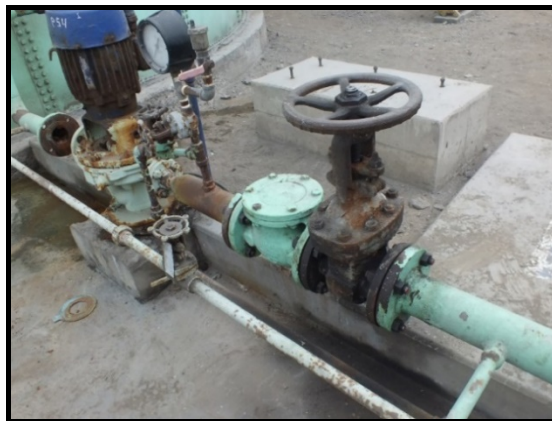
Figura 1.2 Válvula compuerta inoperativa
