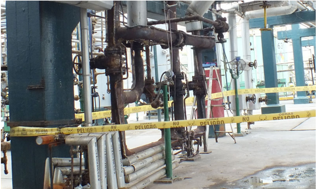
Rack de tuberías: Antes de instalar aislamiento a las líneas de proceso
