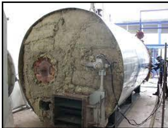
Figura 2.22 Aislamiento térmico en calderas
