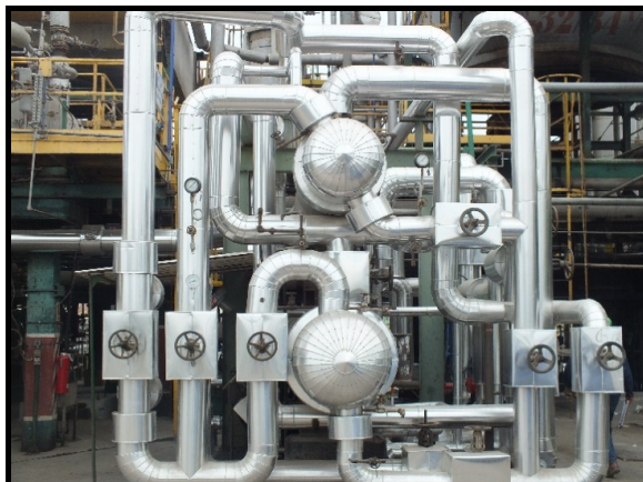
Figura 2.28 Cubierta metálica de aluminio en líneas y equipos.
