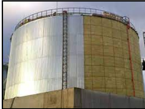
Figura 2.21 Aislamiento de tanques de almacenamiento
