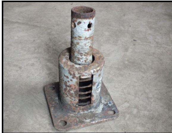
Figura 1.4 Spring Hangers desmontada
