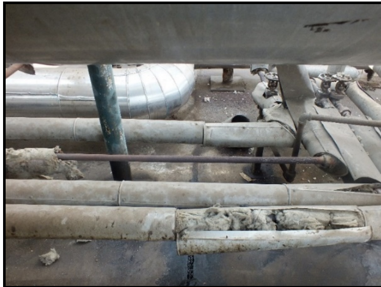
Figura 3.5 Aislamiento térmico deteriorado
