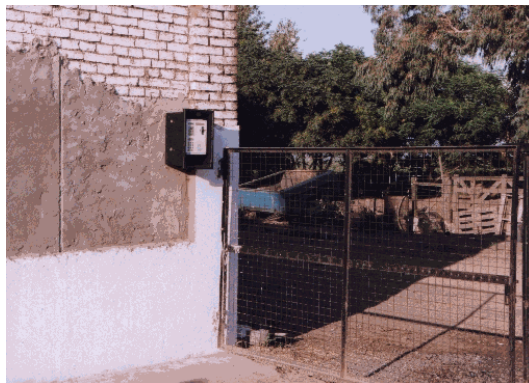
Medidor "mono-cuerpo" instalado en un gabinete exterior.
