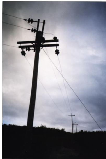
Línea Primaria 22.9 kV
