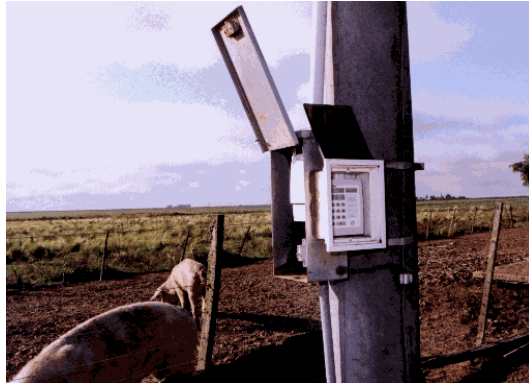
Medidor "bi-cuerpo" instalado en un gabinete precintable a la intemperie.
