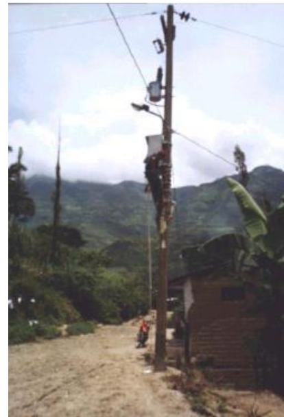
Línea Primaria 13.2 kV
