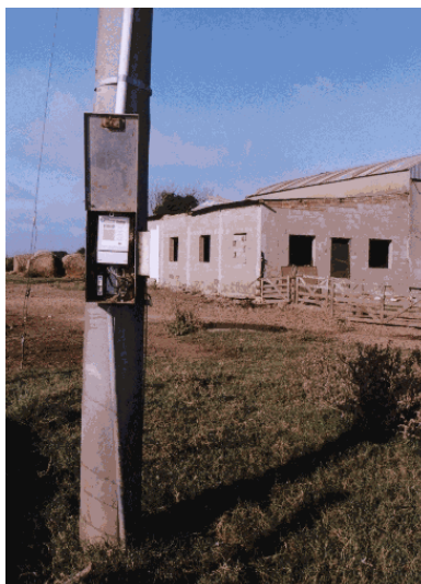
Medidor "bi-cuerpo" con el control del usuario instalado en un gabinete separado.
