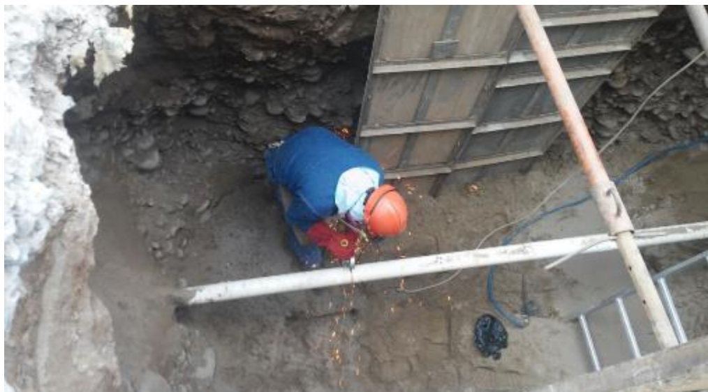
Figura 3. 128 CORTE DE TUBERÍA OBTURADA
