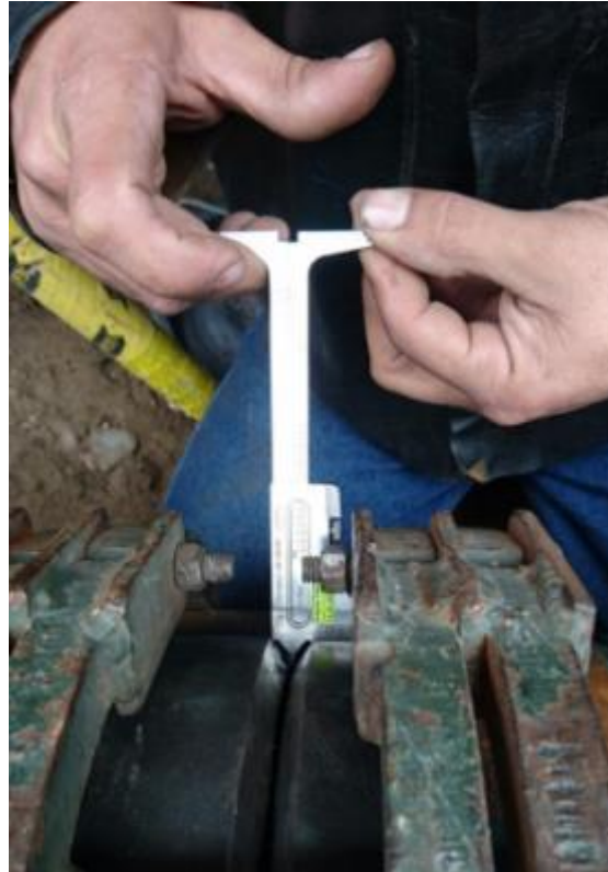
Figura 3. 63 VERIFICACIÓN DE DESALINEAMIENTO.
