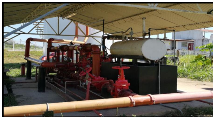
Figura 3.15: Patio de bomba del Sistema Contra Incendio
