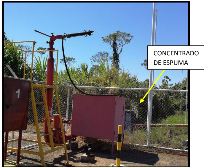
Figura 3.19: Monitor Hidrante y Totem de concentrado de espuma
