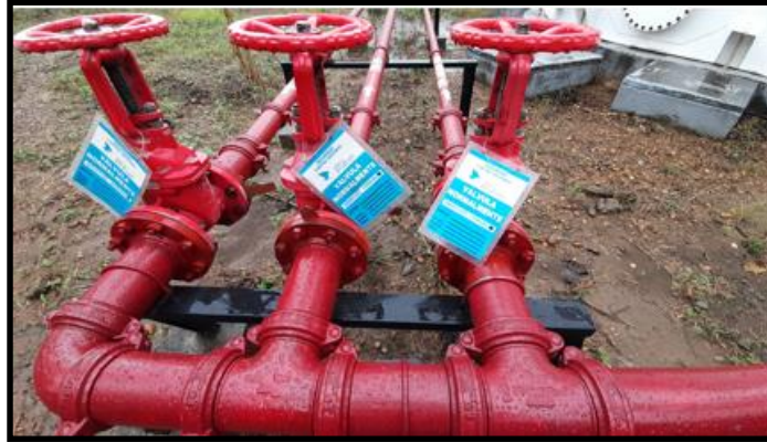
Figura 3.18: Manifold de los Sistemas de Diluvio
