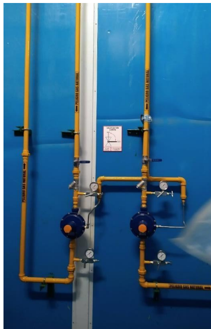
Figura 3.33: Instalación de ERS'S en hornos de pintura liquida Modabus - 1.
