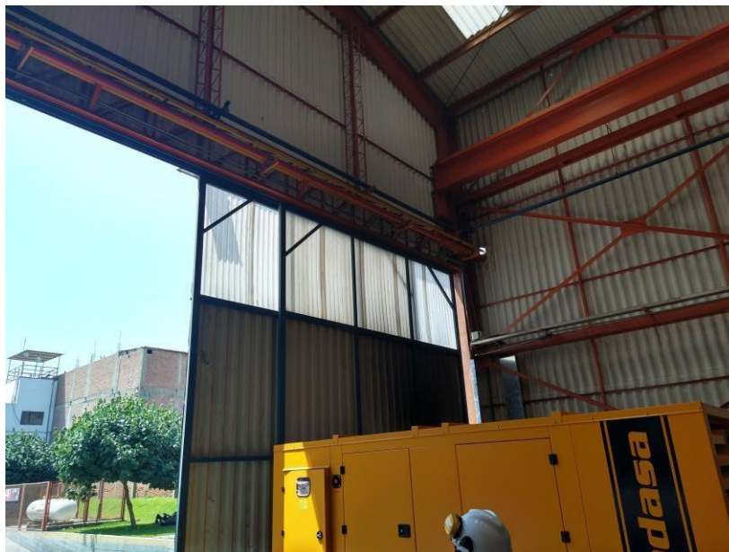
Figura 3.21: Red Interna de GN que sale de la nave Modapower.
