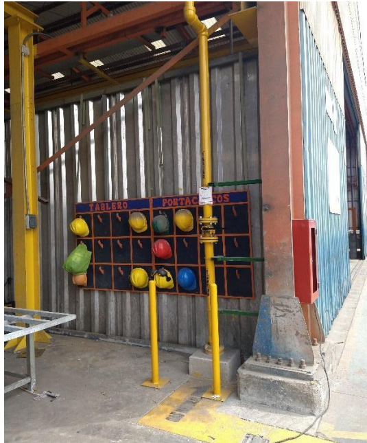
Figura 3.16: Red Interna de GN que ingresa a la nave de Modapower-1.
