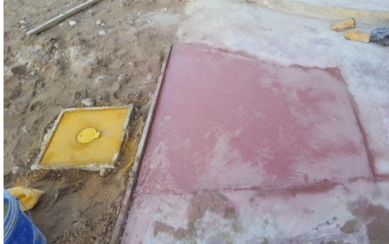
Figura 2.11: Válvula de servicio de red de distribución.
