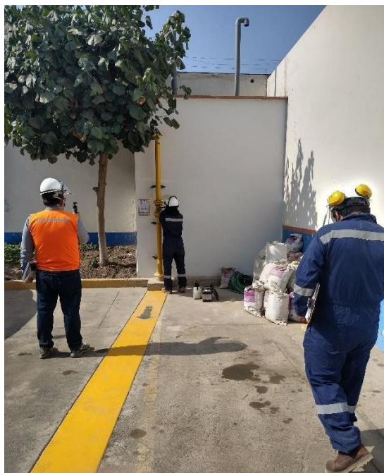
Figura 3.15: Tubería de GN enterrada señalizada.
