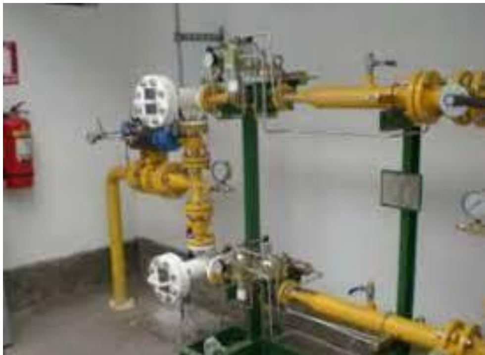
Figura 2.14: Estación de Filtración y medición.
