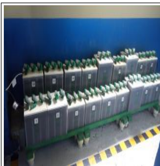
Fig. 148 Banco de Baterías
