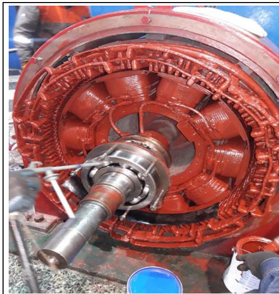
Fig. 121 Conjunto Rotor - Estator del Generador Eléctrico
