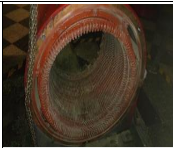
Fig. 64 Estator del Generador
