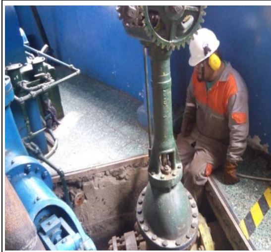
Fig. 67 Vista de Válvula Principal
