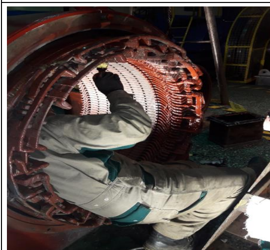
Fig. 117 Pulverizado de Estator del Generador Eléctrico
