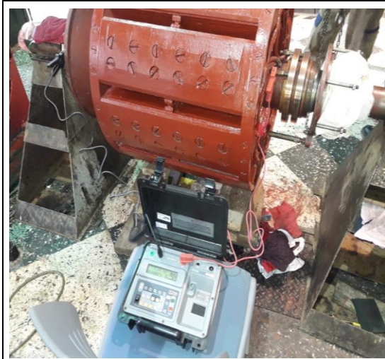
Fig. 119 Megado del Rotor del Generador Eléctrico
