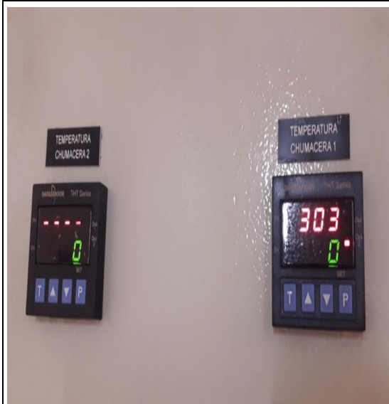
Fig. 144 Operatividad de Controladores de Temperatura (Aceite y Cojinete)
