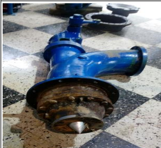
Fig. 73 Vista de Inyector Inferior
