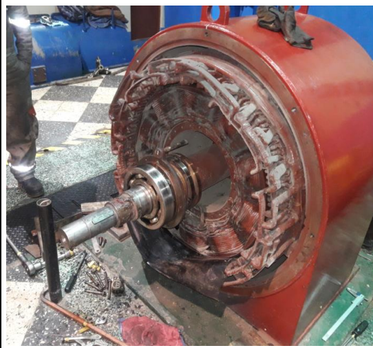
Fig. 61 Vista de Estado del Generador Rotor/Generador
