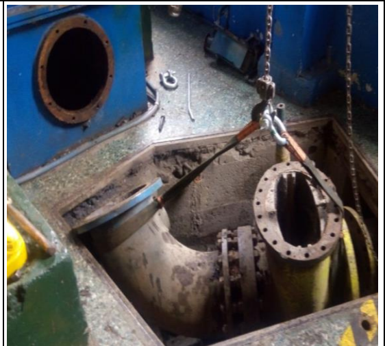
Fig. 72 Vista de Alojamiento de inyector inferior y válvula Principal
