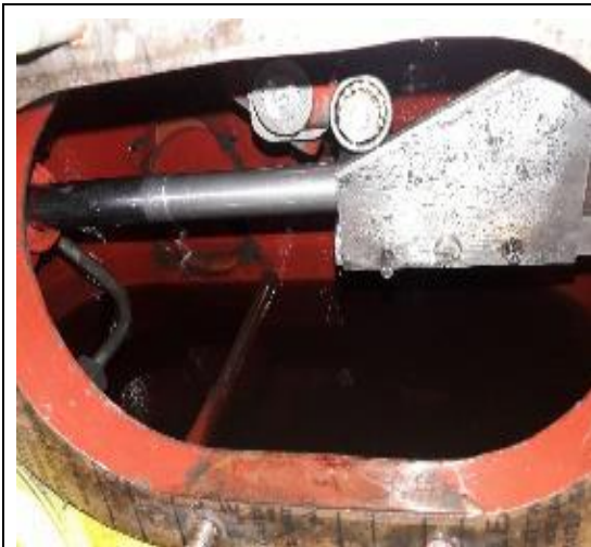
Fig. 86 Aceite DTE-26 contaminado en el cárter del RR.VV.
