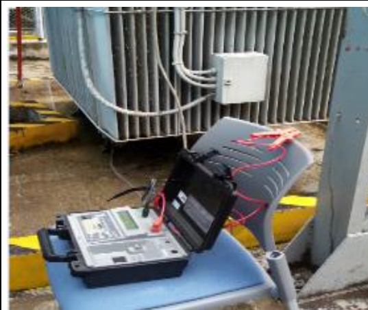
Fig. 106 Prueba de Medición de Resistencia de Aislamiento
