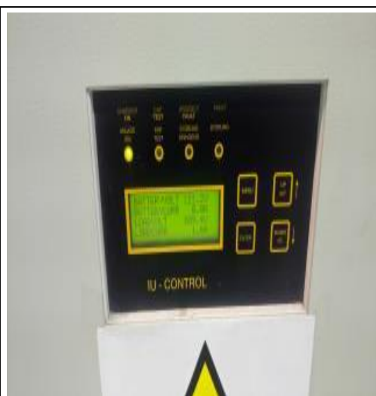
Fig. 149 Verificación de Tensión de Banco de Baterías
