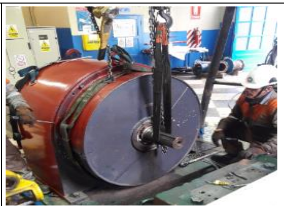
Fig. 56 Tapa protectora del Generador
