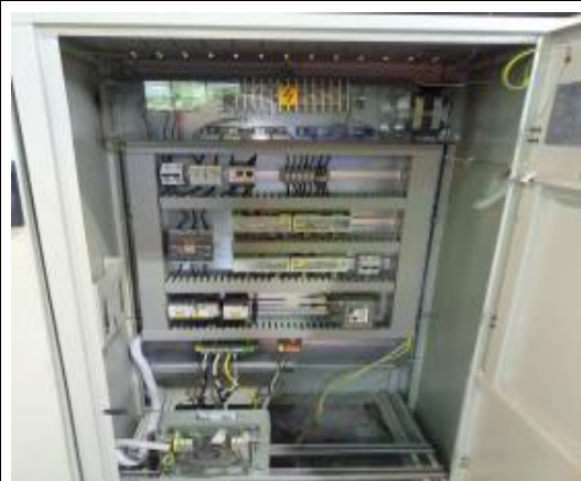
Fig. 103 Inspección de Componentes Eléctricos del cargador de batería 110 VDC.
