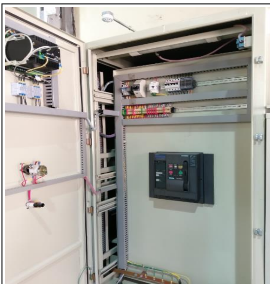
Fig. 146 Interruptor de Potencia
