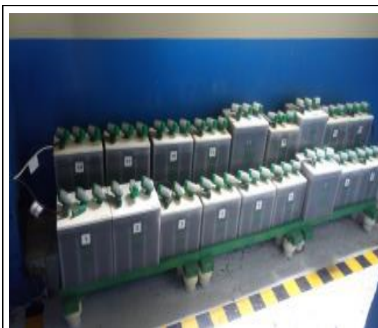
Fig. 100 Banco de batería de 18 unidades.
