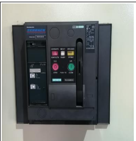
Fig. 147 Interruptor de Potencia
