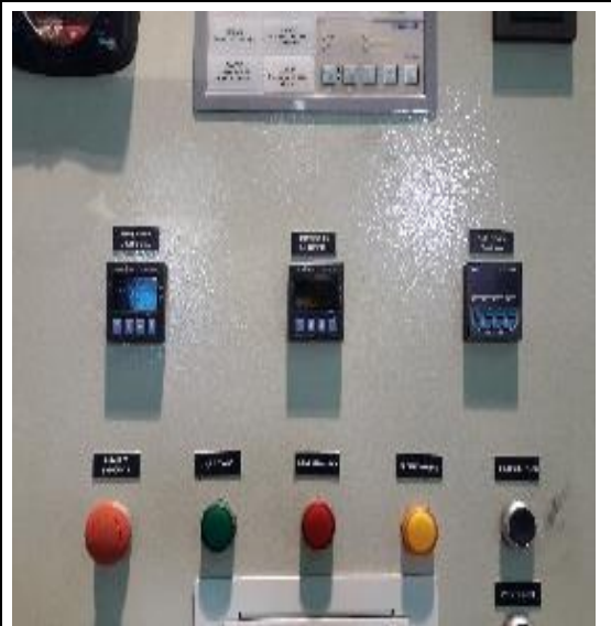
Fig. 145 Vista en talero de Controladores de Temperatura (Aceite y Cojinete)
