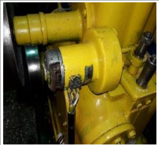
Fig. 85 Motor electrico de Regulador de Velocidad
