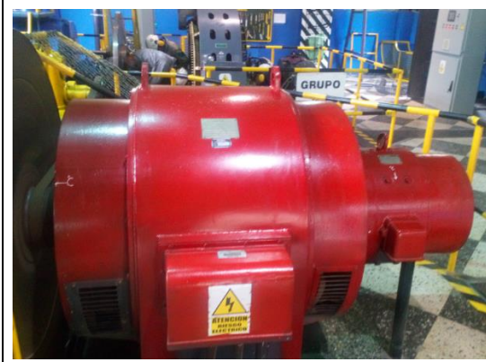
Fig. 48 Desconexión del sistema de excitación.
