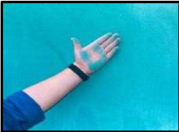
Figura N° 12 Presencia de formación de caleo en el recubrimiento
