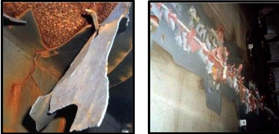
Figura N° 11 Presencia de recubrimiento descascarado
