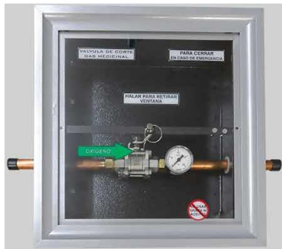
Figura N° 12. Caja de corte.
