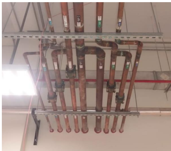
Figura N° 15. Soportes metálicos de gases medicinales.
