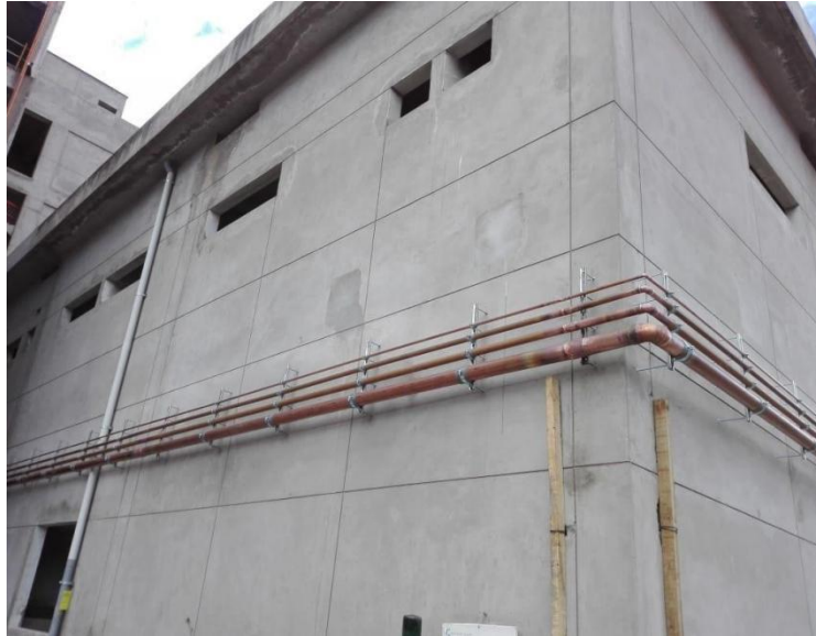
Figura N° 14. Tuberías de gases medicinales.
