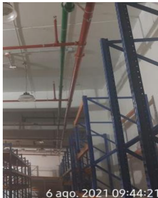
Figura 52 Rociador Up right (ESFR) K 25.2 – Almacén Deposito
