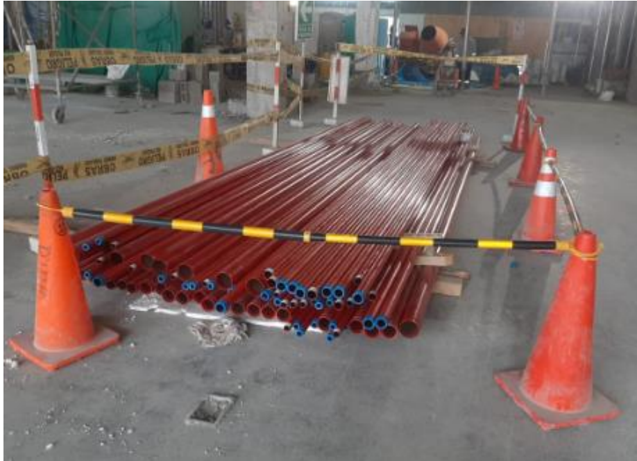
Figura 27 Tuberías de red de agua contra incendios SCH 40 y SCH 10
