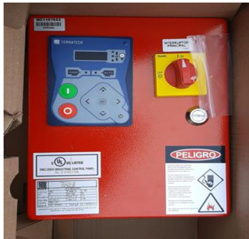
Figura 20 Tablero controlador de Bomba Jockey
