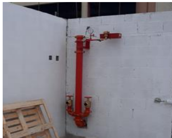
Figura 63 Purga Automática de aire instalada en el proyecto
