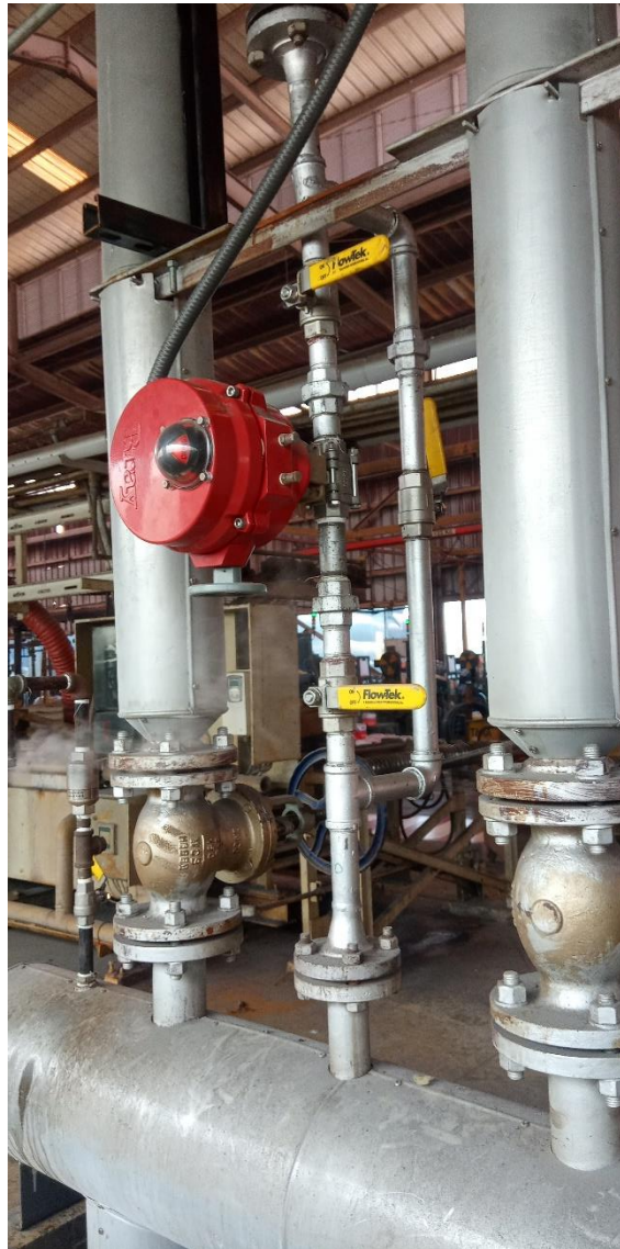
Figura N° 7 – Bypass regulador de presión
