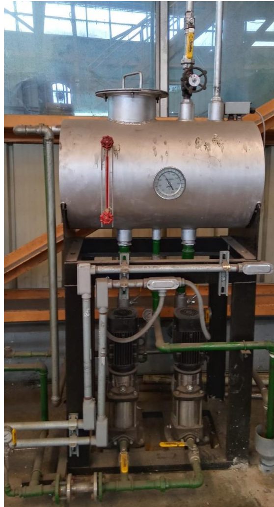
Figura N° 2 – Tanque de condensado
