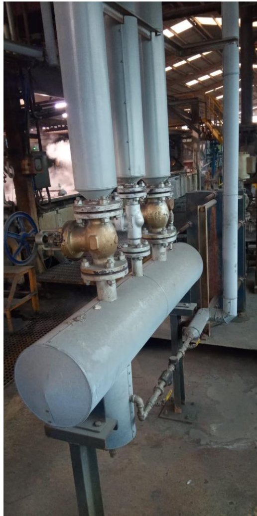
Figura N° 3 – Manifold de vapor
