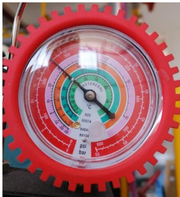
Figura III.62: Presión de manómetro en líneas de alta presión.
