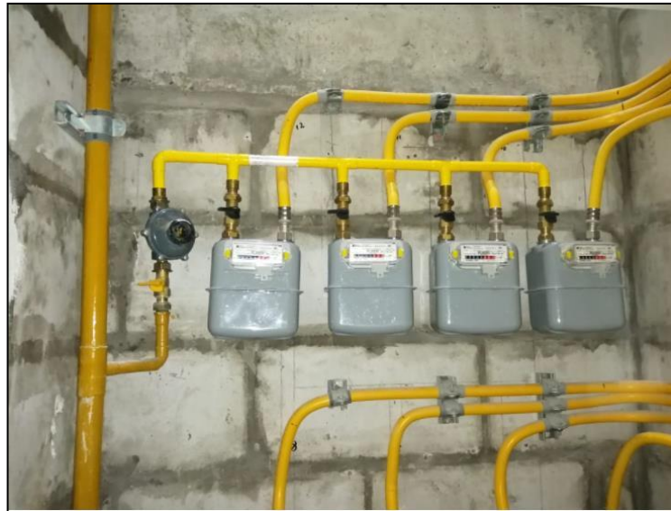
Figura 1.3 Conjunto de medidores y reguladores en conducto técnico
