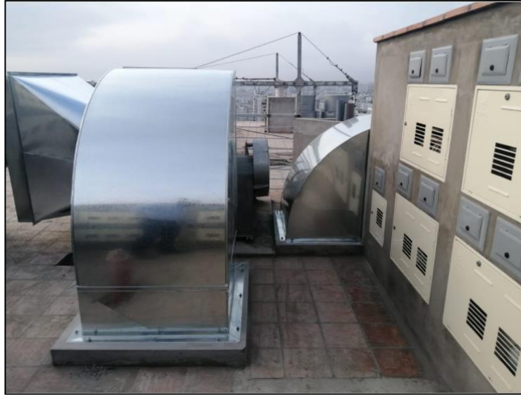
Figura I.4: Gabinetes en azotea
