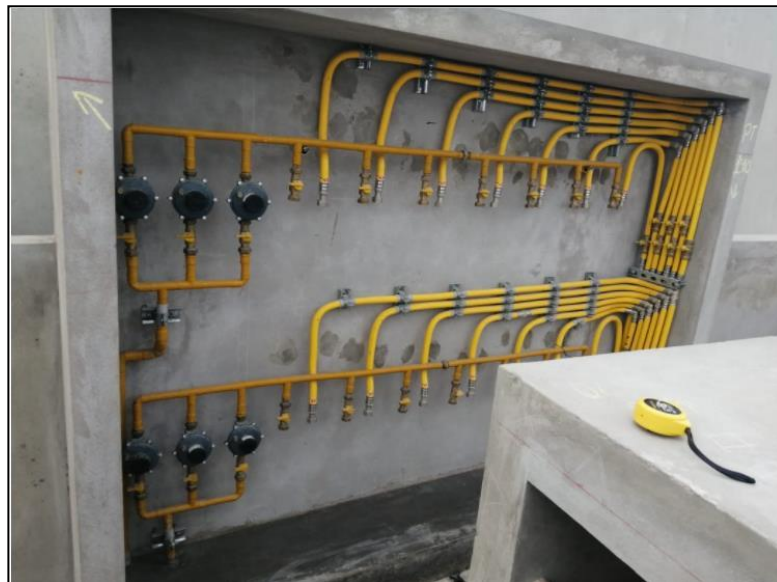
Figura I.2 Sistema de regulación y medición
