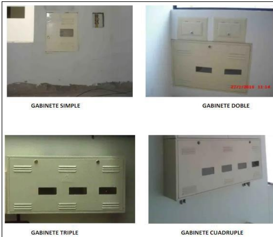
Figura II.34 Gabinetes para el uso de gas natural
