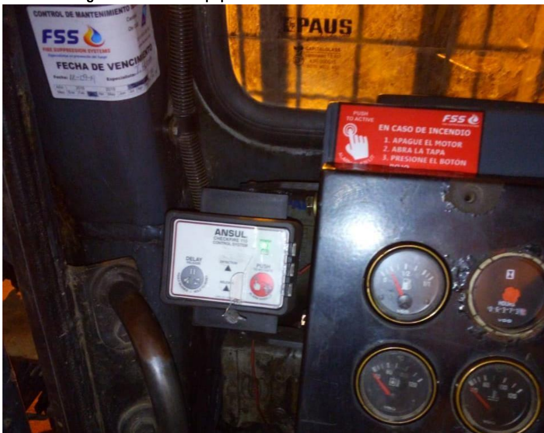
Figura 3.48: Equipo Hernan Paus con sistema ANSUL instalado
