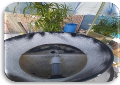
Ingreso del agua residual sin tratar a través de la trampa de grasas
