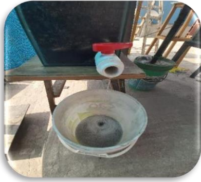
Salida del agua residual a través de los biofiltros
