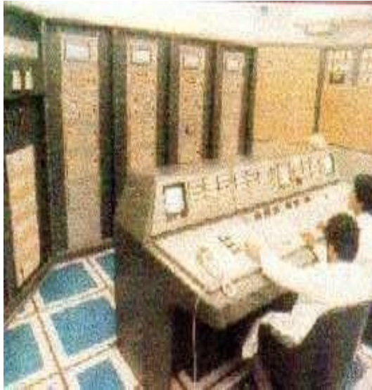
Figura N° 2 – Sala de control del Reactor RP – 10
