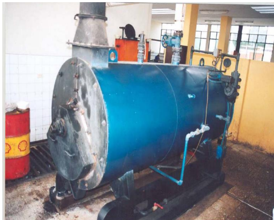
Figura N° 11: Caldero del Hospital Santa Rosa
