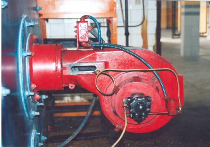
Figura N° 12: Quemador del Caldero del Hospital Santa Rosa
