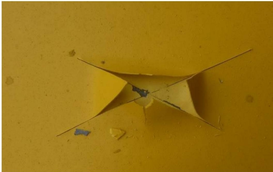
FALTA DE COHESION ENTRE PELICULA DURANTE PRUEBA DE CORTE
