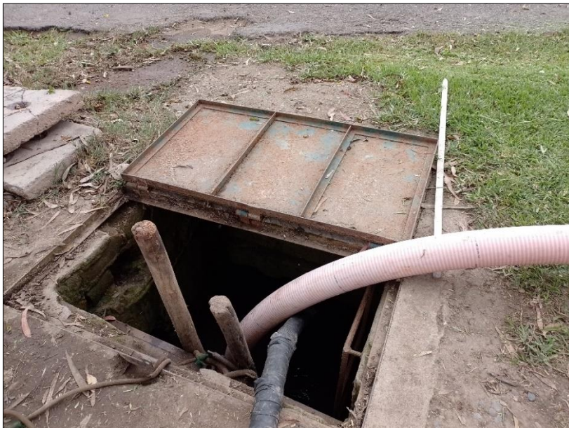
Canal de ingreso del agua de río Surco al distrito de Lince en la Av. Paseo de la República cdra. 26
