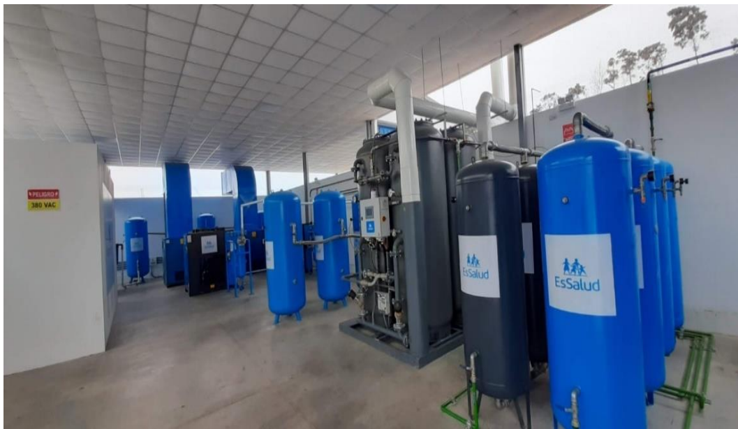
Figura 2.11 Instalación de la planta de oxígeno PSA en la villa panamericana de Villa el Salvador (ONERGY, 2022).
