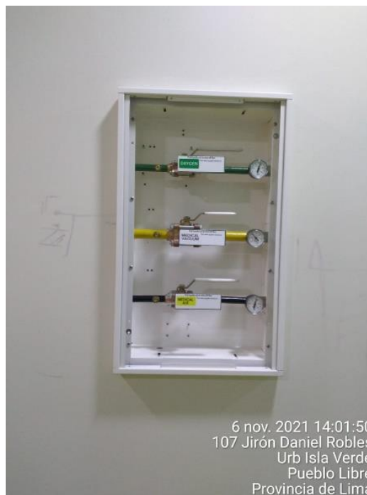
Figura 1.7 Caja de válvulas del equipamiento médico de la Clínica Peruano Japonesa (ONERGY, 2022).
