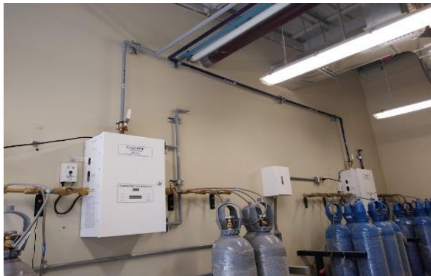
Figura 1.13 Instalación de manifold de Óxido Nitroso y CO2 en el Hospital Daniel Alcides Carrión - Cerro de Pasco (ONERGY, 2022).
