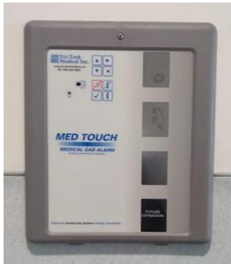
Figura 3.16 Instalación de alarma de área en el Hospital de INEN (ONERGY, 2022).
