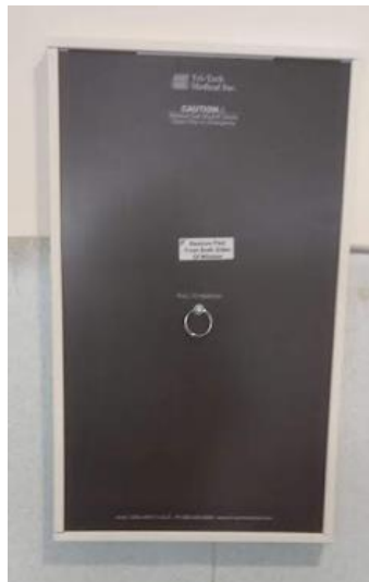
Figura 3.14 Caja de válvulas instalada en el Hospital INEN (ONERGY, 2022).
