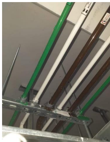
Figura 2.32 Redes de tuberías de cobre, red de oxígeno, vacío y aire medicinal del Hospital INEN (ONERGY, 2022).
