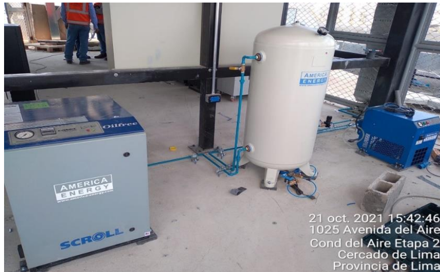
Figura 1.6 Instalación de Compresor de aire dental en el centro biomédico – Videna (ONERGY, 2022).
