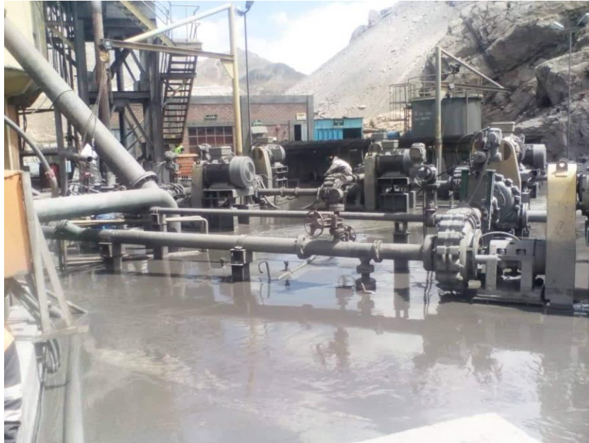
Figura 1.1 Derrame de relave producido inicialmente por falla de la bomba centrífuga horizontal Warman 6"x4" AH N° 12
