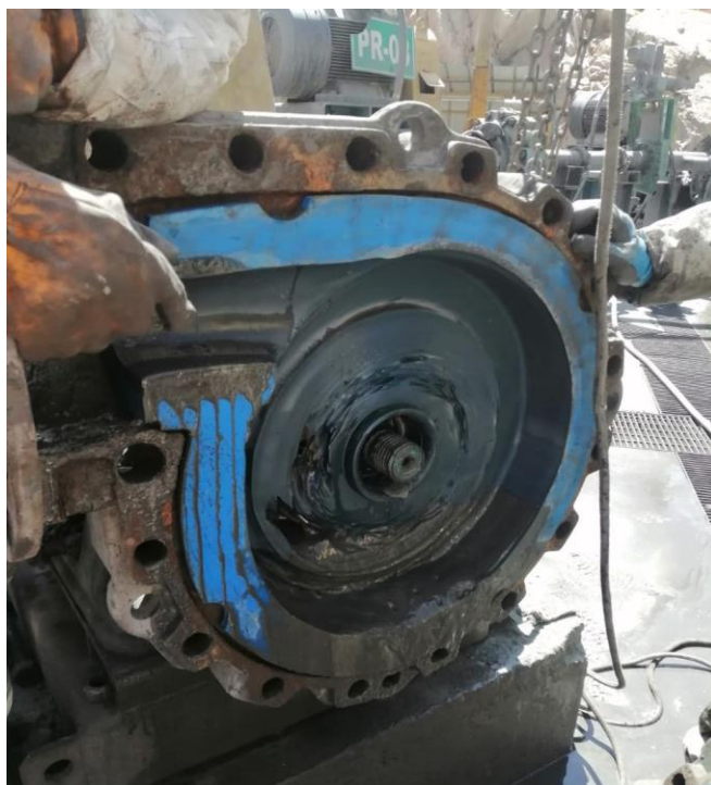
Figura 4.16 Mantenimiento programado de bomba a las 600 Horas de funcionamiento
