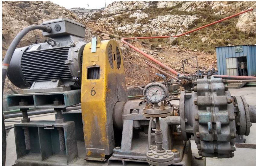
Figura 4.1 Bomba centrífuga horizontal WARMAN 6"x4" AH - N°06
