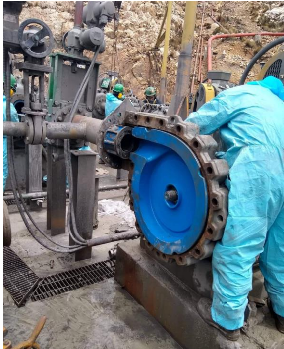
Figura 4.18 Mantenimiento programado de bomba a las 600 Horas de funcionamiento
