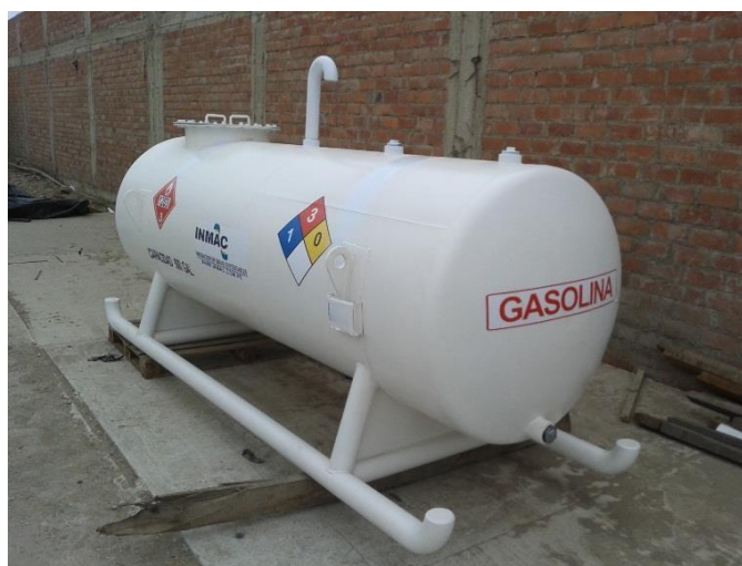
Tanque con stickers de seguridad
