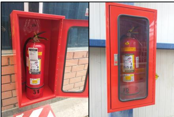
Figura 16. Inspección de extintor
