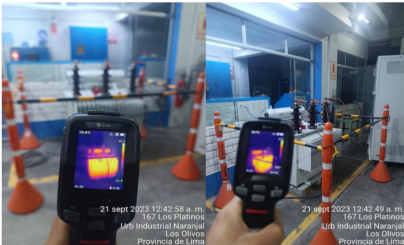
Figura N°132 Temperatura media del transformador en el transcurso de la prueba, 160 kVA
