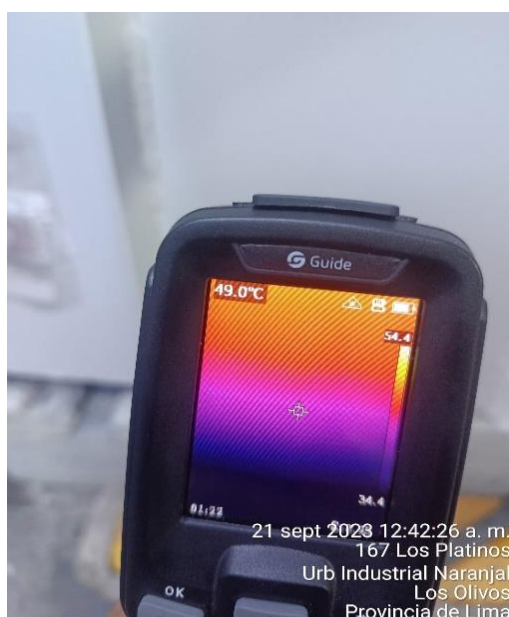
Figura N°128 Temperatura inferior cámara termográfica, 160 kVA
