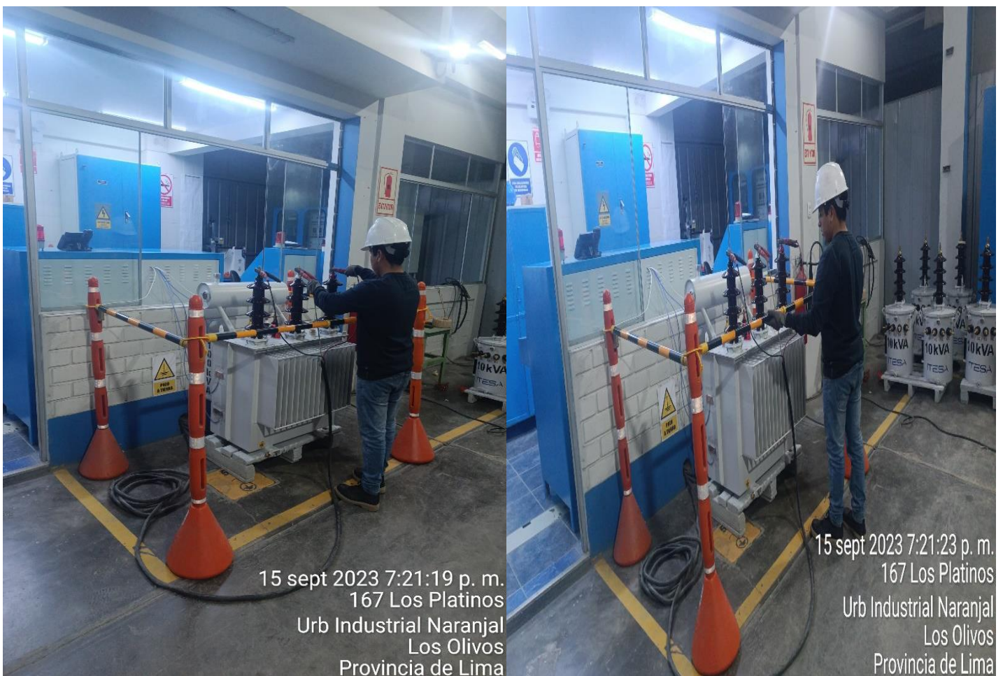
Figura N°54 Cables de pruebas para el transformador y Delimitación del área de trabajo
