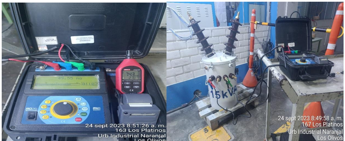
Figura N°150 Medida de resistencia de arrollamiento, lado de baja tensión x2-x4, 15 kVA Fuente: Elaboración propia
