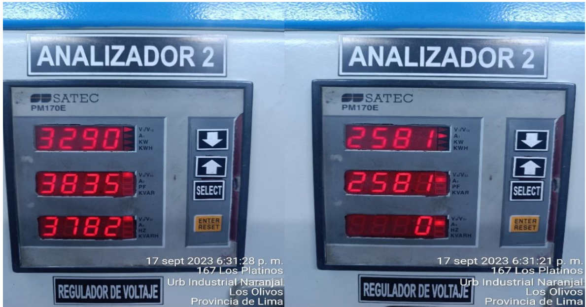
Figura N°105 Tensiones a corriente nominal, Corrientes nominales, Fase 2 de la prueba, 167 kVA
