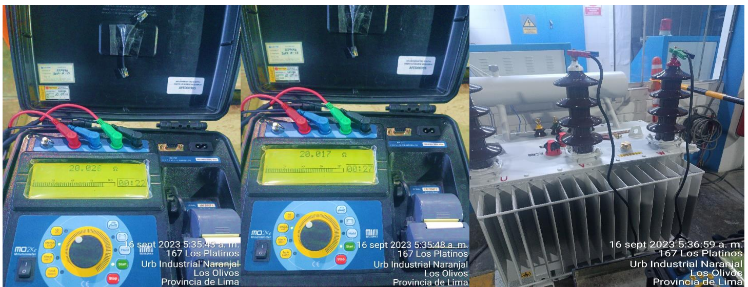
Figura N°81 Medición de resistencias en caliente, lado de media tensión, 100 kVA
