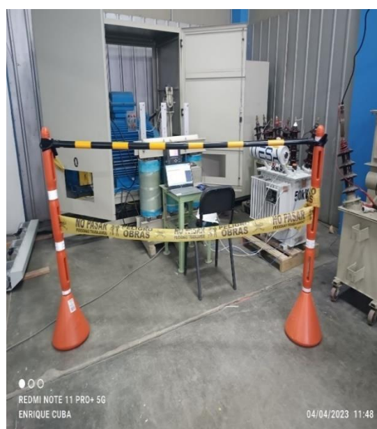
Figura N°21 Autotransformador con transformador de 50KVA
