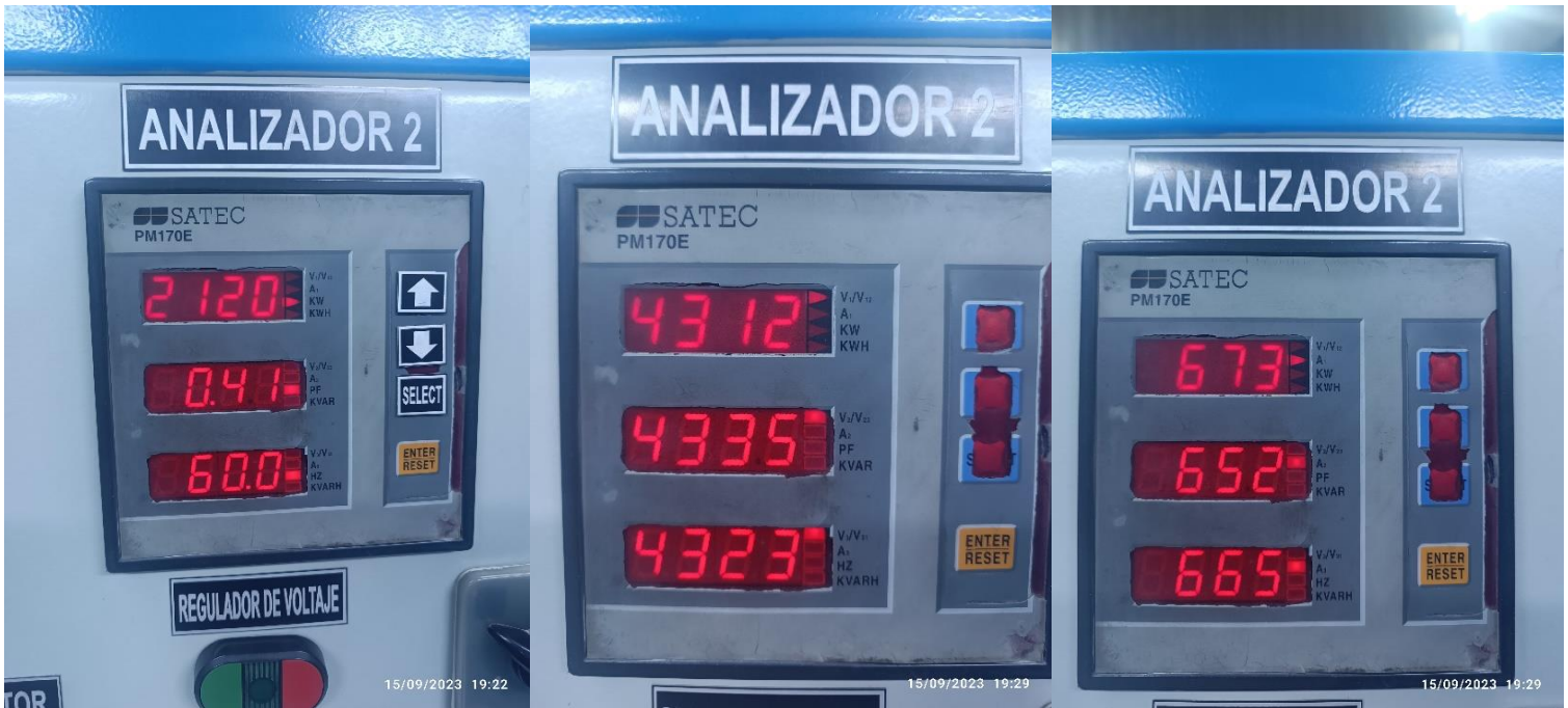
Figura N°69 Pérdidas totales y factor de potencia, Tensiones de pérdidas totales y Corrientes de pérdidas totales, 100 kVA
