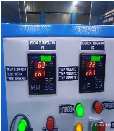
Figura N°158 Temperatura superior y ambiente N°1, en el transcurso de la prueba, 15 kVA
