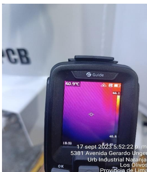
Figura N°99 Temperatura inferior cámara termográfica, 167 kVA
