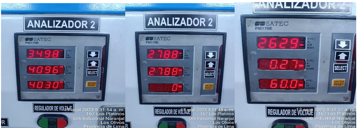
Figura N°93 Pérdidas totales, corriente y tensión al inicio de la prueba, 167 kVA
