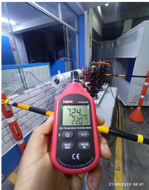
Figura N°131 Temperatura ambiente N°4 y humedad, 160 kVA
