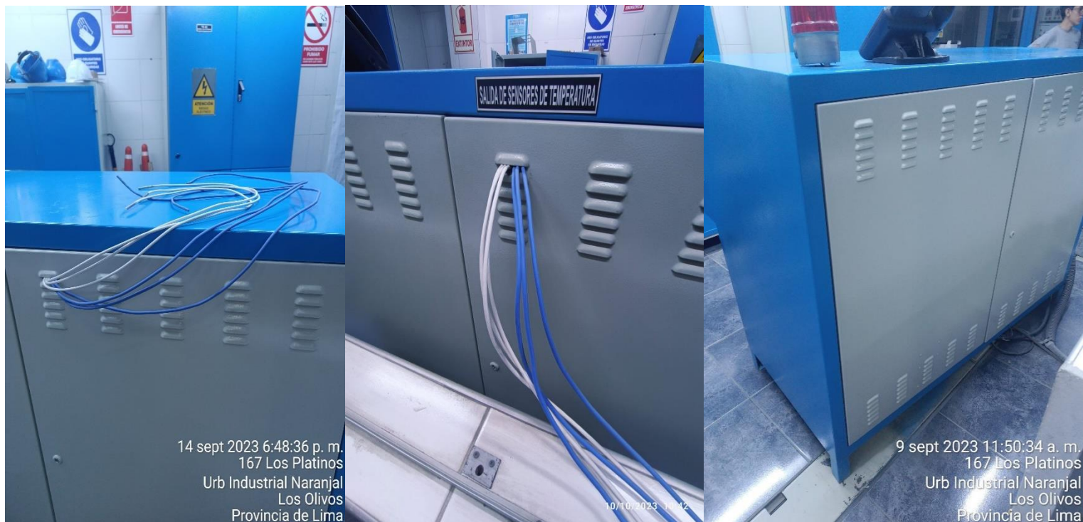
Figura N°48 Módulo eléctrico salida de sensores de temperatura y vista trasera
