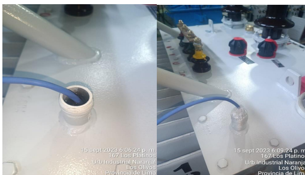
Figura N°65 Sensor en pozo termométrico, temp. Superior transformador hermetizado, 100 kVA
