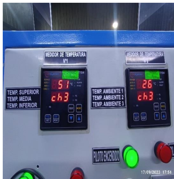
Figura N°102 Temperatura inferior y ambiente N°3, en el transcurso de la prueba, 167 kVA
