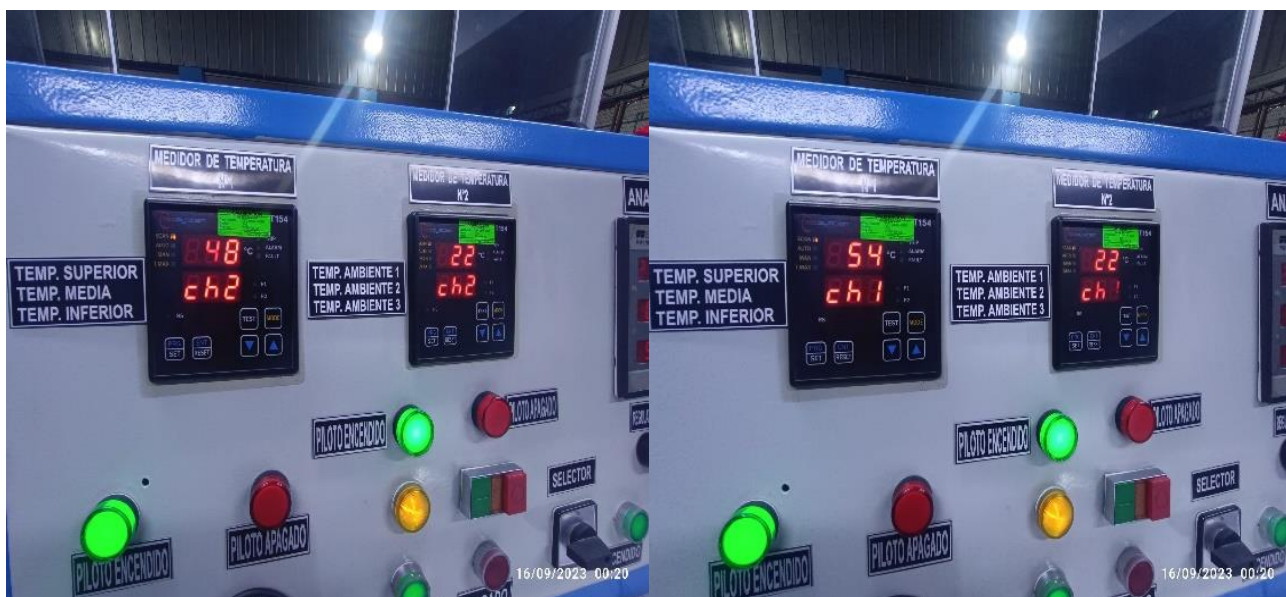
Figura N°74 Temperatura superior y ambiente N°1, en el transcurso de la prueba y Temperatura media y ambiente N°2, en el transcurso de la prueba, 100 kVA
