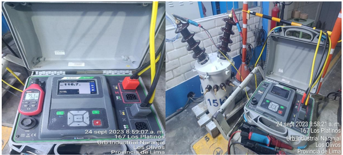
Figura N°148 Medida de resistencia de arrollamiento, lado de media tensión, 15 kVA Fuente: Elaboración propia
