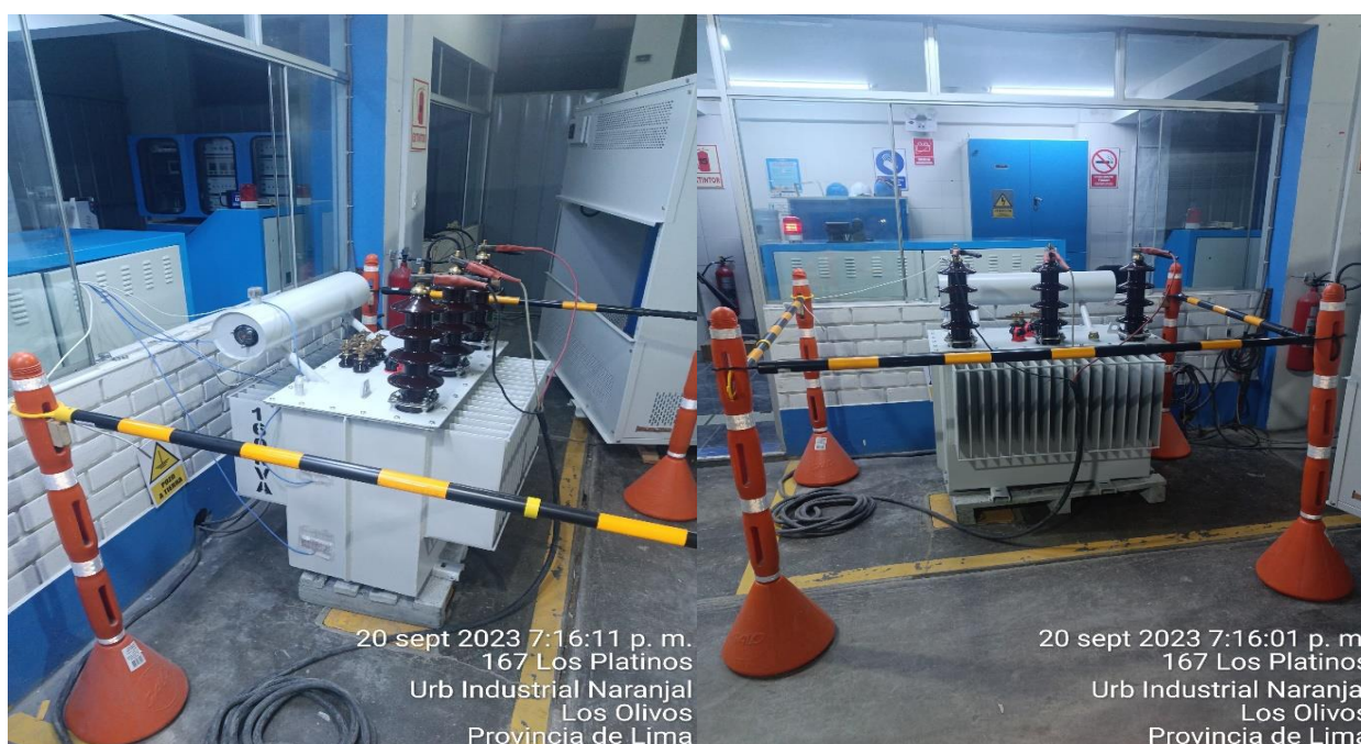
Figura N°117 transformador terminado y conectado para la prueba, 160 kVA
