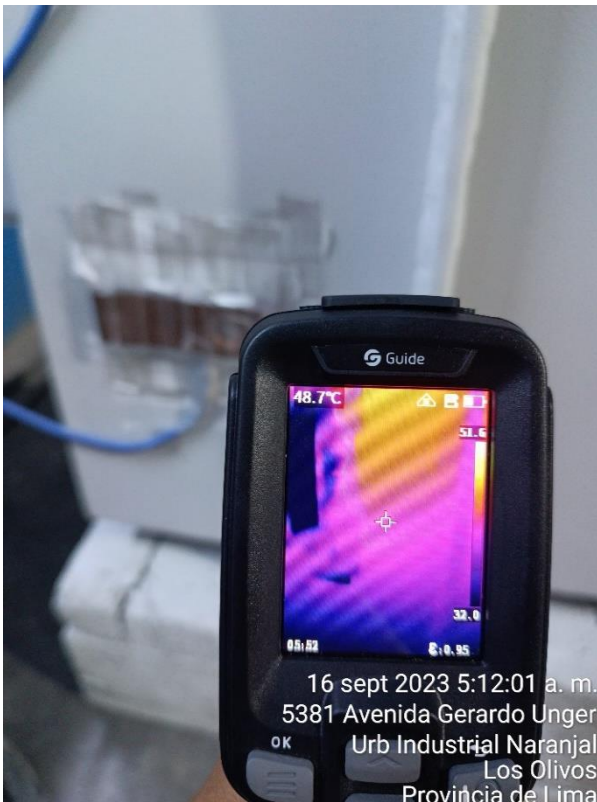
Figura N°59 Temperatura inferior transformador trifásico Fuente: Elaboración propia
