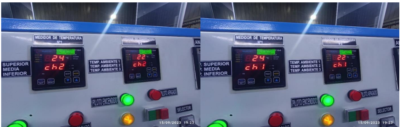
Figura N°70 Temperatura superior y ambiente N°1 y Temperatura media y ambiente N°2, 100 kVA
