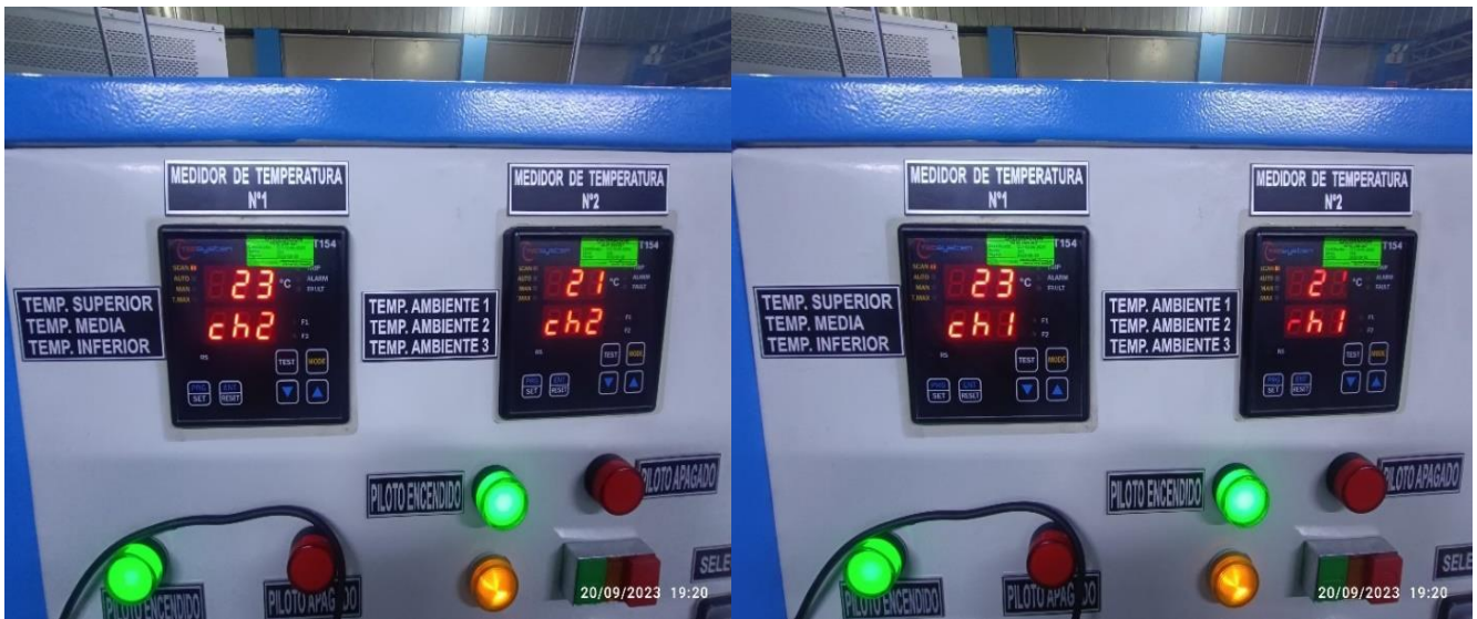
Figura N°125 Temperatura superior y ambiente N°1, Temperatura media y ambiente N°2, 160 kVA
