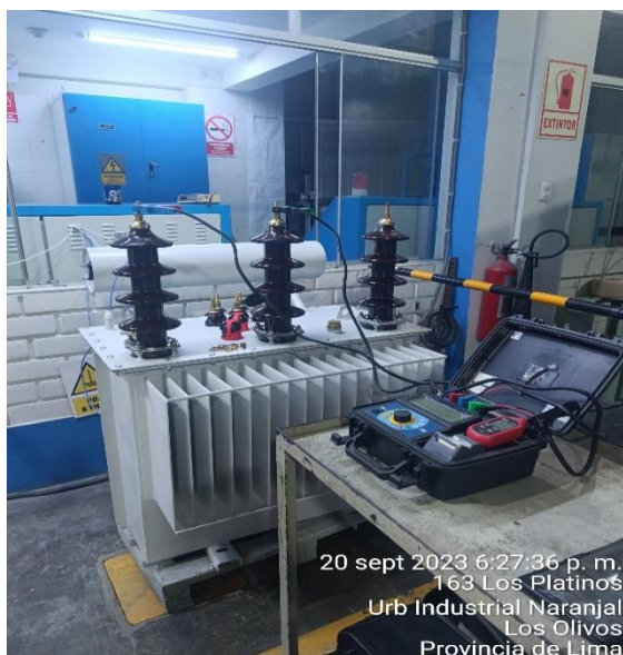
Figura N°120 Medición de resistencia media tensión, 160 kVA Fuente: Elaboración propia
