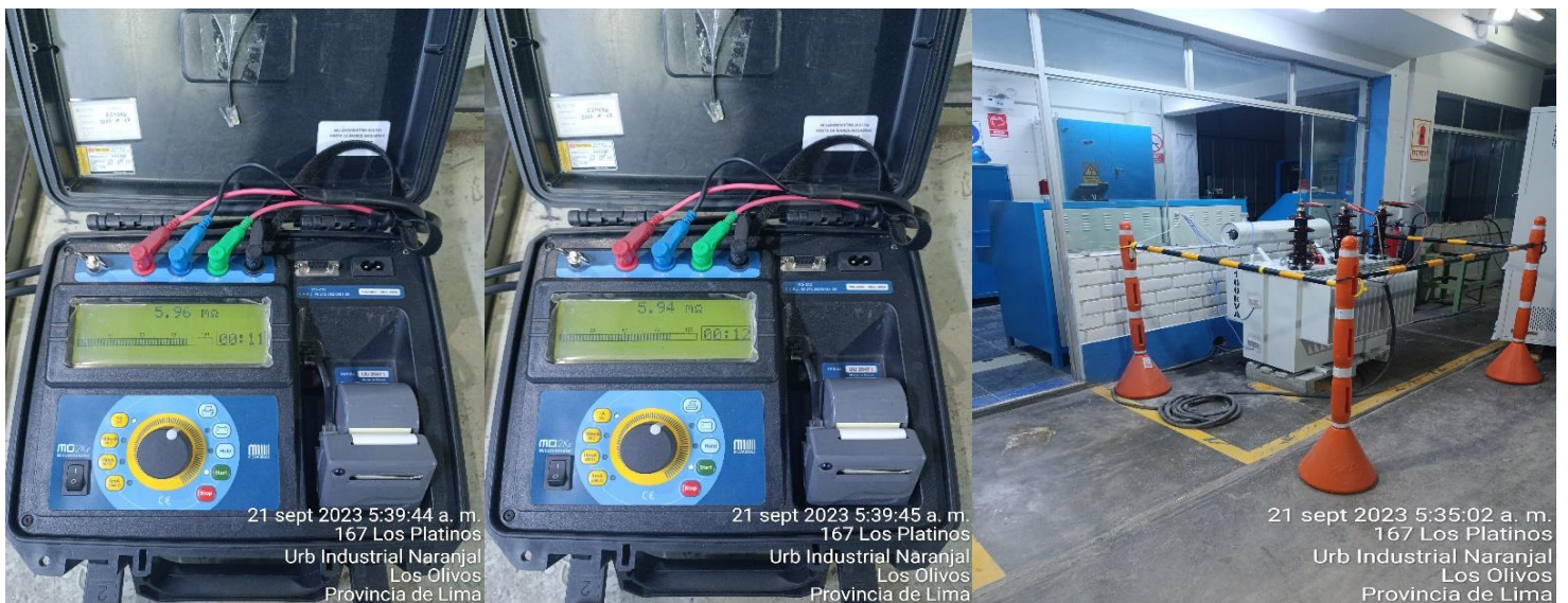
Figura N°136 Medición de resistencias en caliente, lado de baja tensión, 160 kVA
