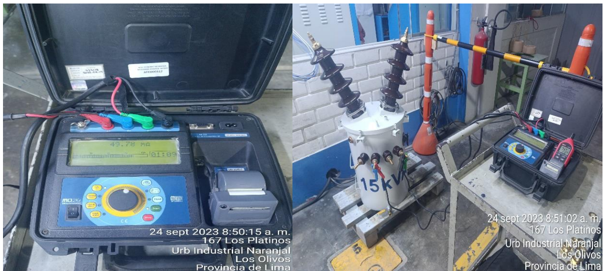
Figura N°149 Medida de resistencia de arrollamiento, lado de baja tensión x1-x3, 15 kVA Fuente: Elaboración propia
