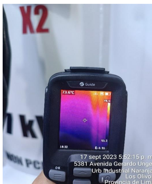
Figura N°98 Temperatura media cámara termográfica, 167 kVA
