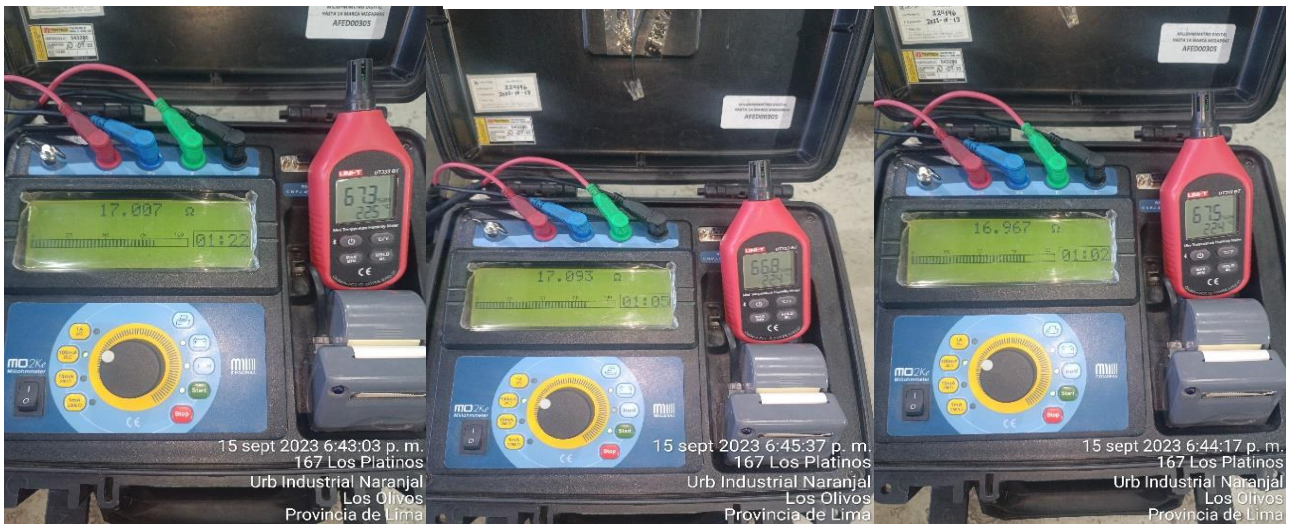
Figura N°67 Medidas de resistencias de arrollamientos, lado de media tensión, 100 kVA
