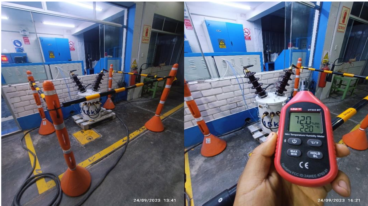
Figura N°161 Temperatura ambiente N°4 y humedad en el transcurso de la prueba, 15 kVA
