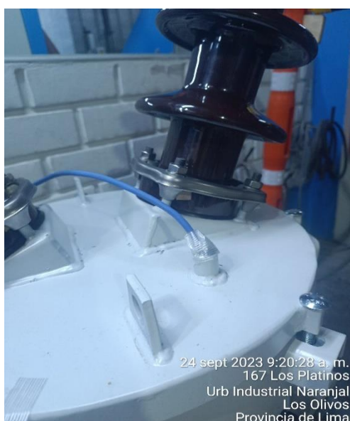
Figura N°146 Sensor por válvula de alivio, temp. Superior, 15 kVA Fuente: Elaboración propia
