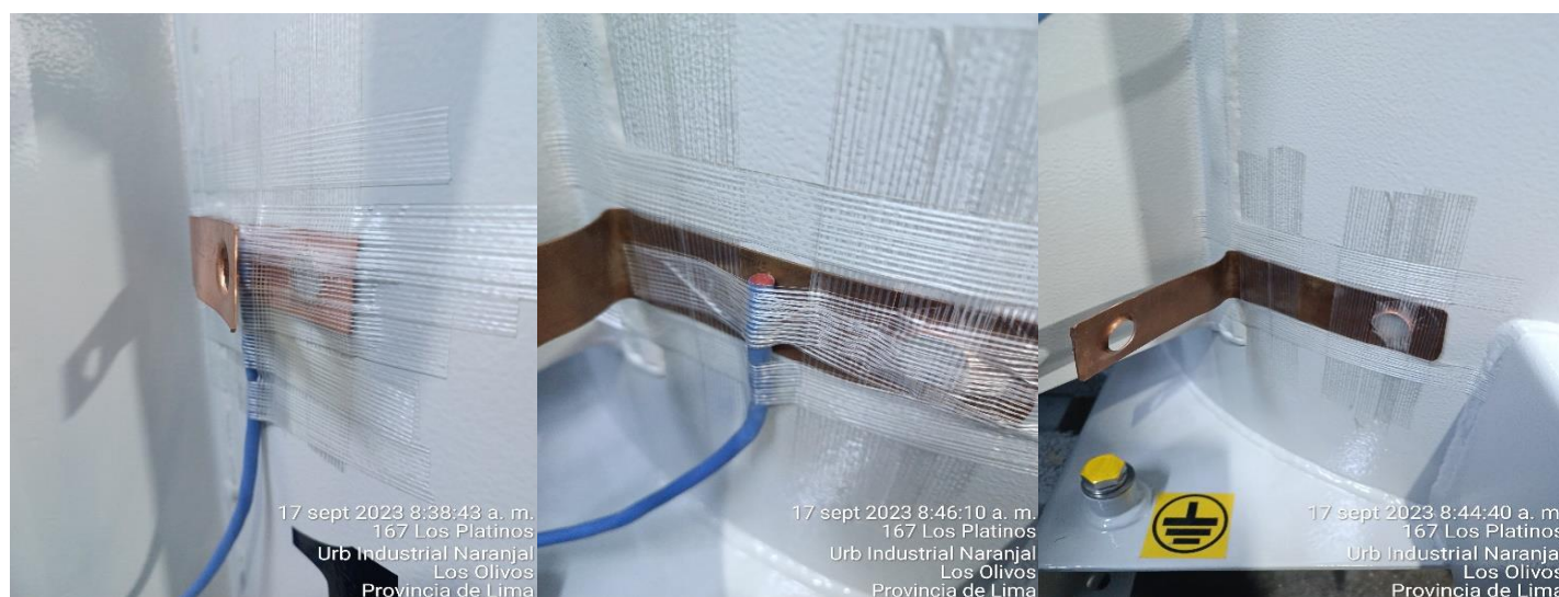
Figura N°89 Colocación de plancha metálica de cobre, sensor de temperatura y montaje con cinta filamentada, 167 kVA
