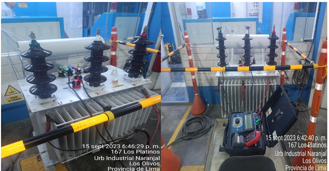
Figura N°68 Medición de resistencia media y baja tensión, 100 kVA
