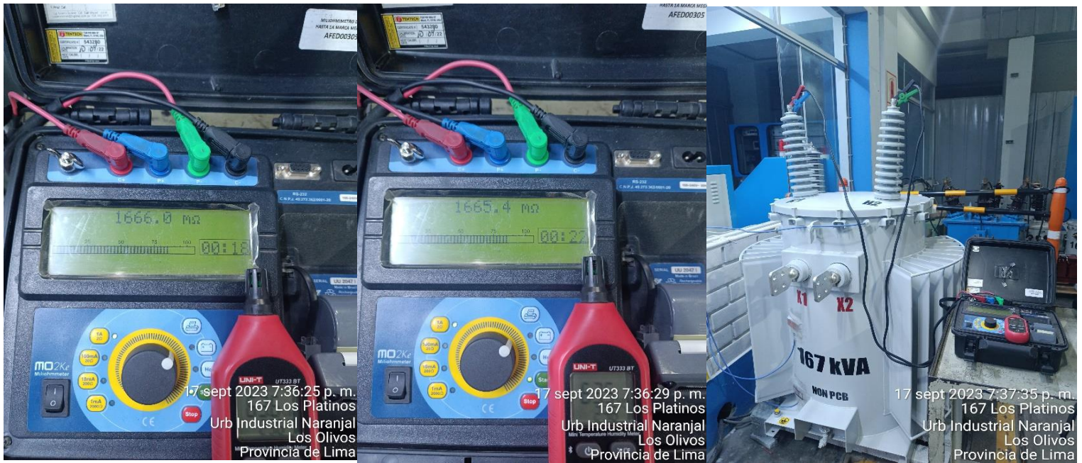
Figura N°107 Medición de resistencias en caliente, lado de media tensión, 167 kVA
