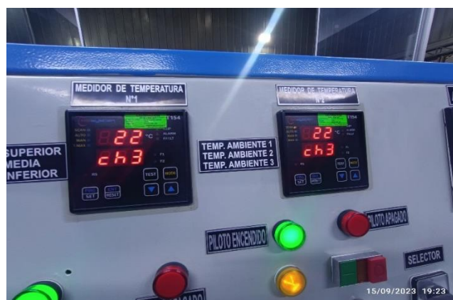
Figura N°71 Temperatura inferior y ambiente N°3, 100 kVA
