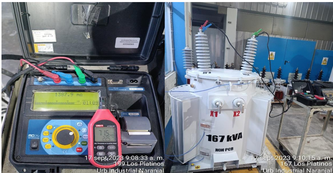
Figura N°92 Medida de resistencia de arrollamiento, lado de media tensión, 167 kVA Fuente: Elaboración propia
