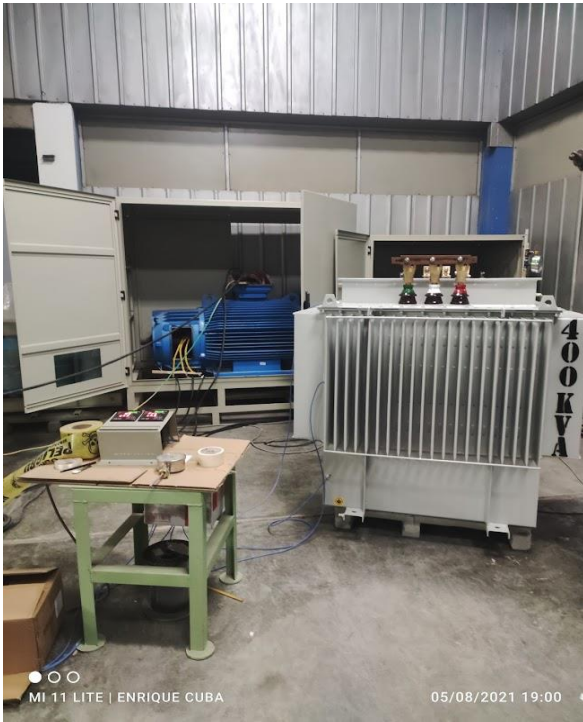
Figura N°24 Autotransformador con transformador de 400 KVA Fuente: Elaboración propia
