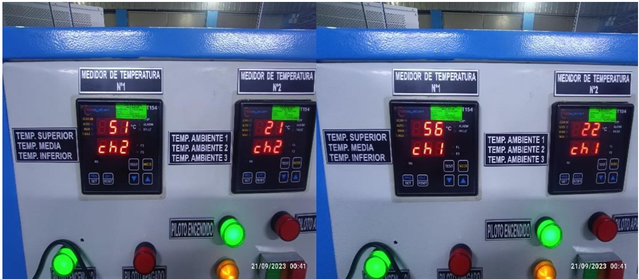
Figura N°129 Temperatura superior y ambiente N°1, Temperatura media y ambiente N°2 en el transcurso de la prueba, 160 kVA
