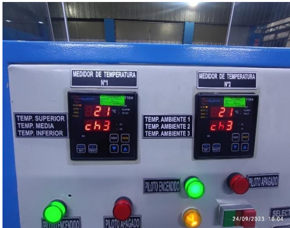
Figura N°155 Temperatura inferior y ambiente N°4, 15 kVA Fuente: Elaboración propia
