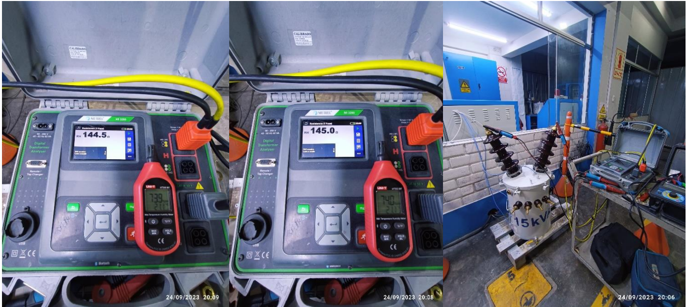
Figura N°164 Medición de resistencias en caliente, lado de media tensión, 15 kVA
