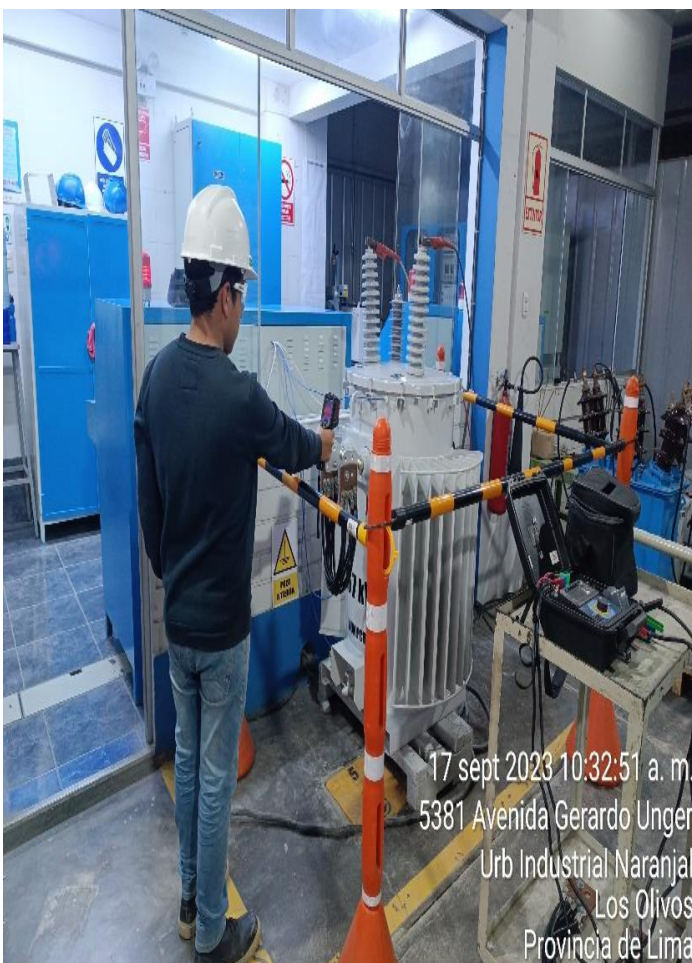
Figura N°55 Medidas de la temperatura con cámara termográfica
