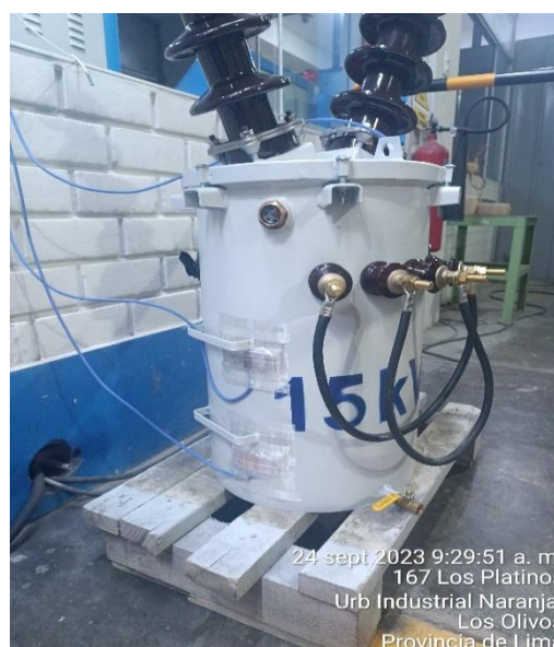
Figura N°147 transformador terminado, 15 kVA Fuente: Elaboración propia
