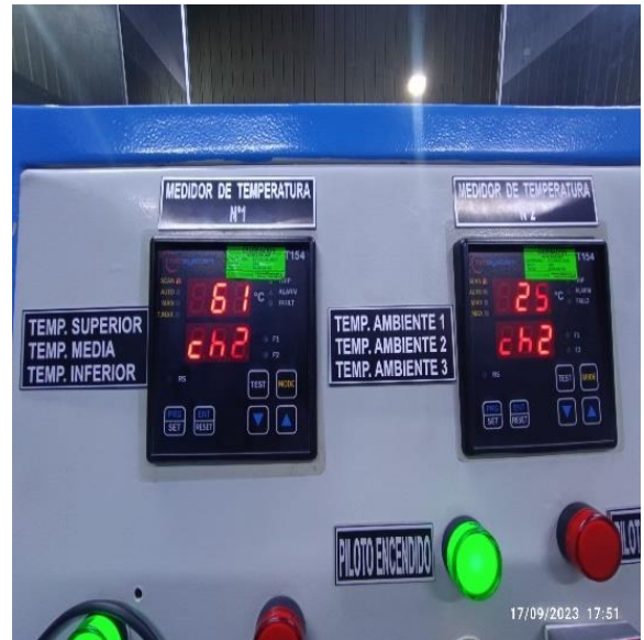
Figura N°101 Temperatura media y ambiente N°2, en el transcurso de la prueba, 167 kVA
