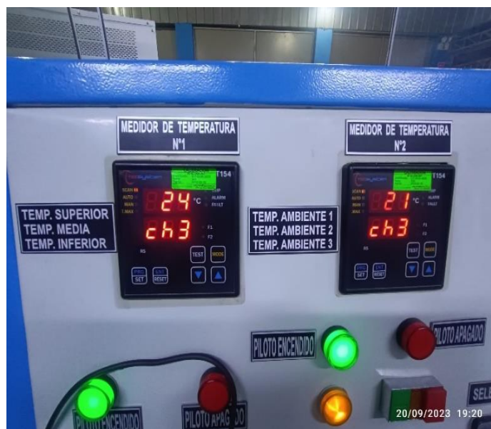
Figura N°126 Temperatura inferior y ambiente N°3, 160 kVA
