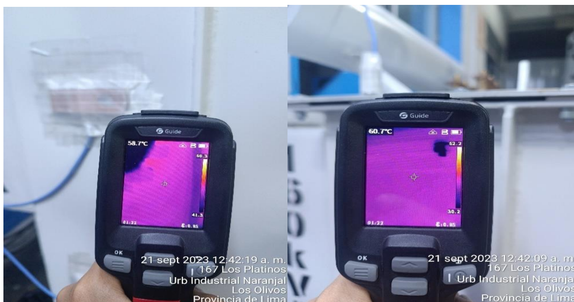
Figura N°127 Temperatura superior cámara termográfica, Temperatura media cámara termográfica, 160 kVA
