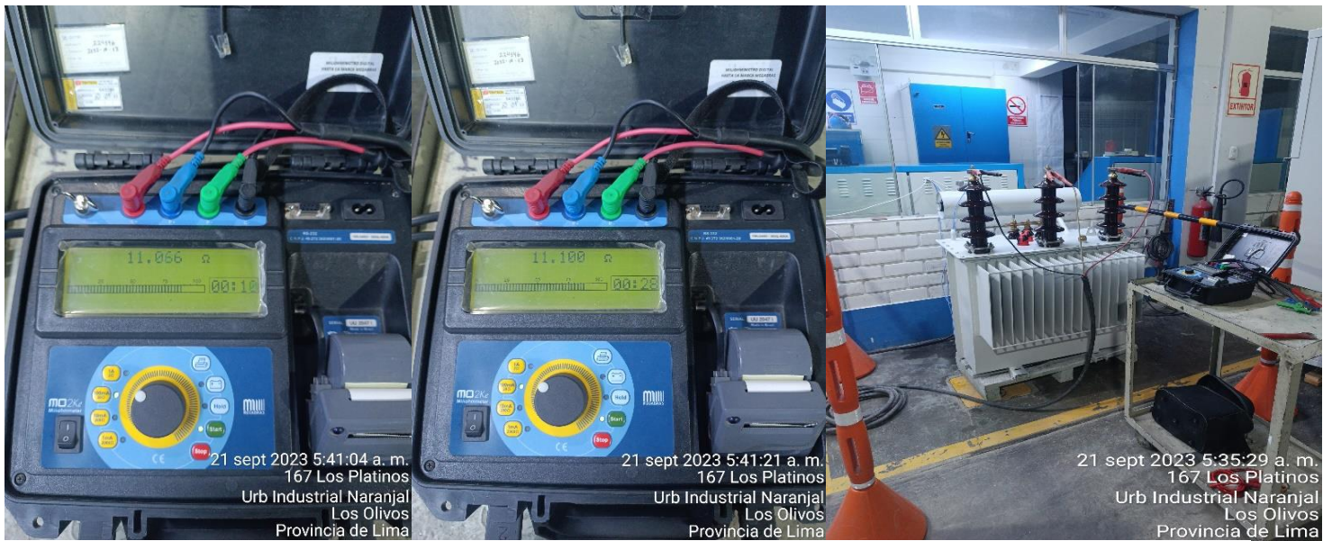
Figura N°135 Medición de resistencias en caliente, lado de media tensión, 160 kVA
