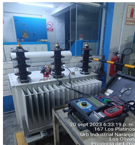
Figura N°121 Medición de resistencia baja tensión, 160 kVA Fuente: Elaboración propia
