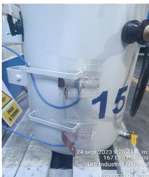
Figura N°144 Colocación de sensor de temperatura, 15 kVA Fuente: Elaboración propia
