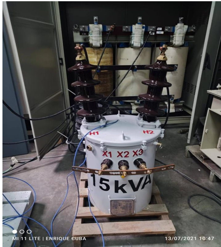
Figura N°29 Prueba de calentamiento transformador de 15 KVA
