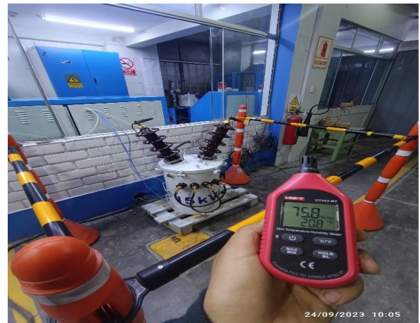
Figura N°156 Temperatura ambiente N°4 y humedad, 15 kVA Fuente: Elaboración propia
