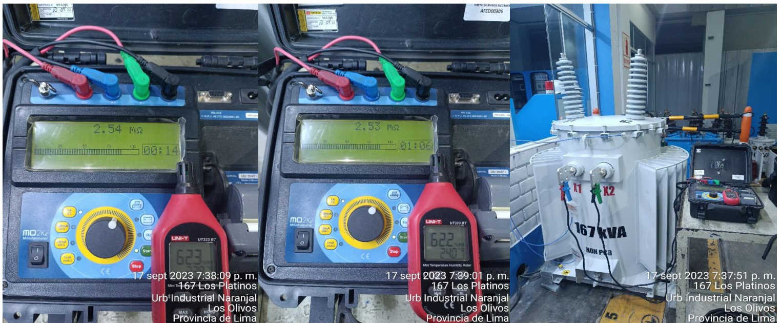
Figura N°108 Medición de resistencias en caliente, lado de baja tensión, 167 kVA
