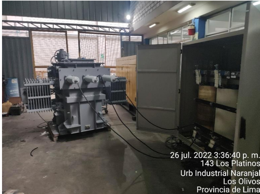
Figura N°27 Prueba de calentamiento transformador de 630 KVA
