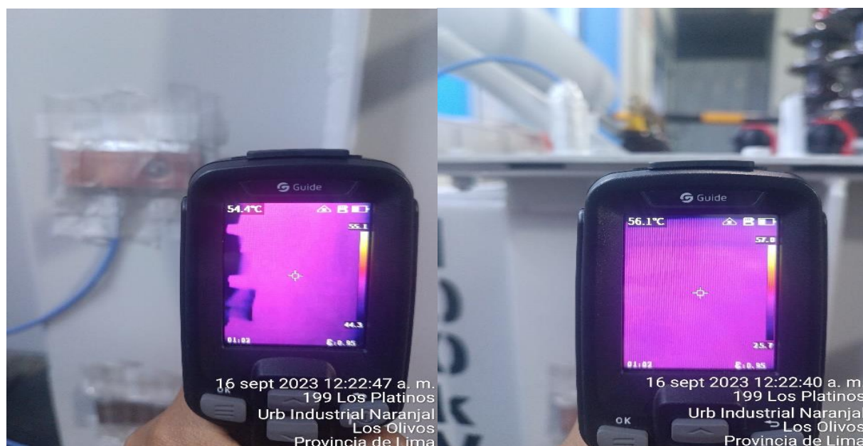
Figura N°72 Temperatura superior cámara termográfica y Temperatura media cámara termográfica, 100 kVA
