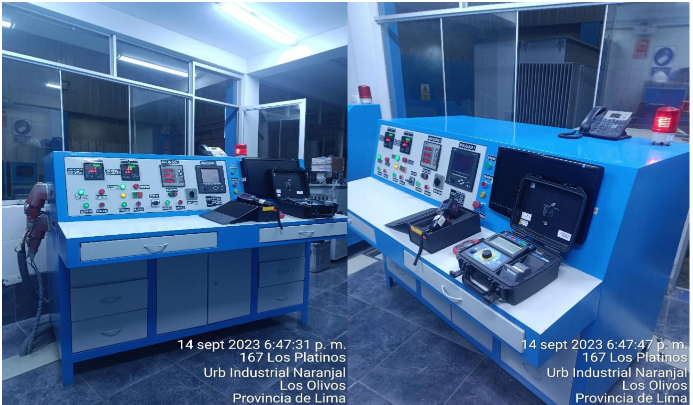
Figura N°47 Módulo eléctrico con todo su equipamiento, cámara termográfica y miliohmimetro digital
