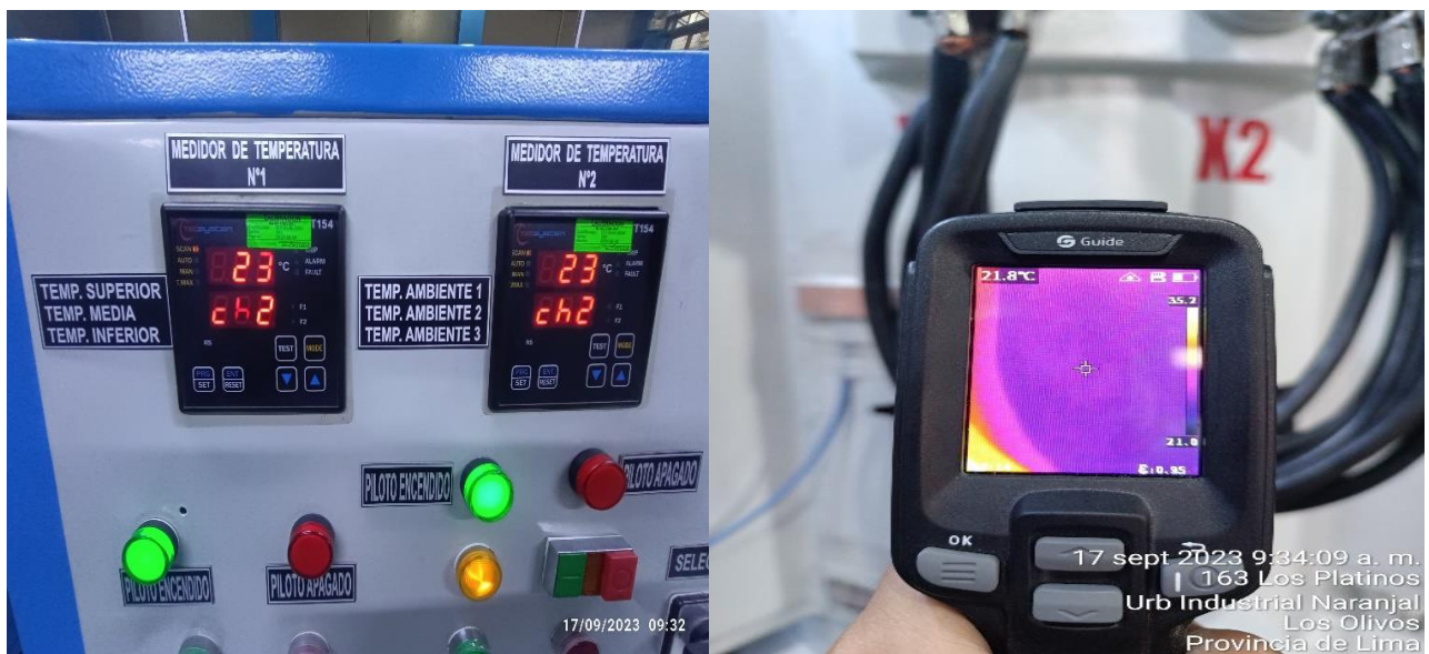
Figura N°95 Temperatura media medidor temperatura y cámara termográfica, ambiente N°2, 167 kVA
