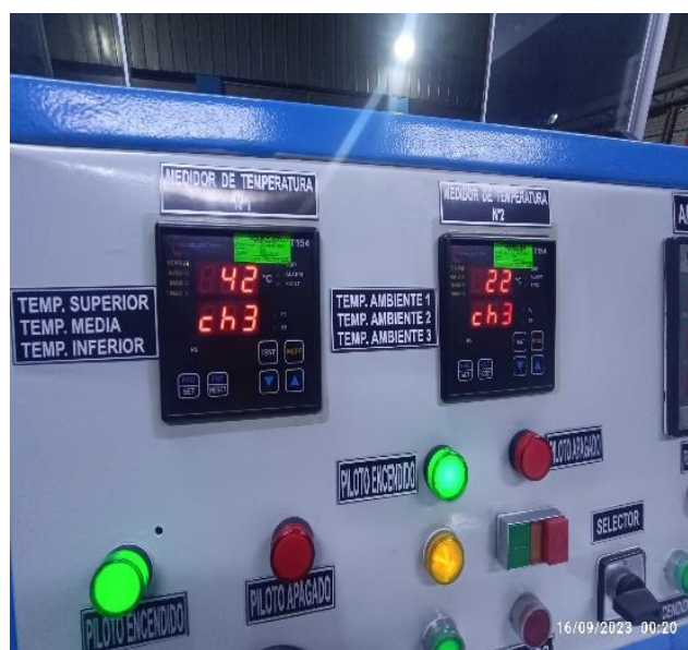
Figura N°75 Temperatura inferior y ambiente N°3, en el transcurso de la prueba, 100 kVA
