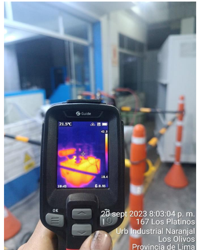
Figura N°60 Temperatura media de transformador trifásico
