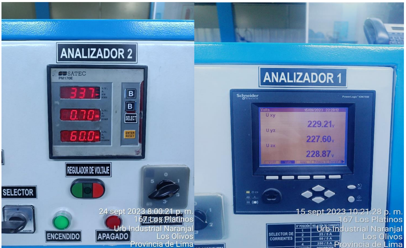
Figura N°62 Analizador de redes N°2, verificación de tensión y corriente en tablero general de sala de pruebas y Analizador de redes N°1, inyección de pérdidas totales y factor de potencia de la prueba
