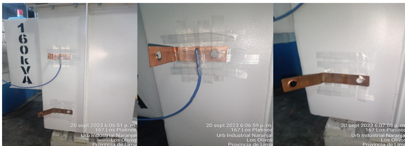
Figura N°116 Colocación de plancha metálica de cobre, sensor de temperatura y montaje con cinta filamentada, 160 kVA
