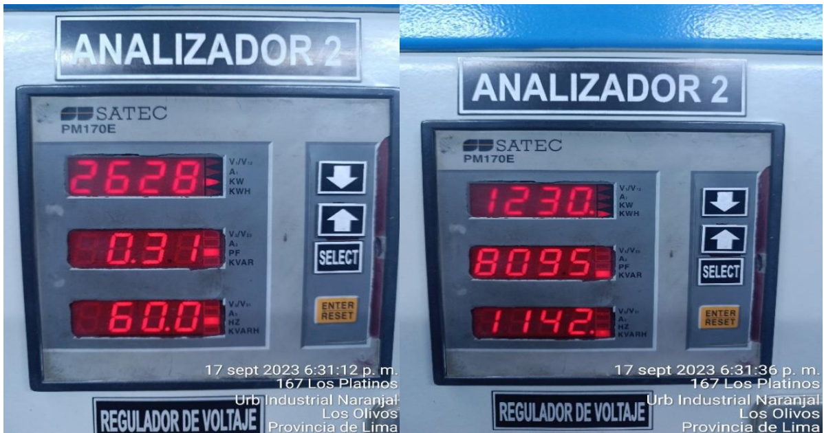
Figura N°106 Perdidas a corriente nominal, Perdidas reactivas a corriente nominal, Fase 2 de la prueba, 167 kVA
