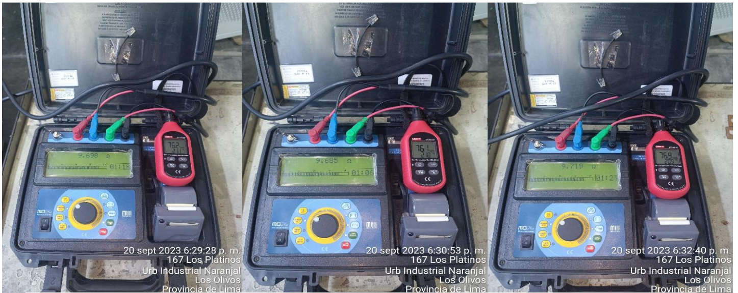
Figura N°119 Medidas de resistencias de arrollamientos, lado de media tensión, 160 kVA Fuente: Elaboración propia
