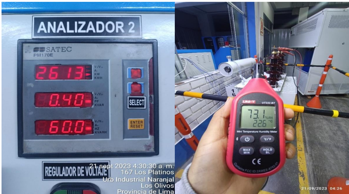
Figura N°134 Perdidas a corriente nominal y Humedad a corriente nominal, 160 kVA
