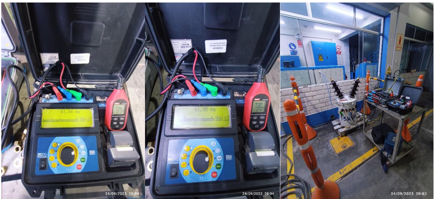
Figura N°165 Medición de resistencias en caliente, lado de baja tensión, 15 kVA
