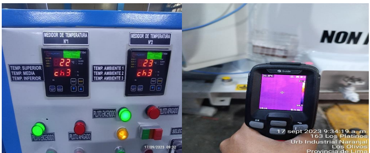
Figura N°96 Temperatura inferior medidor temperatura y cámara termográfica, ambiente N°3, 167 kVA
