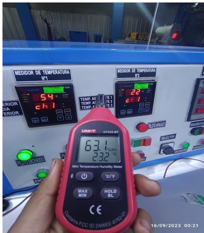
Figura N°76 Temperatura ambiente N°4 y humedad, 100 kVA
