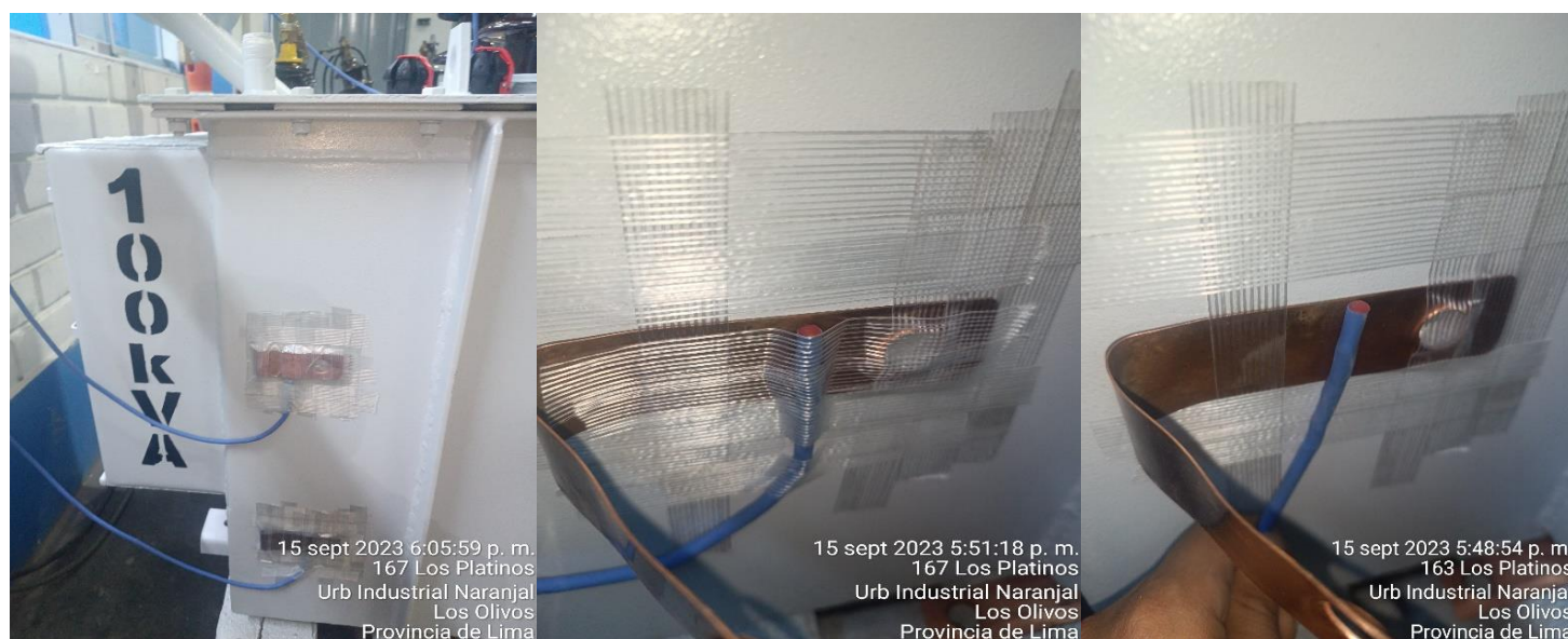
Figura N°64 Colocación de placa metálica de cobre, Colocación de sensor de temperatura y Montaje con cinta filamentada, 100 kVA
