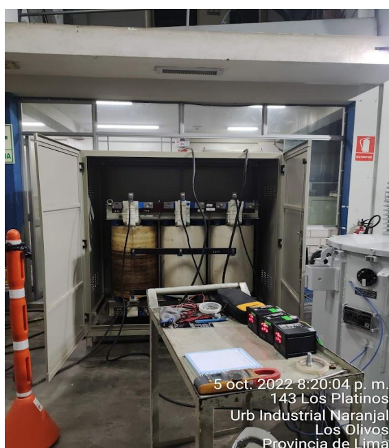
Figura N°22 Autotransformador de apoyo
