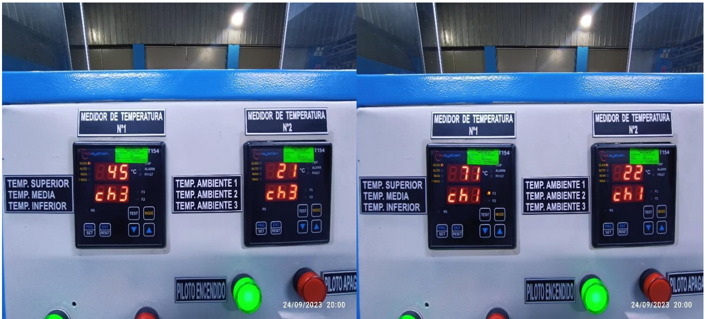
Figura N°61 Medidor de temperatura, medida del aceite superior y ambiente 1 - Medidor de temperatura, medida del aceite inferior y ambiente 3
