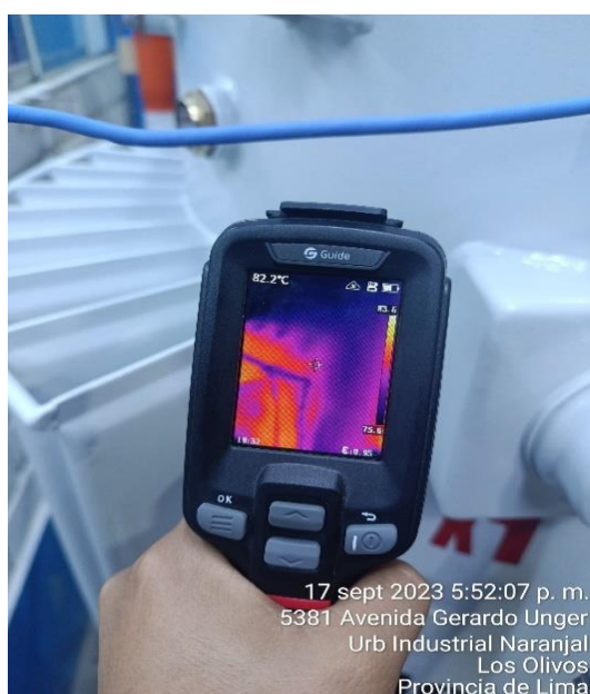
Figura N°97 Temperatura superior cámara termográfica, 167 kVA
