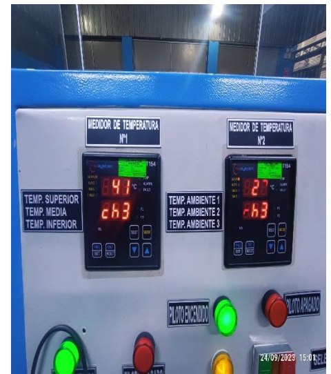
Figura N°160 Temperatura inferior y ambiente N°3, en el transcurso de la prueba, 15 kVA
