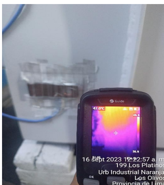
Figura N°73 Temperatura inferior cámara termográfica, 100 kVA
