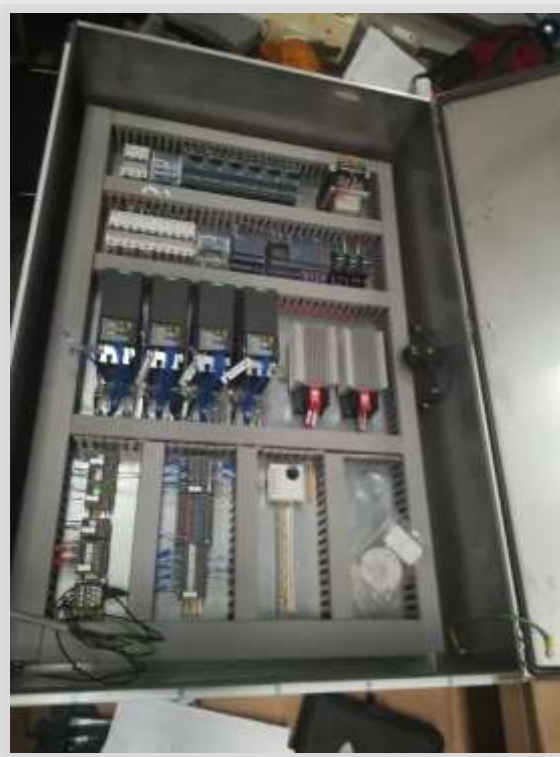
Figura 23. Gabinete principal de control Fuente: Fuente Propio
