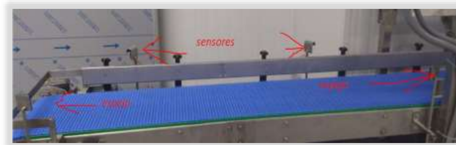
Figura 26. Ubicación de los sensores en el sistema de transporte Fuente: Fuente Propio
