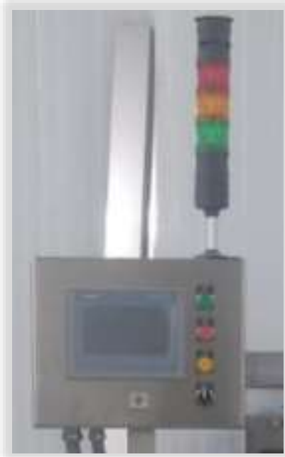
Figura 24. Gabinete principal de control Fuente: Fuente Propio
