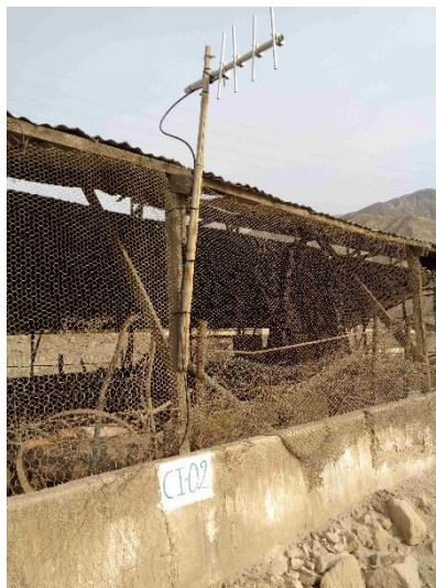
Figura N° 5. 19 Instalación de antena yagi en la estación CI-02
