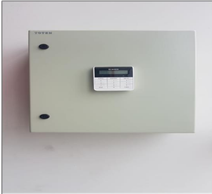
Figura 2.7 Panel de intrusión principal
