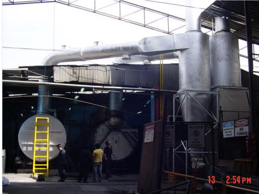
IMAGEN N°4.1 CICLON EN CALDERAS DE PETROLEO RESIDUAL
