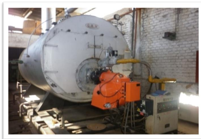
IMAGEN N° 2.1 CALDERA PIROTUBULAR DE 200 BHP
