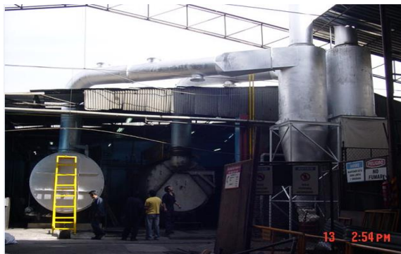
IMAGEN N° 5.0 CICLON EN CALDERAS RECEPCION Y ALMACENAJE DE HOLLIN
