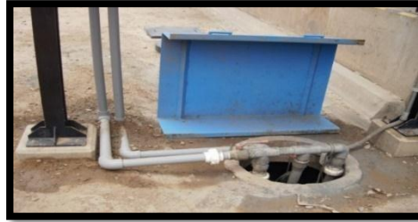
Figura Nº 1 CÁMARA DE POZO DE AGUA CON PINTURA
