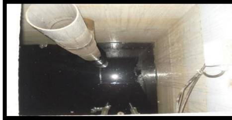
Figura № 7 CISTERNA DE ECUALIZACIÓN
