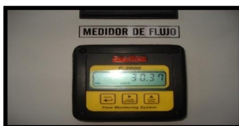
Figura № 20 MEDIDOR DE FLUJO
