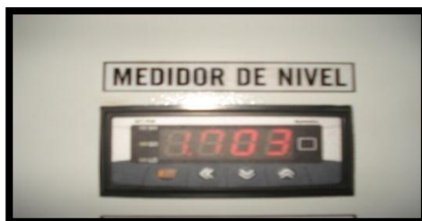
Figura № 19 MEDIDOR DE NIVEL – SENSOR ULTRASONICO
