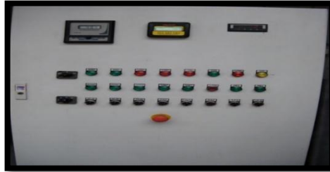
Figura № 16 TABLERO DE CONTROL Y MANDO – VISTA EXTERNA
