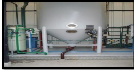
Figura № 10 TANQUE DE SEDIMENTACIÓN
