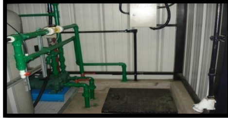
Figura № 13 LÍNEA DE AGUA TRATADA HACIA LA CISTERNA DE ALMACENAMIENTO
