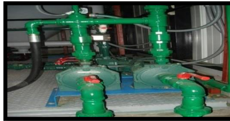
Figura № 14 BOMBAS CENTRÍFUGAS DE AGUA TRATADA
