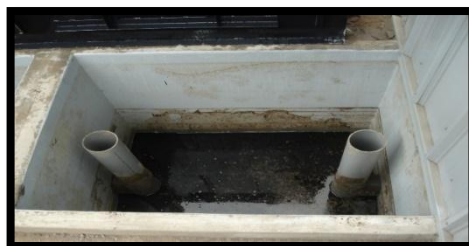
Figura № 6 CÁMARA DE SEDIMENTACIÓN SECUNDARIA
