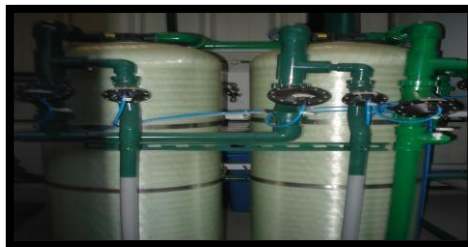
Figura № 12 FILTROS DE CUARZO – LÍNEAS DE TUBERÍA AGUA TRATADA Y SIN TRATAR
