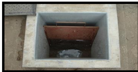
Figura Nº 3 CÁMARA DE REJAS
