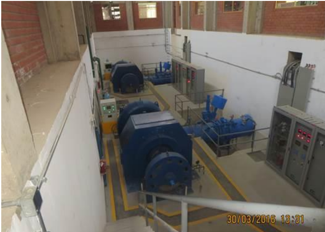
Figura N°68. Sala de Máquinas-Generadores 01 y 02.
