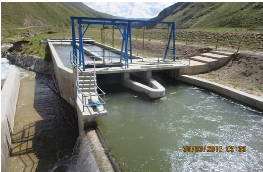
Figura N°29. Sistema de Tecles de 2 Tn para izaje de compuertas de las naves del desarenador.
