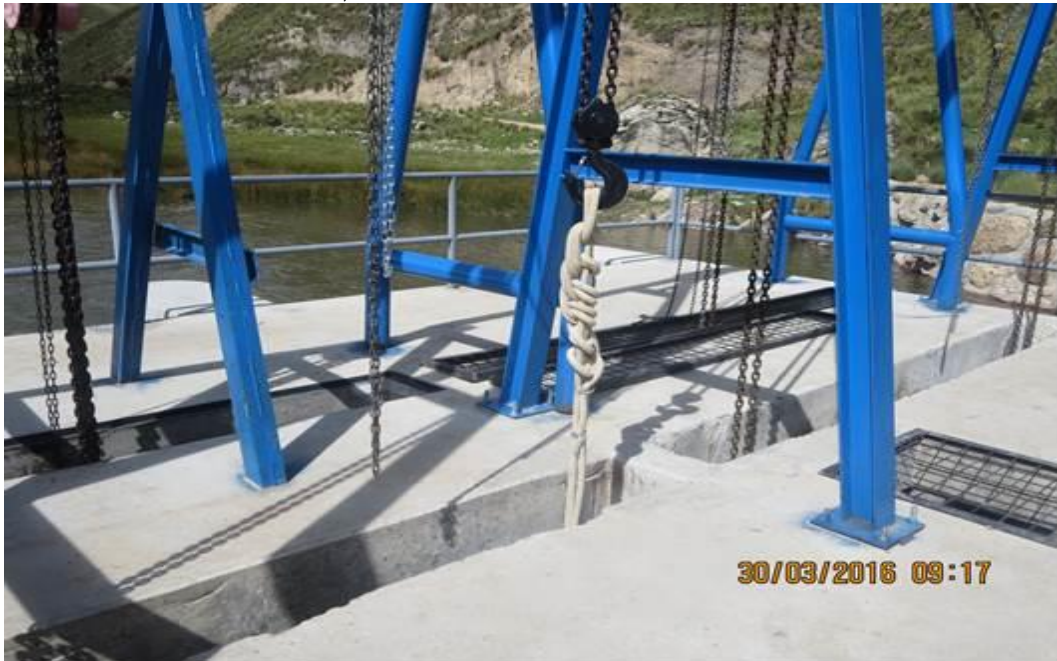
Figura N°26. Sistema de Tecles de 5Tn para izajes de compuerta.
