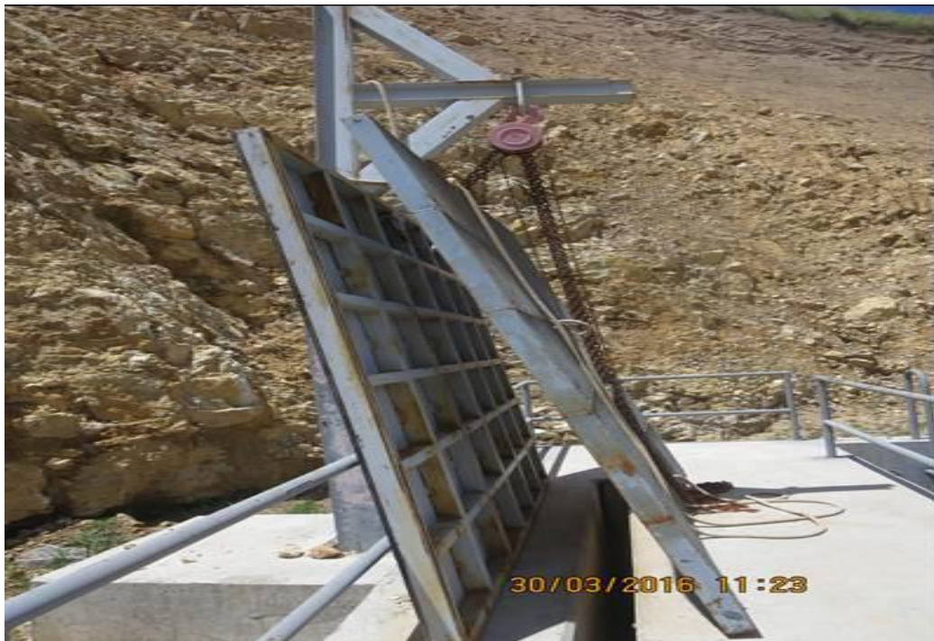
Figura N°50. Sistema de izaje para rejillas de cámara de carga.
