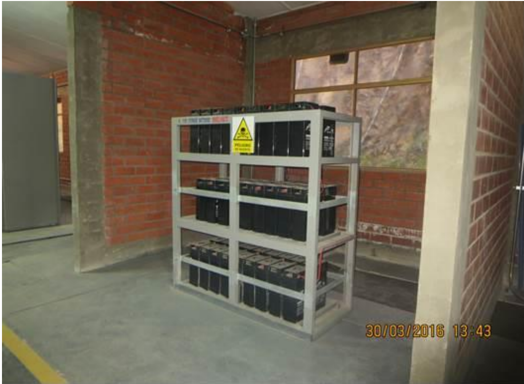
Figura N°88. Banco de Baterías.
