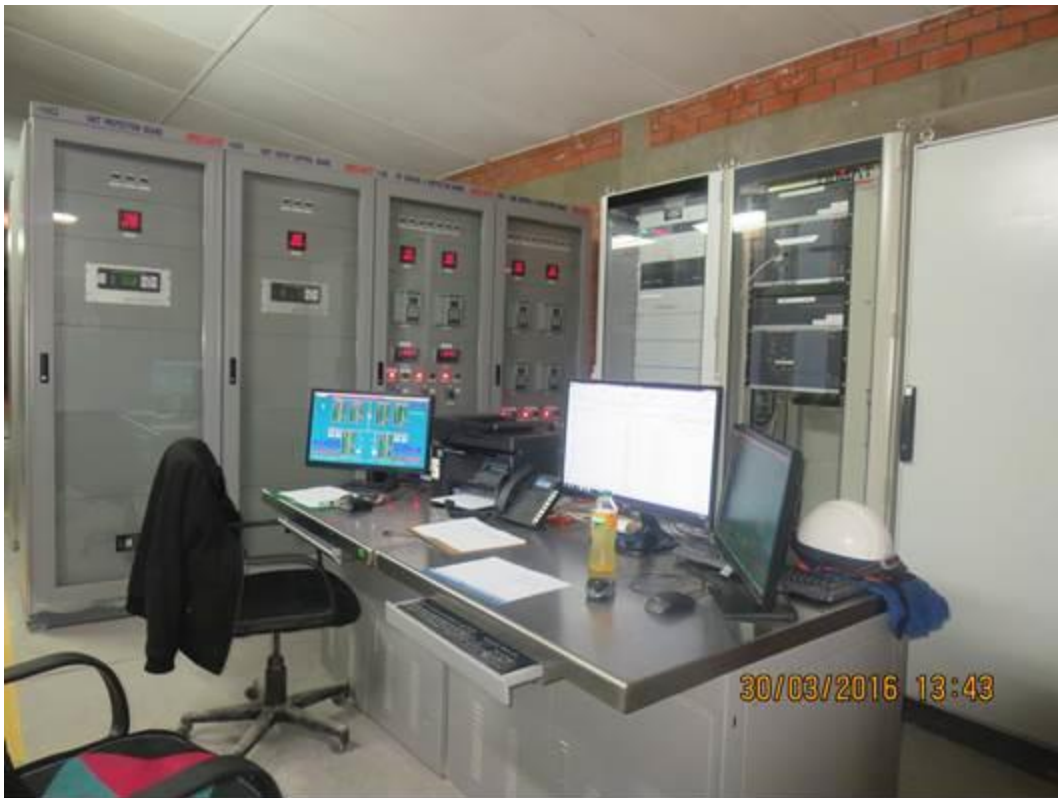
Figura N°83. Sala de operador.
