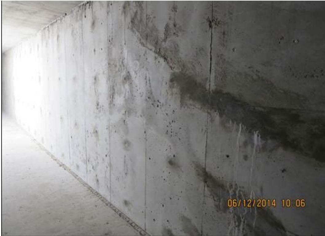
Figura N°44. Tramo N°03- Se evidencia presencia de fisuras en canal de conduccion.
