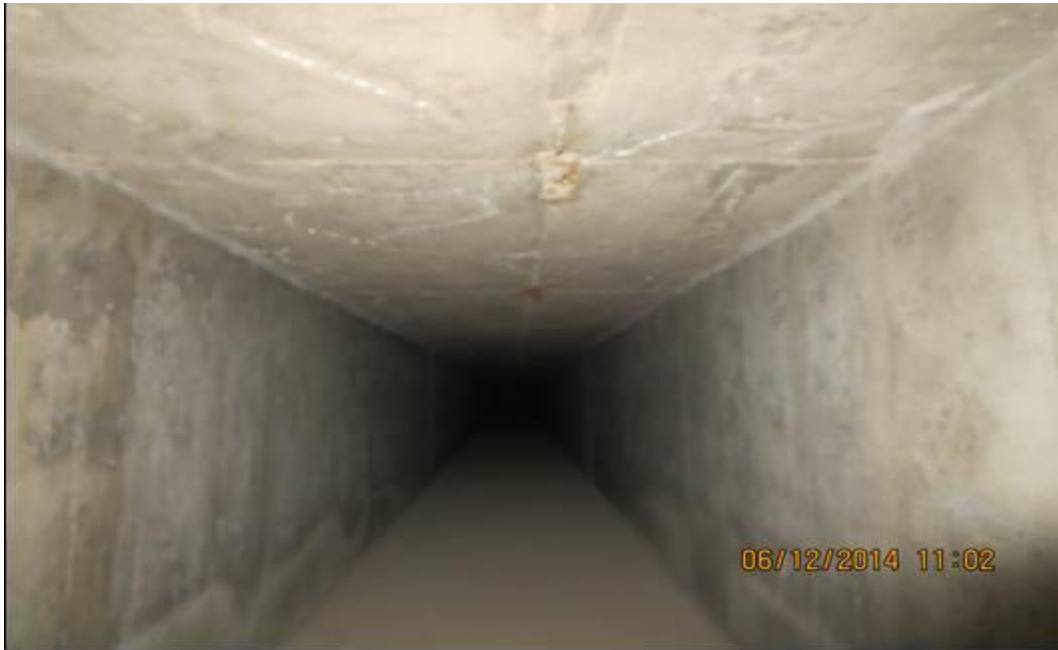
Figura N°34. Tramo N°01- Canal de Conducción – Presencia de Fisuras y Grietas-Vista Interior.
