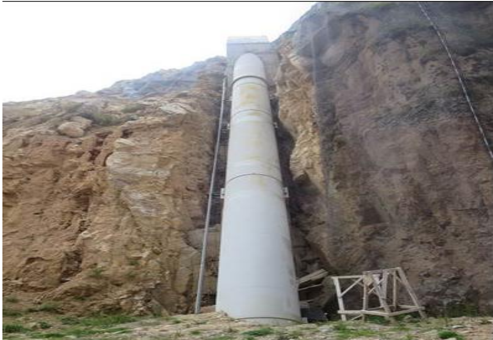
Figura N°16. Tubería de Presión.
