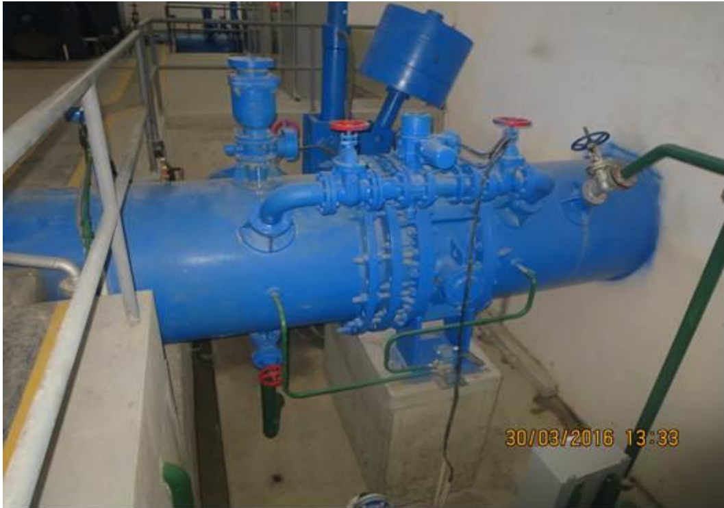
Figura N°74. Válvula principal de apertura y by pass de compensación de presiones del generador n° 01.
