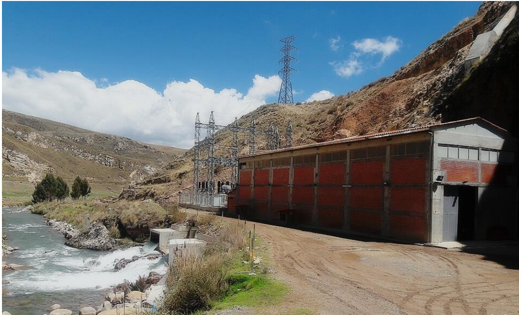
Figura N°02. Central Hidroeléctrica Canchayllo SAC - EGECSAC
