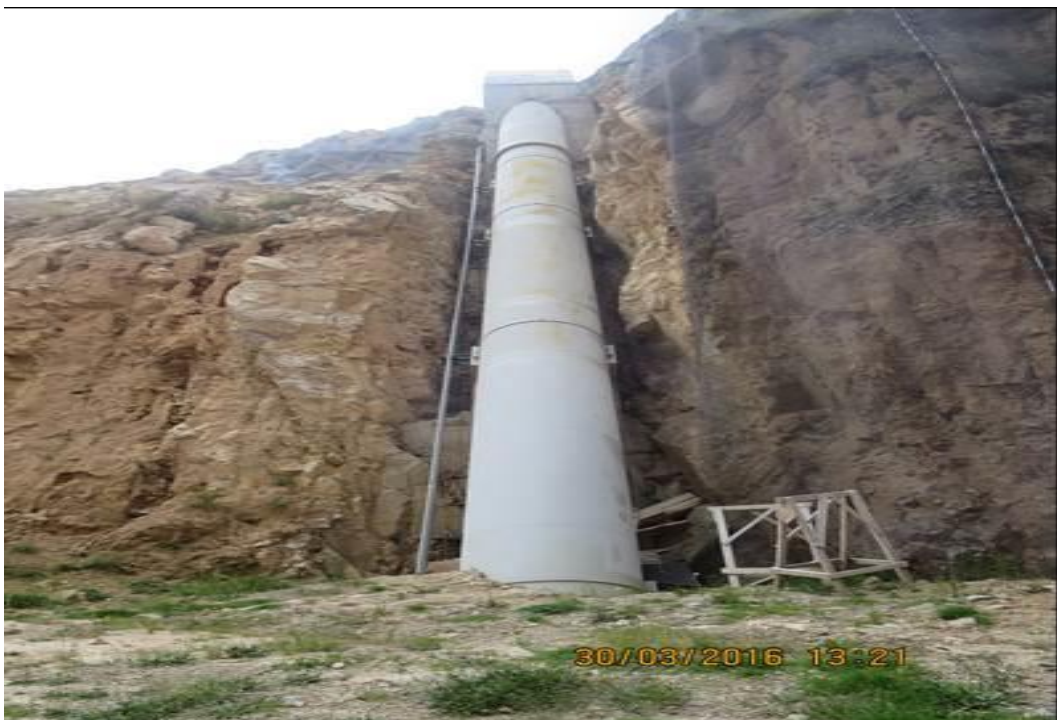
Figura N°61. Tubería de Presión Forzada y Geo Malla-Vista Frontal
