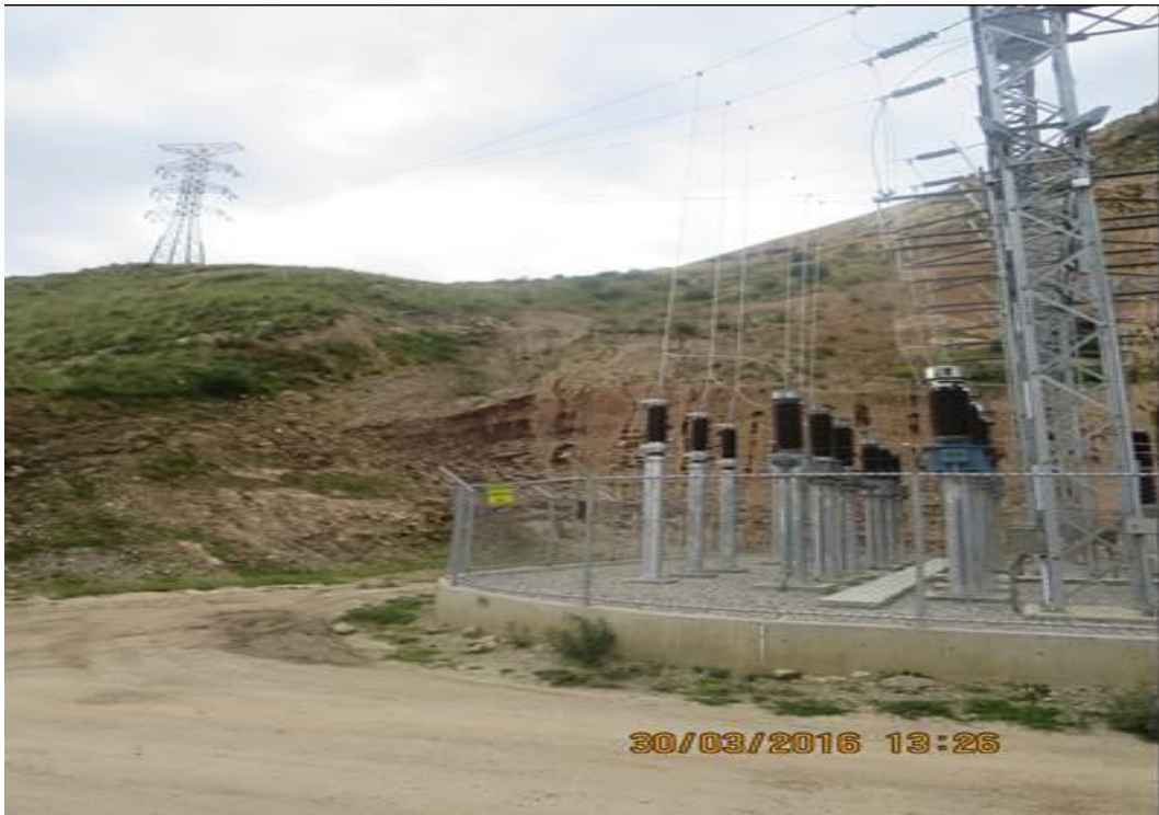
Figura N°95. Torre N°01.-Vista de Sub estación.
