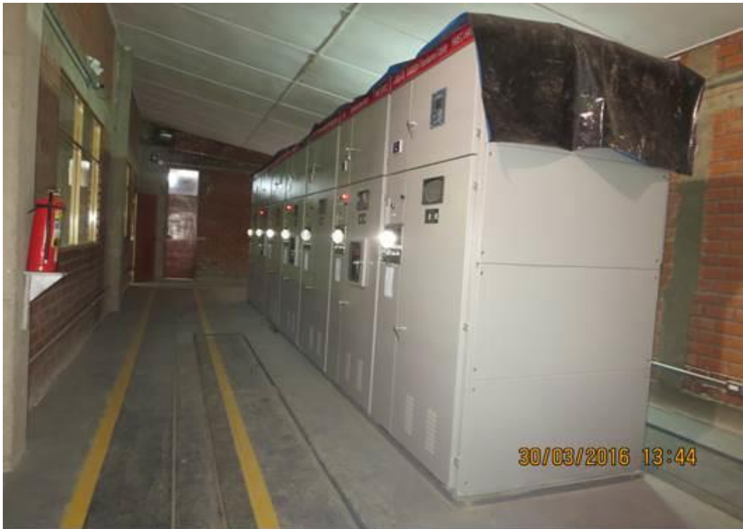
Figura N°91. Gabinetes de Media Tension en 6.3KV
