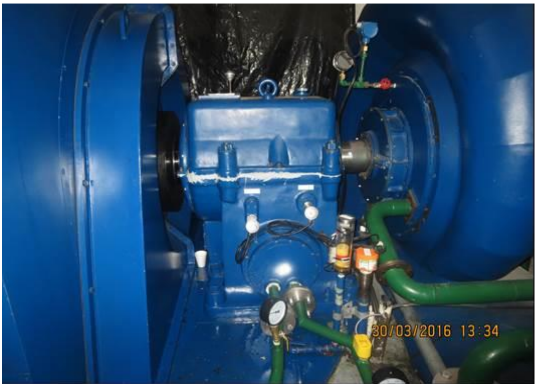
Figura N°77. Cojinete de Empuje del generador N° 01.
