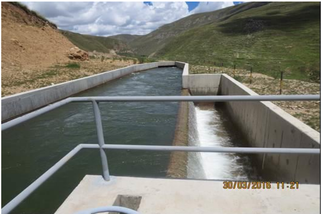
Figura N°47. Rebose de cámara de carga-Aliviadero.
