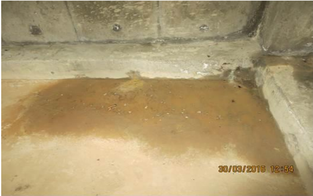
Figura N°58. Presencia de filtración de agua en caseta de válvulas
