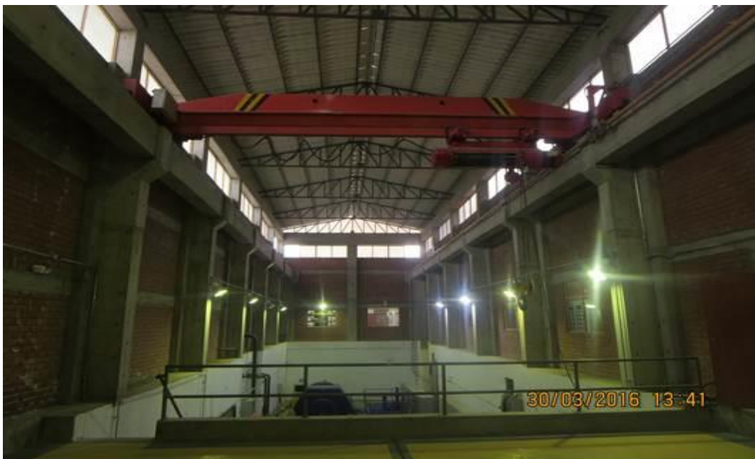
Figura N°67. Puente Grúa de 10 Tn – presenta exposición de motores por filtración de agua por el techo.
