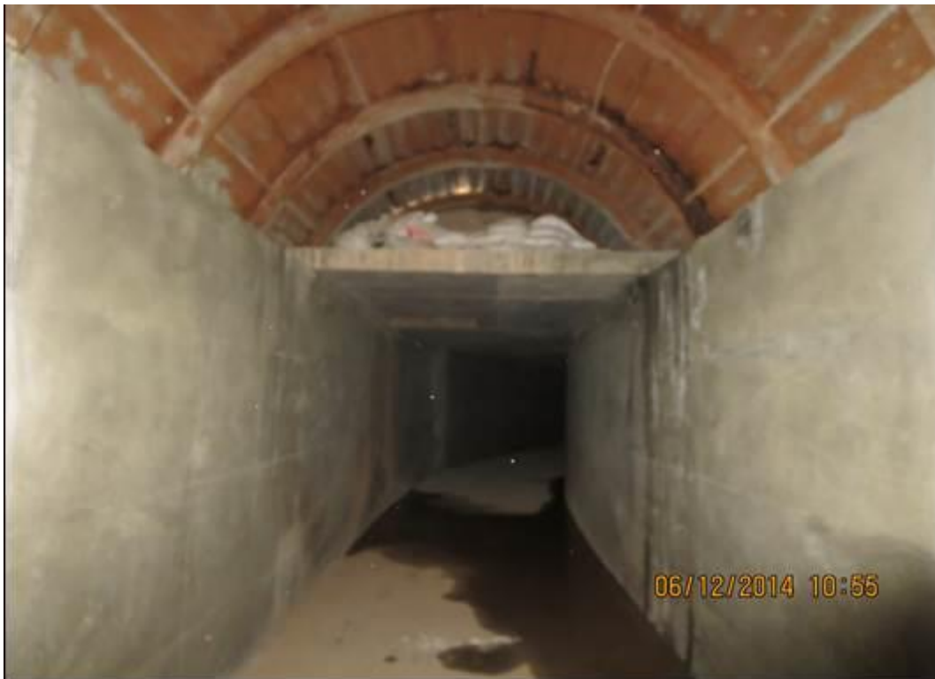
Figura N°36. Tramo N°01- Canal de Conducción –Túnel N°01. Se evidencia leves grietas.
