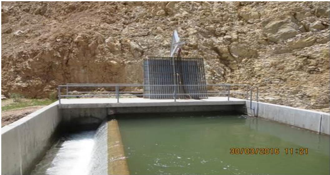
Figura N°48. Rejillas finas al ingreso de la tubería forzada.
