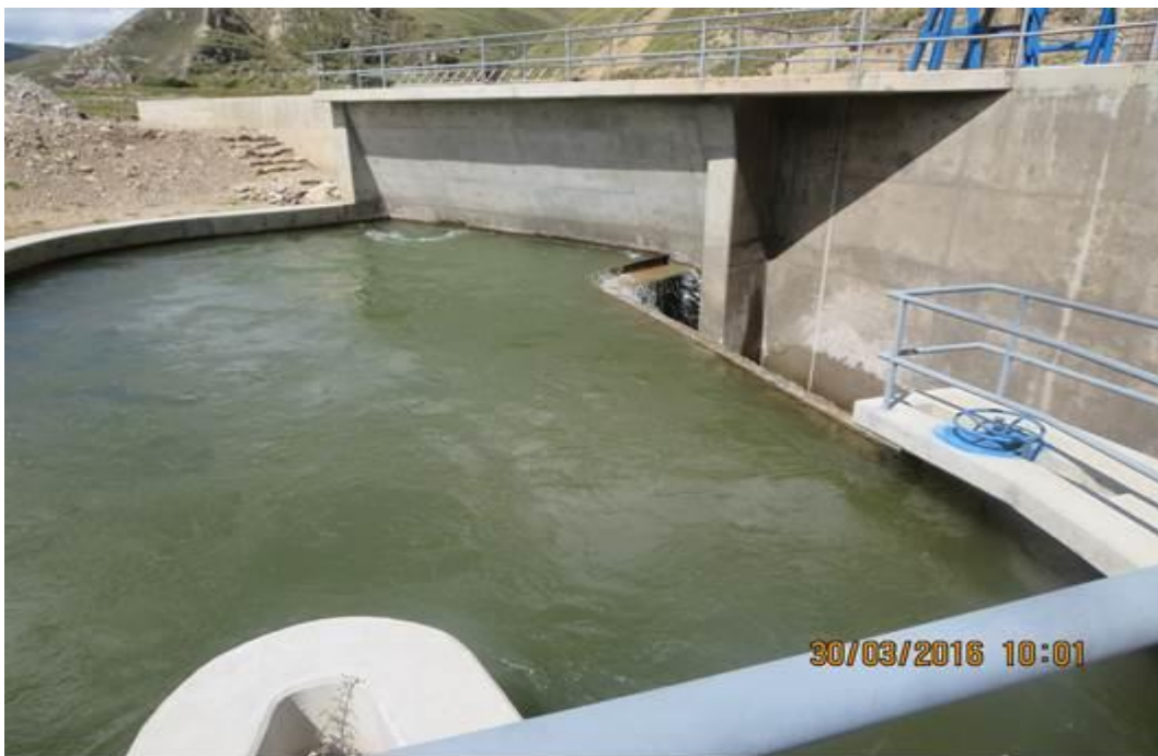
Figura N°27. Poza de desripeado-Compuerta de Purga.
