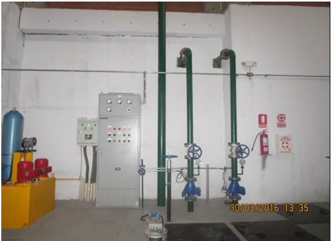
Figura N°79. Tablero de Control de las Bombas de Drenaje.
