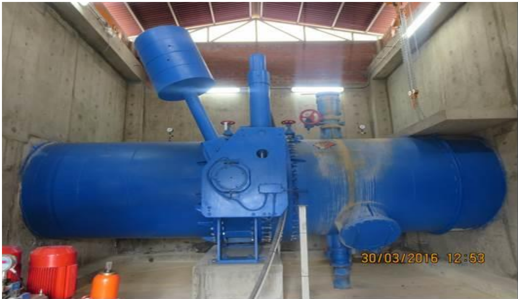
Figura N°56. Caseta de Válvulas.
