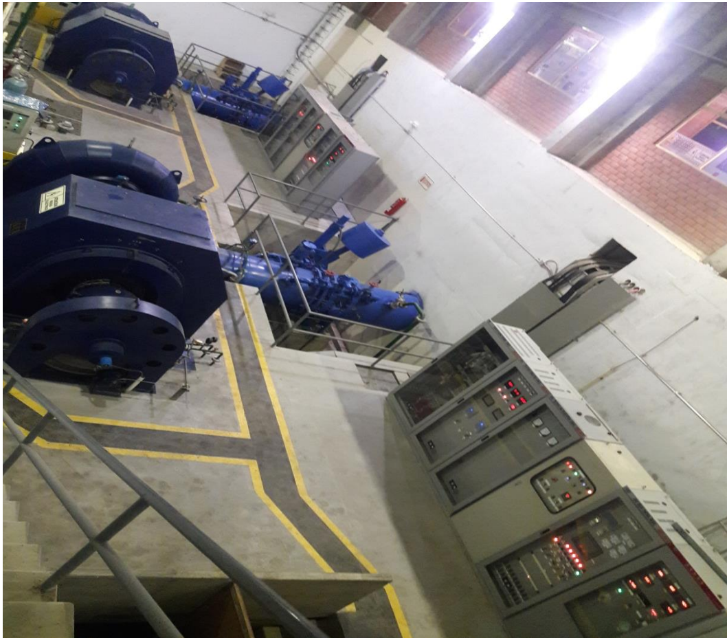
Figura N°17. Casa de Maquinas.
