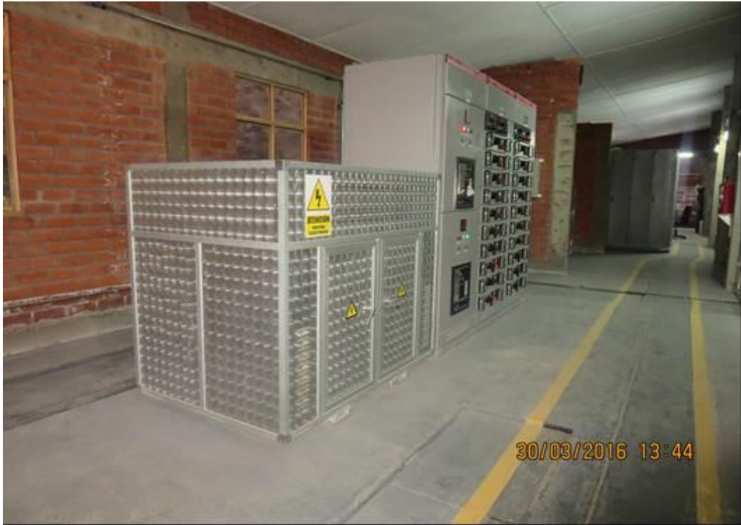
Figura N°90. Transformador de Servicios Auxiliares a 380 V y 220V AC
