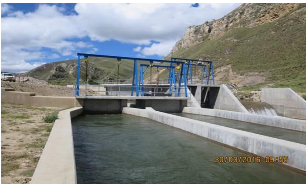
Figura N°30. Naves del Desarenador.
