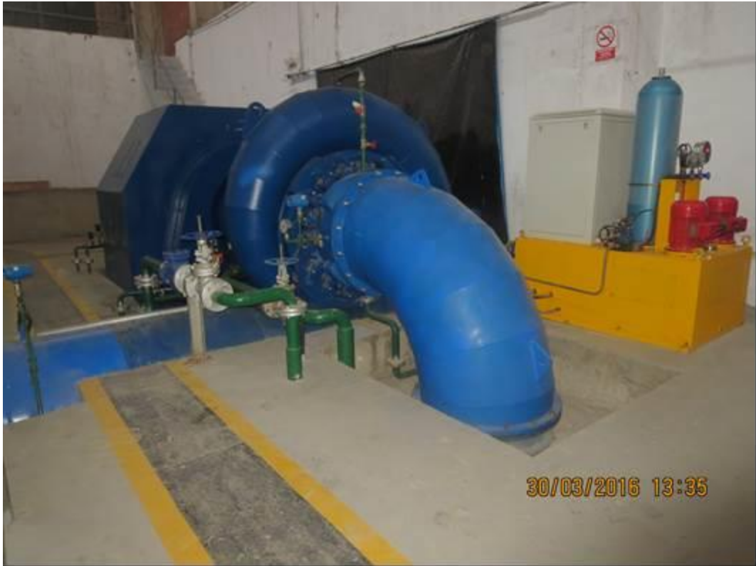
Figura N°78. Codo Difusor del Generador N° 01.
