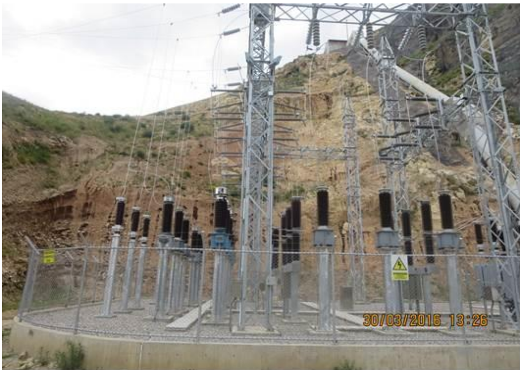
Figura N°93. Transformadores de Voltaje y Corriente.
