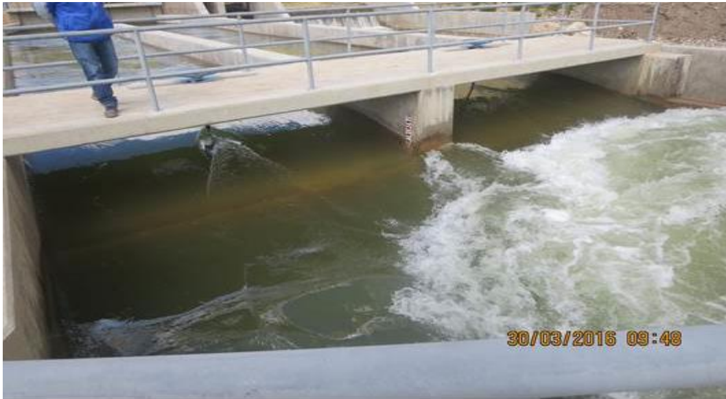
Figura N°32. Regla para regulación de ingreso de agua al canal de conducción.
