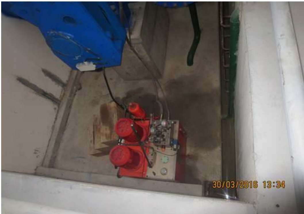
Figura N°75. Bomba de aceite de la válvula principal del Generador N°01
