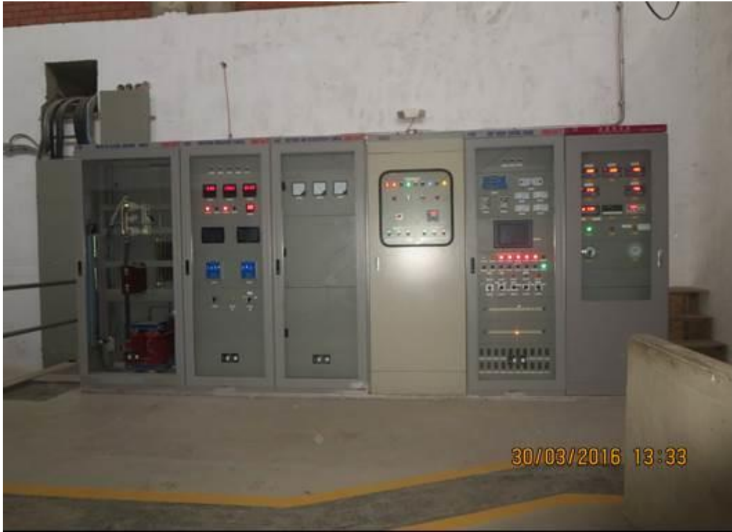
Figura N°72. Gabinetes de Control del Generador N° 01.
