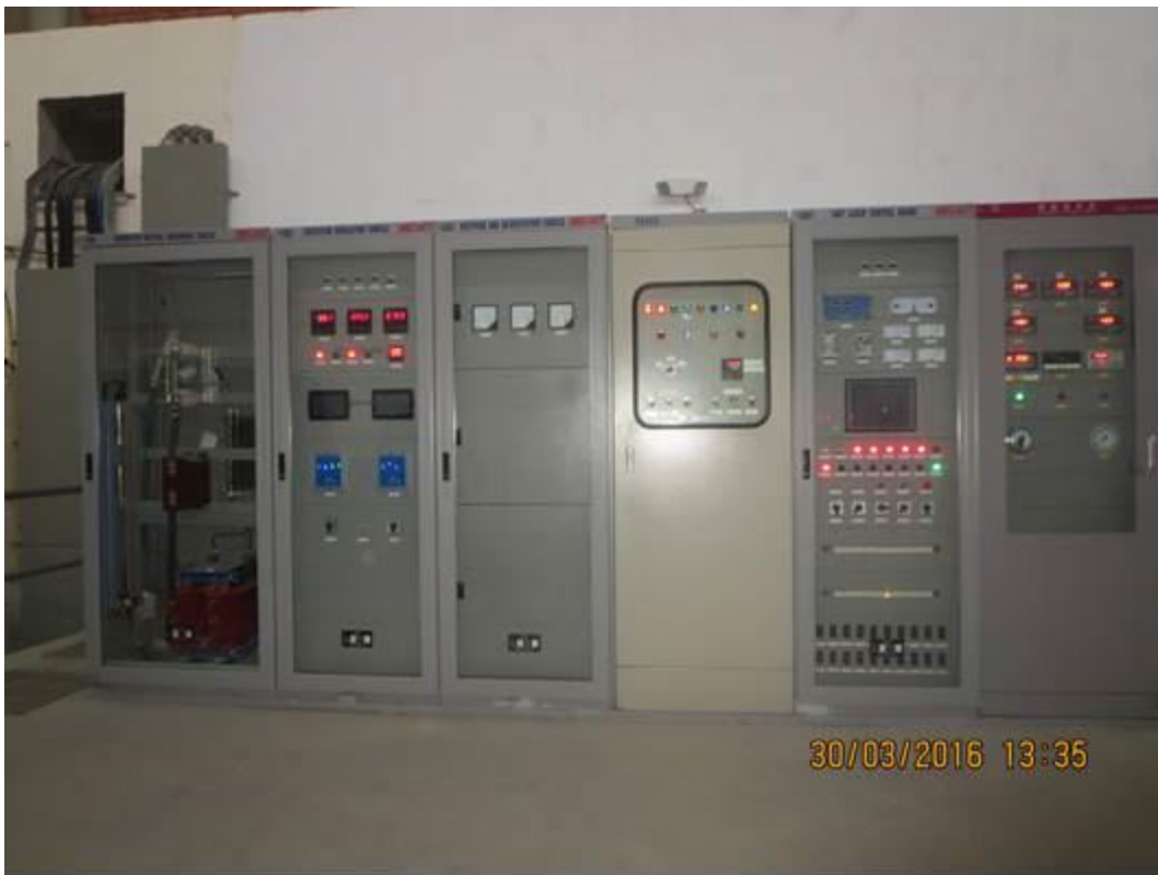
Figura N°81. Gabinetes de Control del Generador N° 02.
