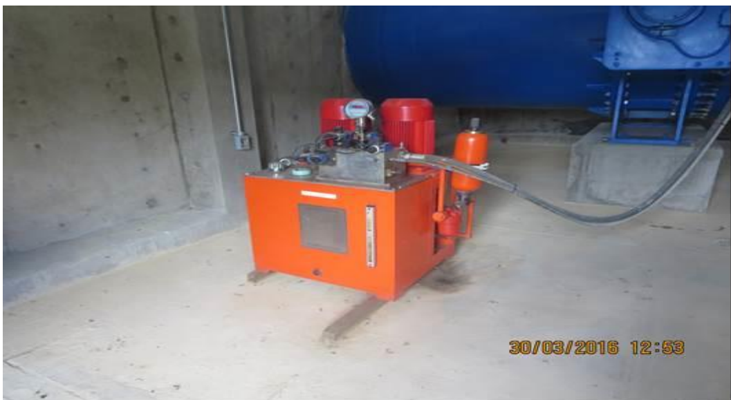
Figura N°57. Bomba de válvula principal de caseta de válvulas
