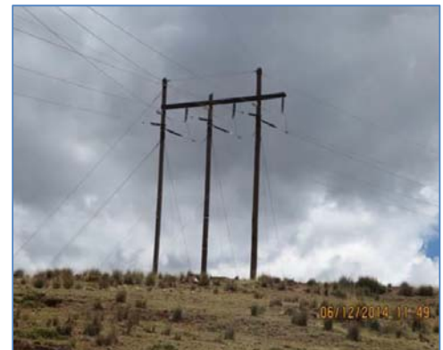
L.T. 69 kV S.E.CANCHAYLLO – L.T. OROYA-CHUMPE
