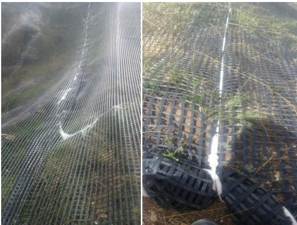
Figura N°65. Geo mallas presentan cortes
