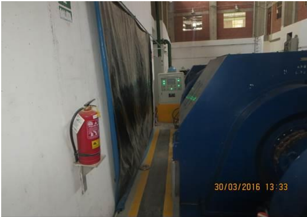
Figura N°71. Gobernador del Generador N° 01.
