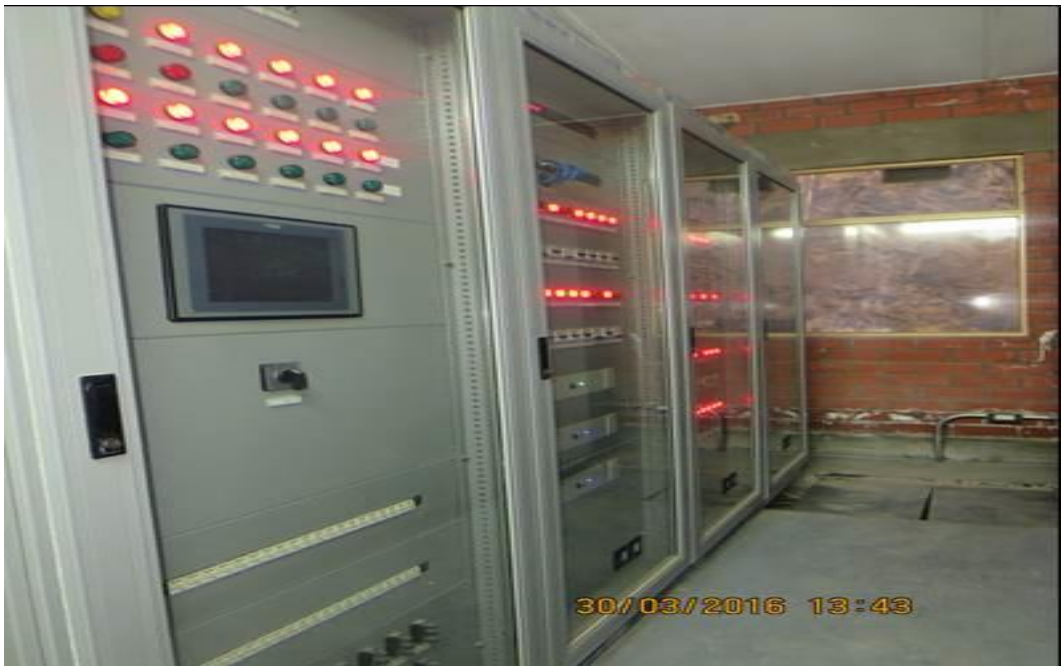
Figura N°87. Gabinetes de Control de 69kv.
