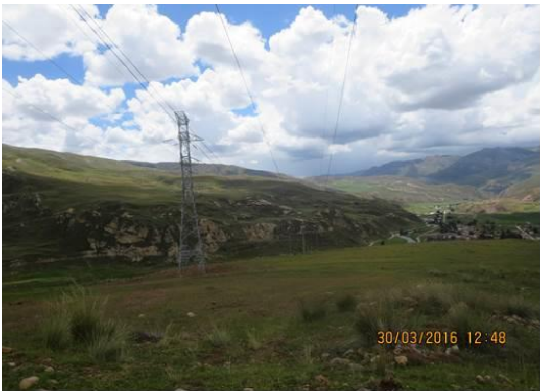
Figura N°99. Conexión a SN POWER
