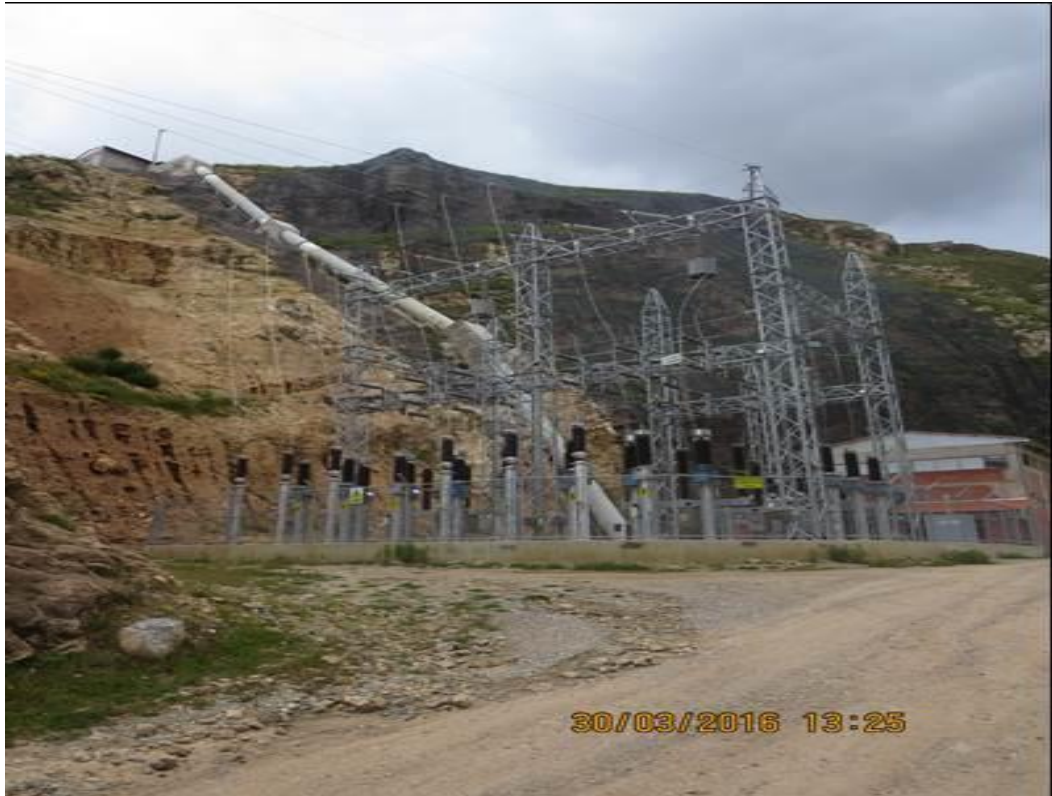
Figura N°94. Seccionadores de Linea y Barra en 69KV.
