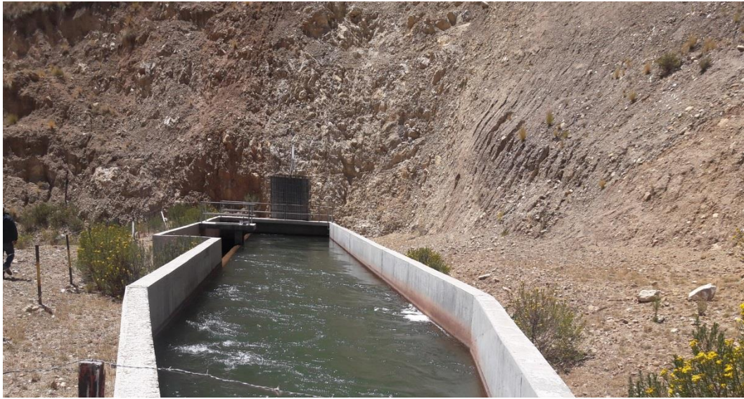
Figura N°15. Cámara de Carga.
