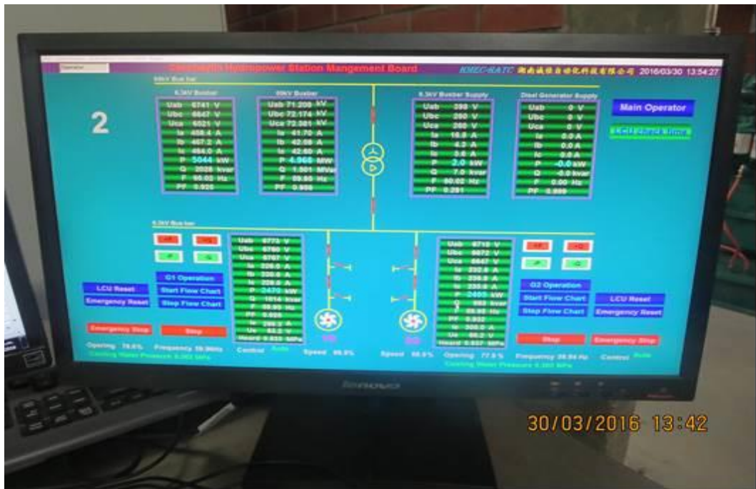
Figura N°85. Sistema SCADA en sala de Control.
