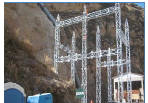
Pórtico de la S.E. Canchayllo
