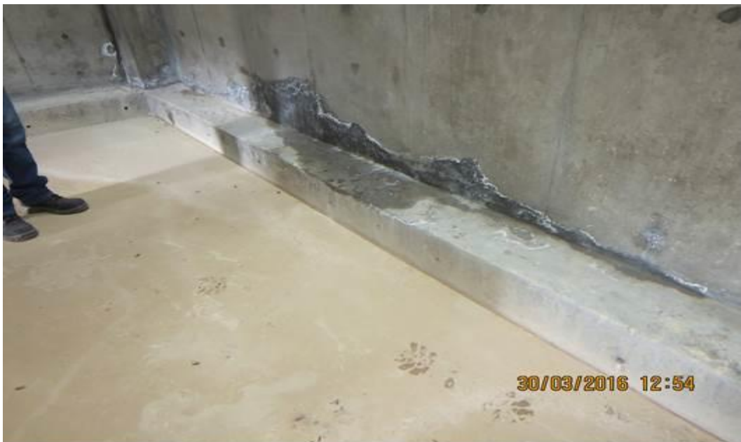
Figura N°59. Filtración de agua por la pared en caseta de válvulas
