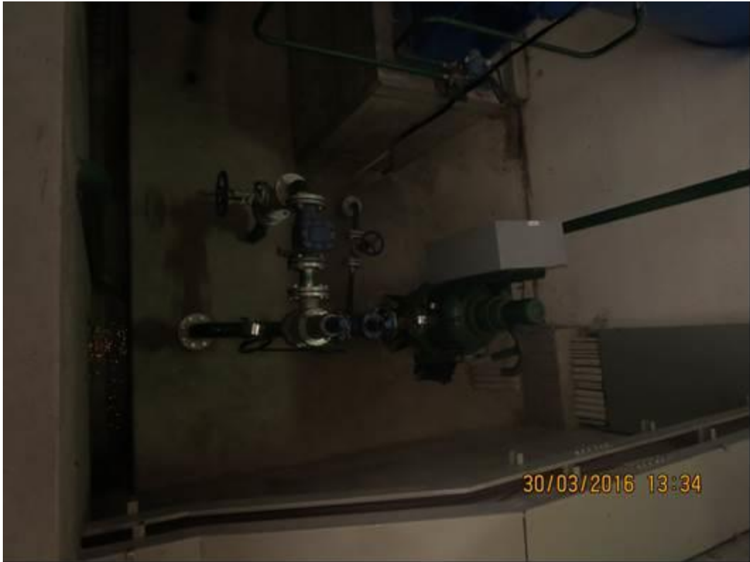
Figura N°76. Sistema de refrigeración del generador N° 01
