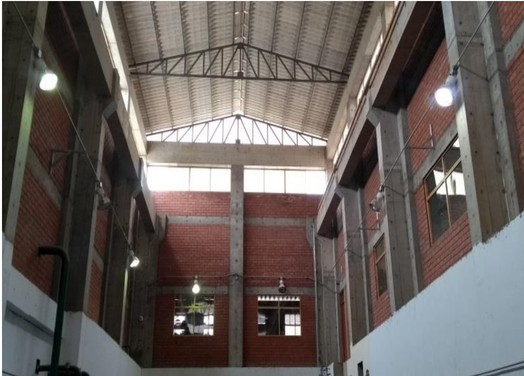
Figura N°64. Bombillas defectuosas en sala de maquinas
