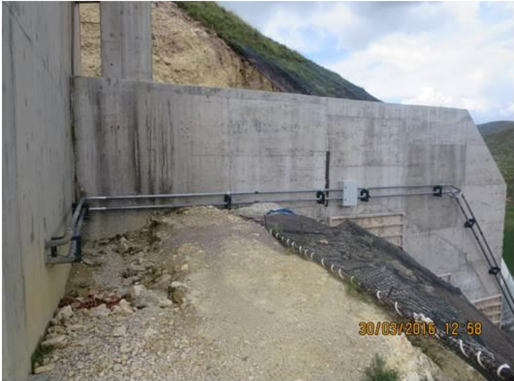
Figura N°60. Tubería de Presión Forzada y Geo Malla-Vista superior
