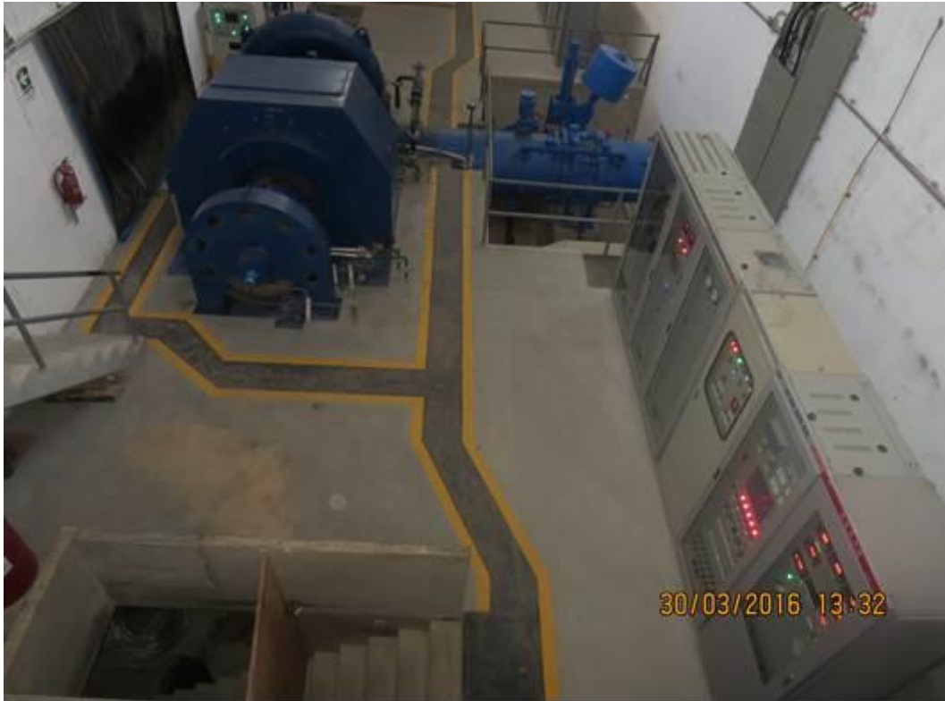
Figura N°70. Gabinetes del Generador N° 01.
