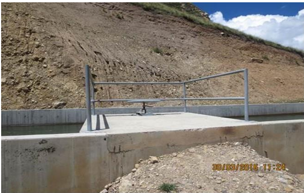
Figura N°51. Compuerta de Purga de cámara de carga.
